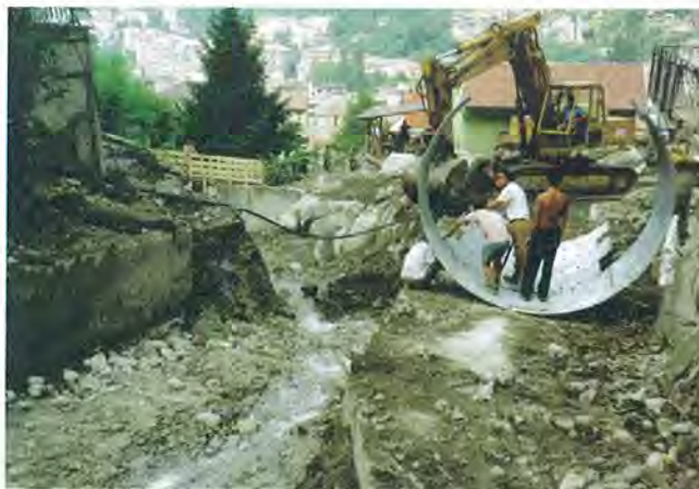
Fig. 12. Omegna, Rio S. Rocco. Lavori di pronto intervento per il ripristino dell'attraversamento distrutto (Via Nobili). Sullo sfondo, passerella provvisoria in legno realizzata dalla Protezione Civile.
