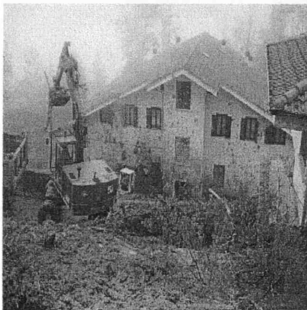
Figura 44: Paesana: una colata di discrete dimensioni (dell'ordine di 100 m 3 ), originatasi pochi minuti dopo le ore 18.00 del giorno 4 lungo la S.P. 269 per la frazione Agliasco, ha interessato due edifici posti a valle; la causa del dissesto è da ricercarsi nel mal funzionamento della regimazione delle acque meteoriche lungo la sede stradale.
