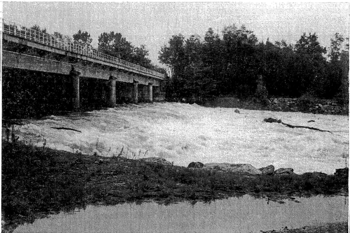
Fig.8 - Foto scattata dopo la piena del 5/10/1992: la presenza della soglia a valle del ponte già allora aveva favorito l'innalzamento delle acque con conseguenti fenomeni di allagamento a monte e di innesco di fenomeni erosivi di fondo e lungo le sponde a valle.
