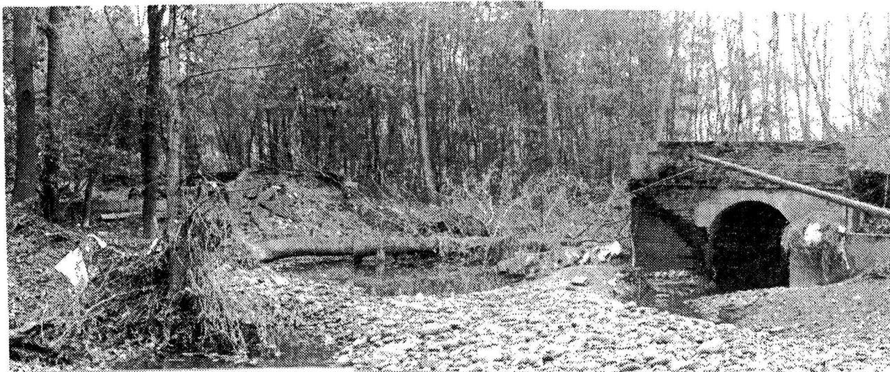
Fig. 14 - Particolare del rilevato della provinciale San Benigno-Fogizzo, sfondato in prossimità di un sottopasso idraulico.
