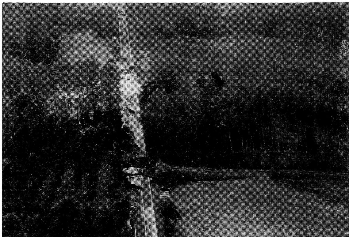
Fig. 12 - Strada provinciale San Benigno-Fogizzo: parte prossima al ponte, in sponda destra. Si osservino lunghi tratti asportati del rilevato.
