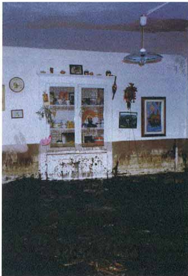
Fig. 7. Omegna, Rio S. Rocco. Interno di uno degli edifici posti in apice di conoide. Visibile sul muro il livello raggiunto dall'acqua.
