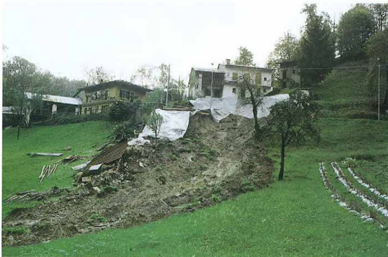
Fig. 15. Comune di Chiusa di Pesio, località Tetti Fiolera. Frana rotazionale evoluta in colata in terreni di riporto e di copertura. Il dissesto ha determinato l'asportazione di una strada privata e il crollo di un fabbricato non abitativo.
