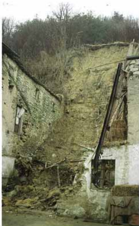
Fig. 89. Comune di Feisoglio, località Sprella. L'immagine mostra la porzione di edificio distrutta da una frana della copertura detritica superficiale la sera del sabato 5 novembre 1994. Nell'occasione hanno trovato al morte due persone che al momento si trovavano nell'edificio agricolo.
