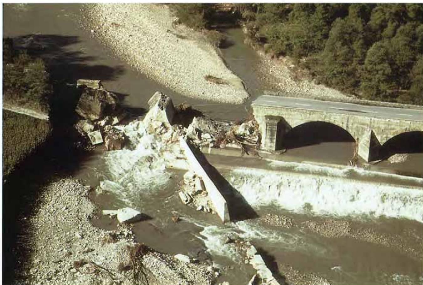
Fig. 13. Distruzione di due arcate del ponte della S.S. n. 28 sul t. Pesio. La prima arcata (destra idrografica) risultava già occlusa da una preesistente strada di servizio alla vicina area di cava, come testimoniato dalla centrale posizione del muro d'argine.
