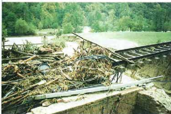
Fig. 8. Comune di Robilante. Particolare della immagine precedente con il rilevato ferroviario asportato per sifonamento.
