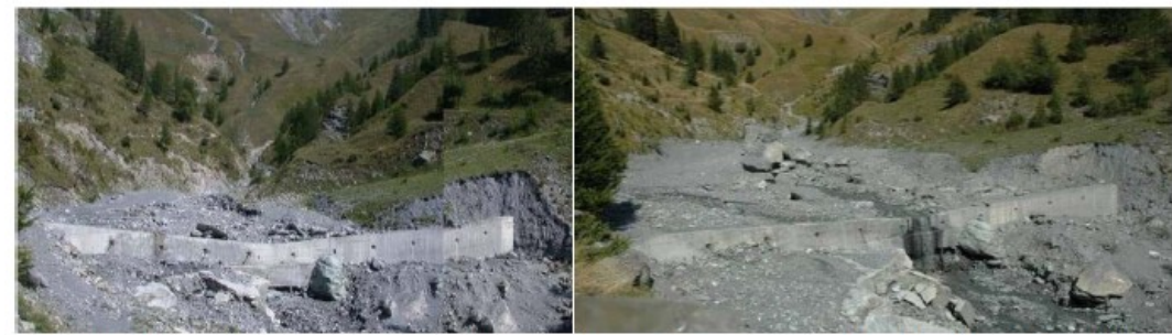
Fig. 24: Briglia in calcestruzzo raggirata in sinistra in Loc. Camini Frejus e sottoscavata (foto settembre 2004).
