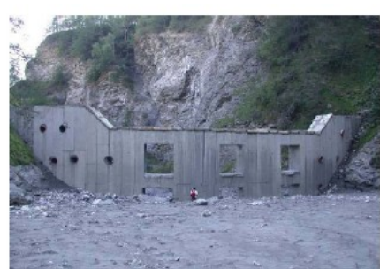
Fig. 15: Vista della stessa briglia dopo il precedente evento dell'agosto 2004.
