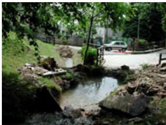
Strada Boer, l'ostruzione dell'attraversamento, visibile al centro dell'immagine, ha convogliato l'acqua dell'impluvio lungo la strada comunale (in destra dell'immagine) fino alla zona Nazzarotti, 500m a valle
