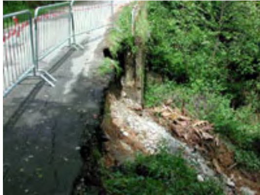
Strada Colletto. La fluidificazione della copertura, verosimilmente connessa all'attività del vicino rio del Colletto, ha determinato un cedimento di sottoscarpa lungo il ciglio della carreggiata
