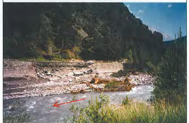
Difesa spondale sottoscalzata per erosione e tratto di strada asportato dal Ripa. La difesa, crollata in alveo, non è stata asportata. La freccia indica il senso di deflusso del Ripa.
