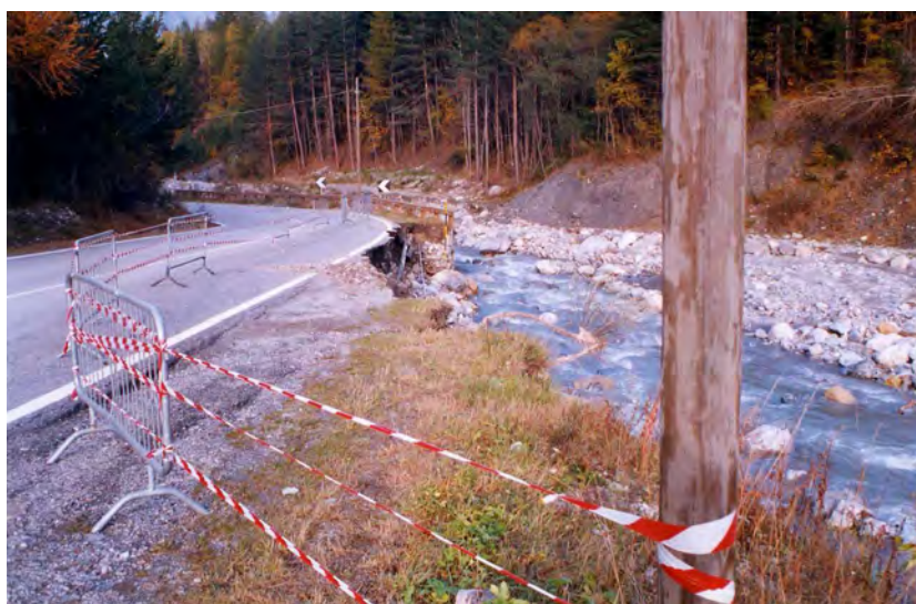
FOTO 76 - Dora di Melezet (Bardonecchia): erosione di sponda con danneggiamento strada provinciale.
