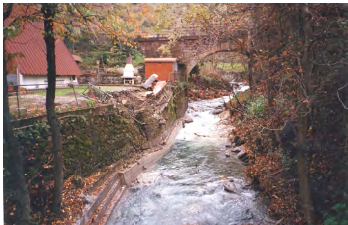
FOTO 1000 -Rio Scaglione - Località Rodetti: cedimento per erosione al piede tratto muro di sponda in destra.
