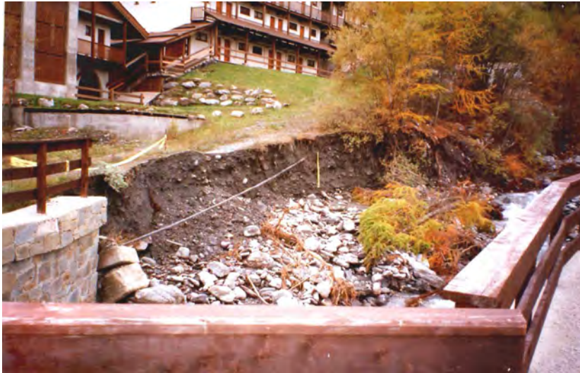
FOTO 113 - Pragelato - erosione in sponda dx T. Chisonetto
