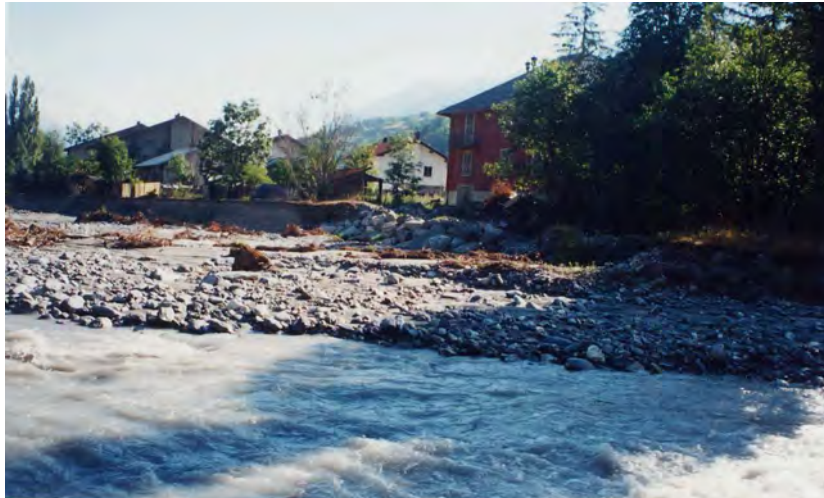
FOTO 35a- Dora Riparia ad Oulx: scogliera realizzata durante la piena di giugno per tamponare l'erosione in sponda destra nel punto d'intestazione del muro di difesa (a valle continuo entro l'abitato).
