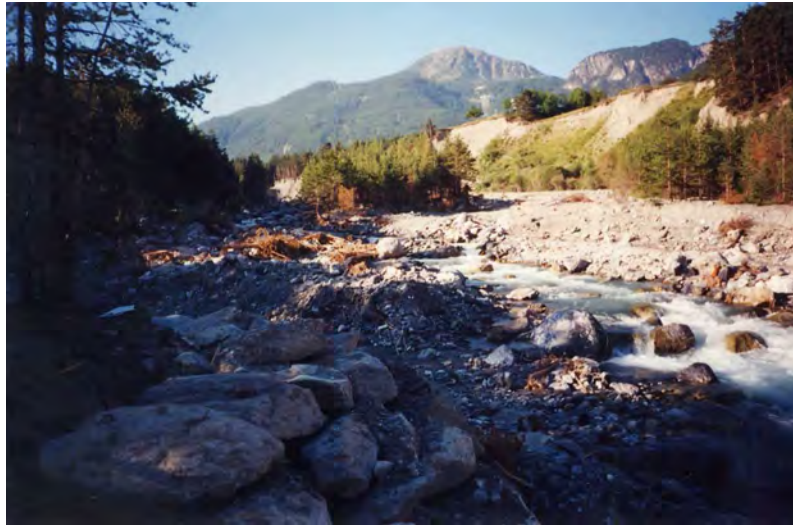
FOTO 27a- Dora Riparia presso Mollieres: tratto d'asta a geometria ristretta soggetta a forte erosione spondale. In sponda destra durante la piena del giugno è stata realizzata una scogliera per evitare l'apertura di un canale ed il conseguente alluvionamento di una falegnameria.
