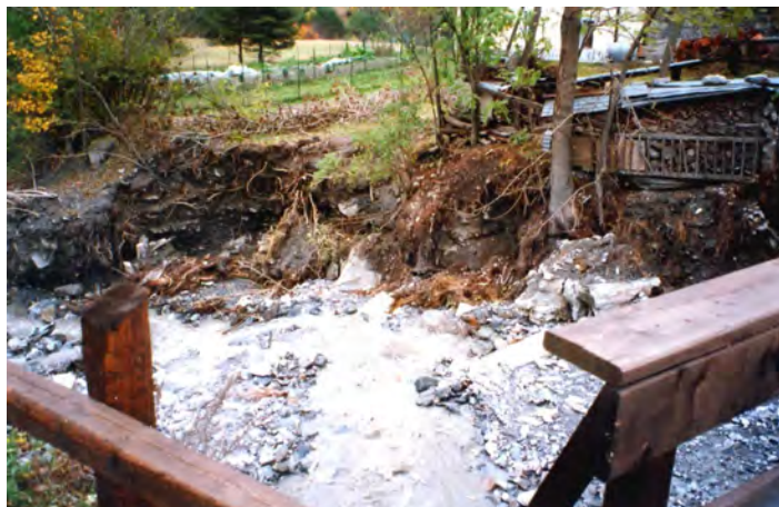
FOTO 92 - Rio Fenils - Tratto in erosione spondale a valle p.te per frazione Vernin.
