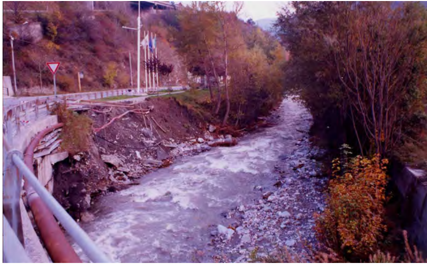
FOTO 81 - T.Rochemolles a Bardonecchia: erosione spondale in sinistra.
