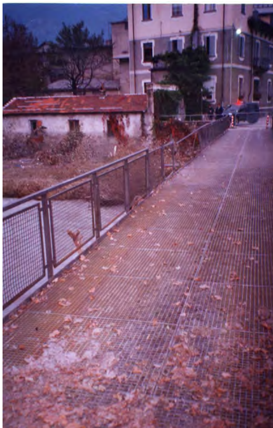
FOTO 6 - Bussoleno - Ponte in ferro (tracimato) sulla Dora Riparia
