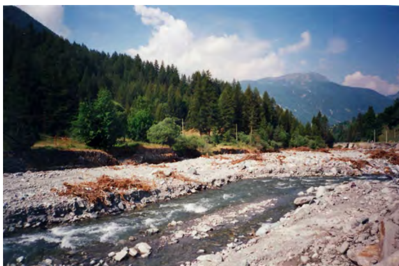
FOTO 4a- Ripa a Rollieres: gabbionata in sponda sinistra a protezione area colonia estiva; tratto brecciato per erosione al piede dell'opera.
