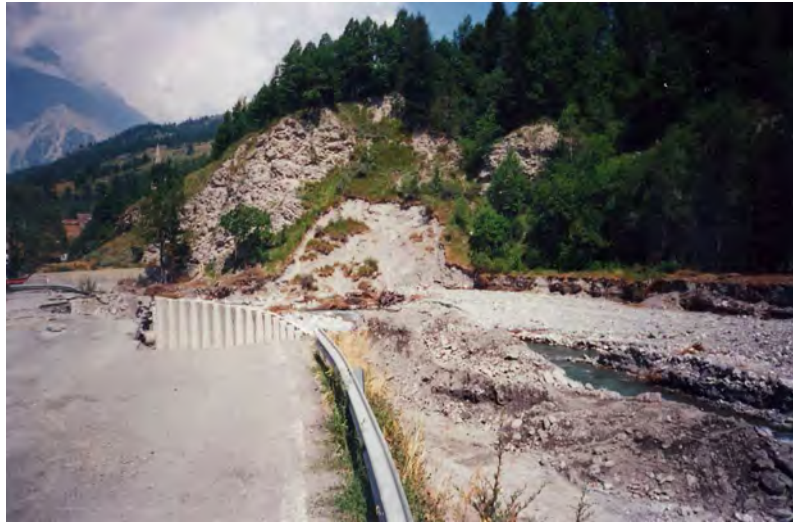
FOTO 11a- Ripa a Bousson: tratto a erosione spondale accentuata. In sponda destra frana di sponda; in sinistra scalzo al piede e distruzione tratto di muro a protezione strade provinciale (lavori di ripristino in corso).
