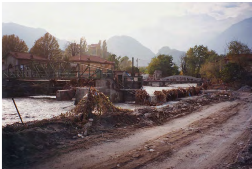
FOTO 33 - Susa - Traversa a valle del ponte degli Alpini e zona di esondazione in sponda dx
