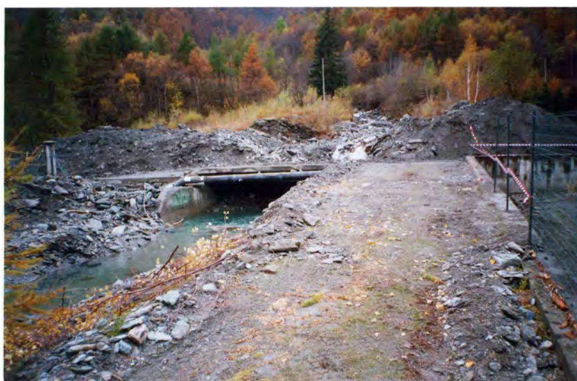
FOTO 20 - Rio delle Verghe (Fenestrelle) - Apice conoide: ponticello strada comunale occluso in occasione dell'evento.
