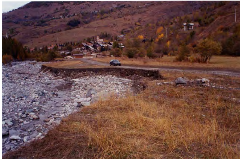
FOTO 35 - T.Ripa nei pressi di Ponte delle Albere (Sauze di Cesana). Erosione spondale in destra a monte dell'attraversamento.
