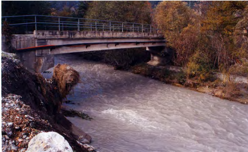
FOTO 59 - Dora di Bardonecchia - ponte per Savoulx (strada bianca): frana in sponda destra a Beulard.
