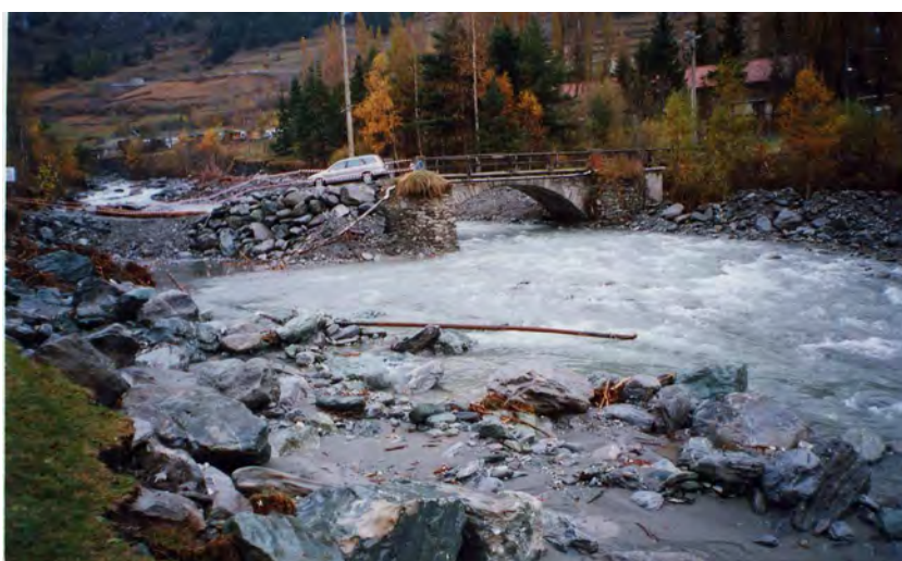
FOTO 12 - T.Chisone a Fenestrelle: ponte aggirato in sponda destra.
