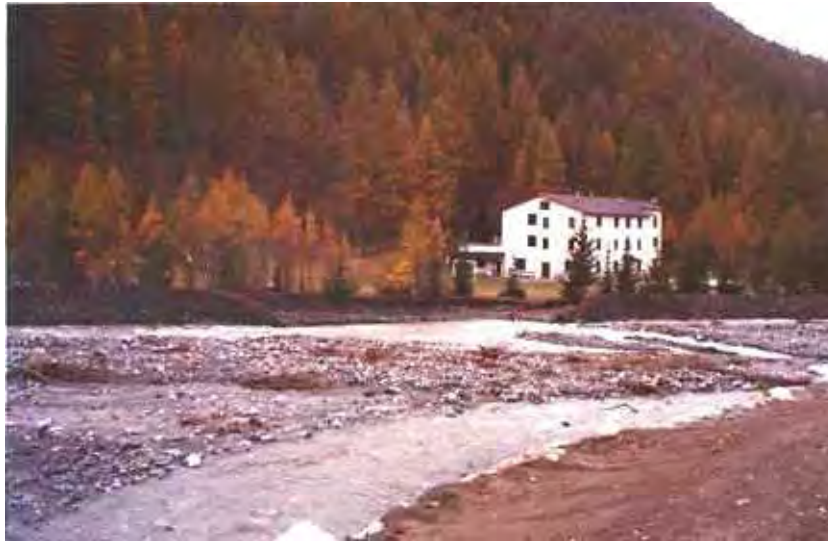
FOTO 33 - T.Ripa presso Rollieres (Sauze di Cesana): tratto di gabbionata in sinistra idrografica distrutto (breccia aperta in occasione della piena del giugno 2000).
