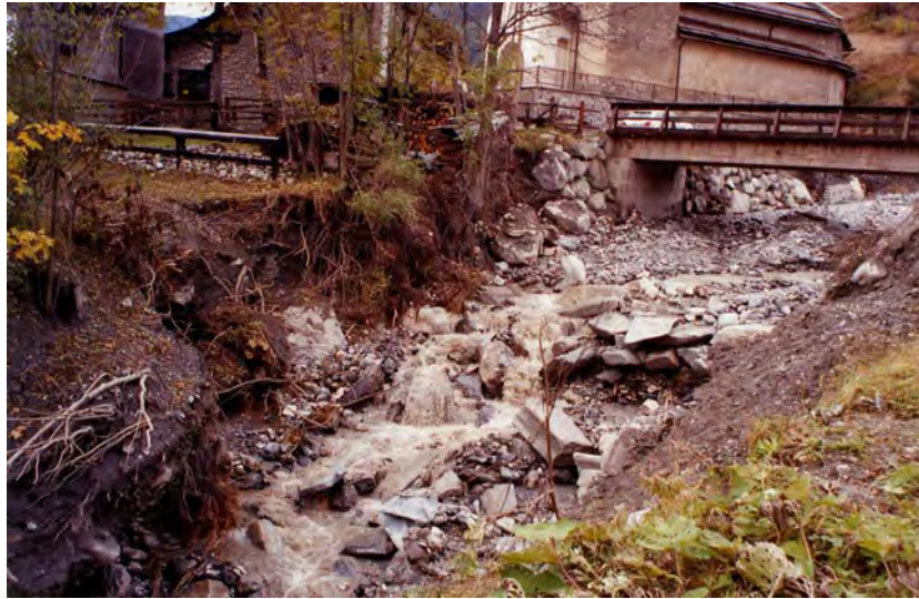
FOTO 49 - Rio Fenils (Cesana), Borgata Vernin: erosione spondale ed incisione canale.
