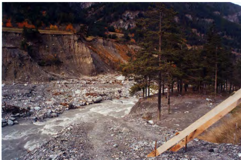
FOTO 44 - Dora Riparia a Cesana in corrispondenza della confluenza del rio Gran Vallon: erosione in sponda destra.
