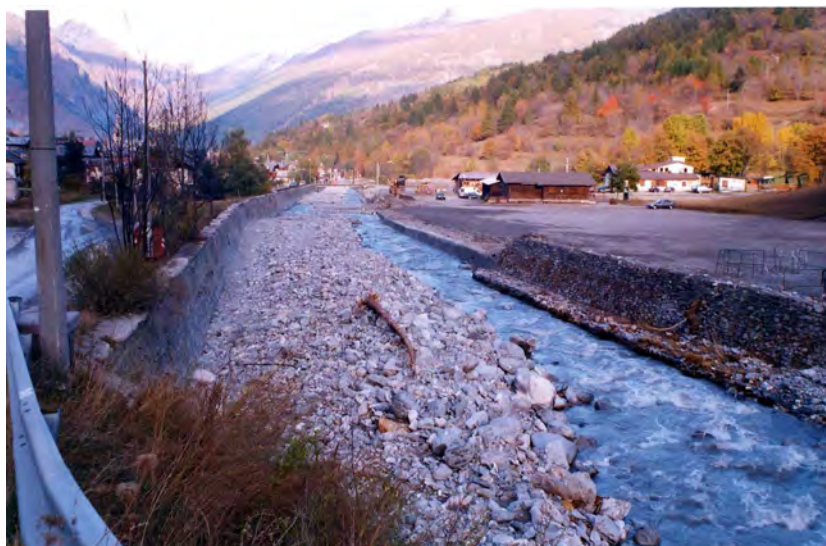
FOTO 75 - Dora di Melezet (Bardonecchia): alluvionamento asta fluviale ed allagamento piazzale impianti sciistici in destra.
