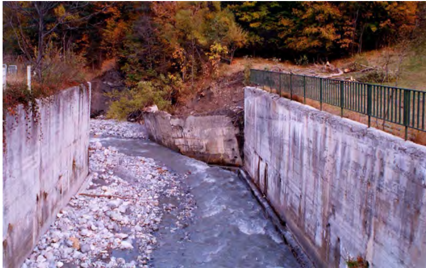
FOTO 79 - Dora di Melezet a Les Arnauds: distruzione di un tratto di muro di sponda per scalzamento delle fondazioni.
