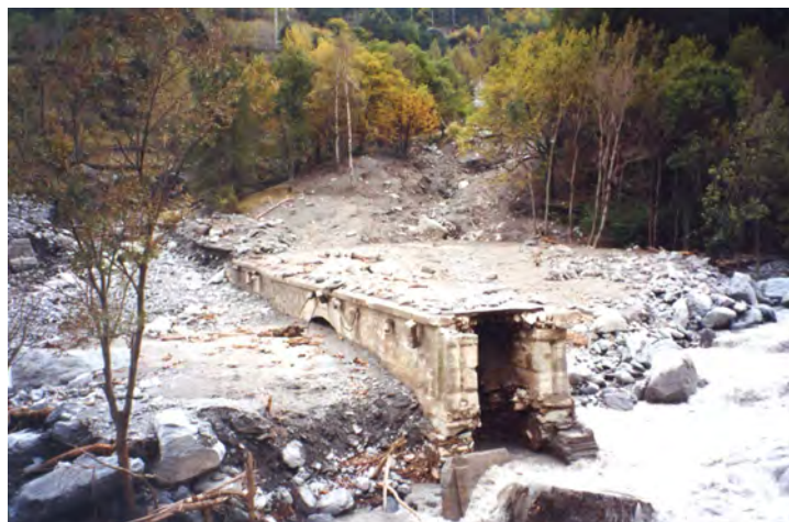
FOTO 52 - Exilles - Ponte sulla Dora crollato in corrispondenza della conf. Rivo Comba Bosco
