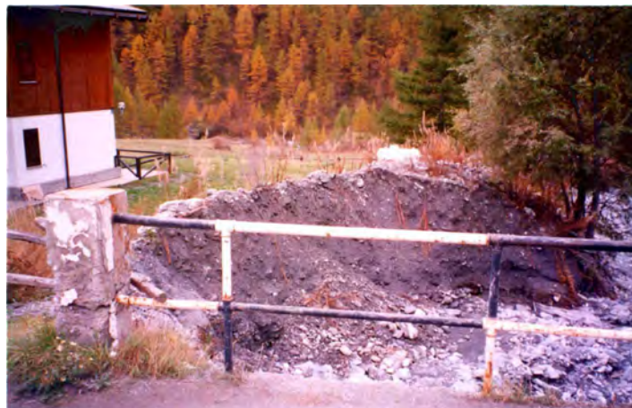
FOTO 103 - Sauze di Cesana - Erosione sponda sx Rio Baucet a valle ponte SP per Sestriere
