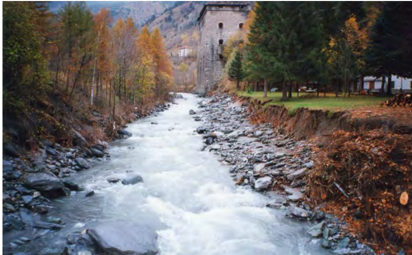
FOTO 17 - T.Chisone a Fenestrelle; ponte presso centrale SKF: erosione spondale tratto a monte dell'attraversamento.
