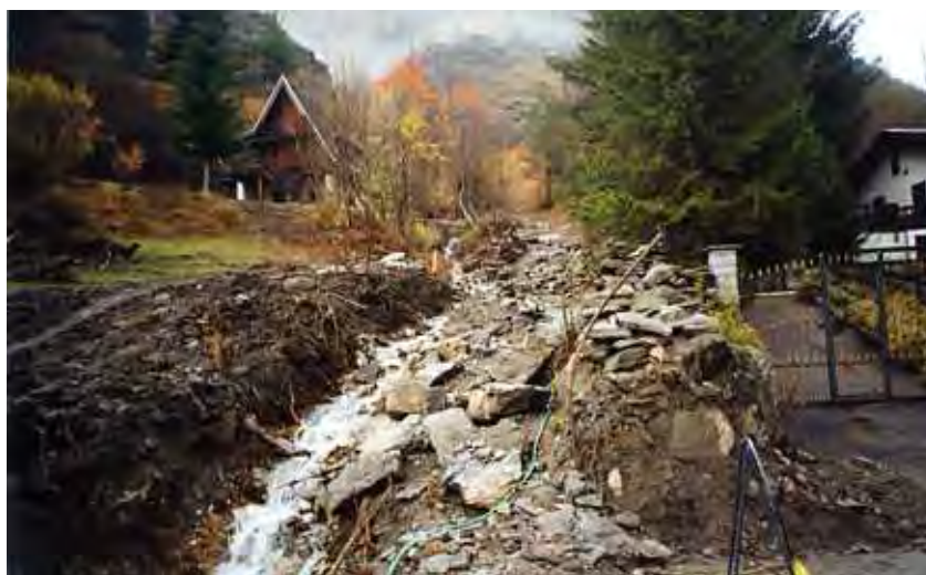
FOTO 3 - Località Fraisse (Usseaux): trasporto in massa affluente in sinistra idrografica al margine dell'abitato.
