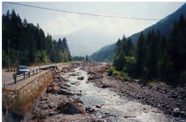
FOTO 6a- Ripa a Rollieres presso ponte di accesso a colonia estiva: vista asta fluviale a monte dell'attraversamento. In sponda destra tratti di muro di difesa strada provinciale distrutti causa scalzo al piede.
