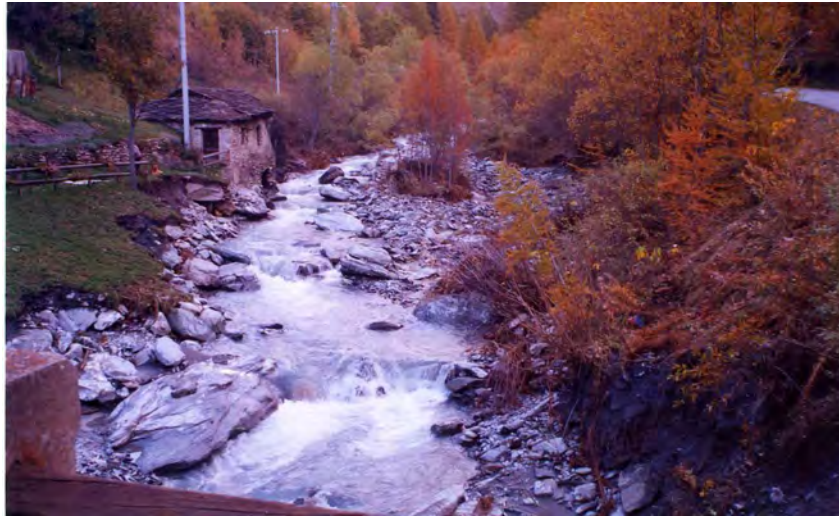
FOTO 77 - T.Rochemolles a Rochemolles: erosione spondale nei pressi del ponte di accesso all'abitato.
