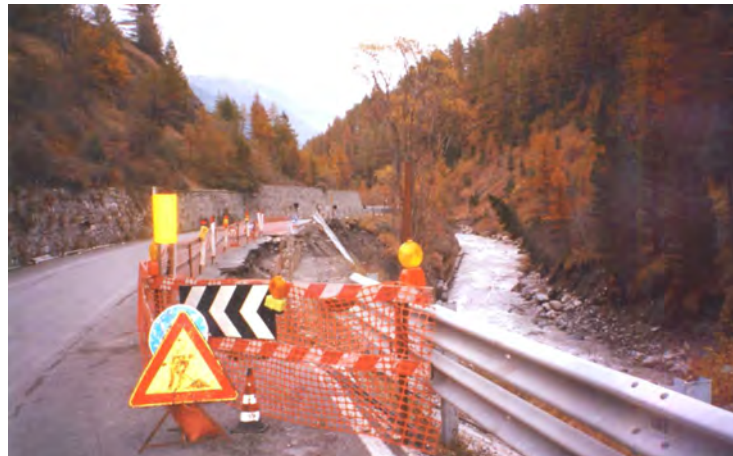
FOTO 130 - Pragelato - Erosione rilevato SS 23 in sponda sx T. Chisone
