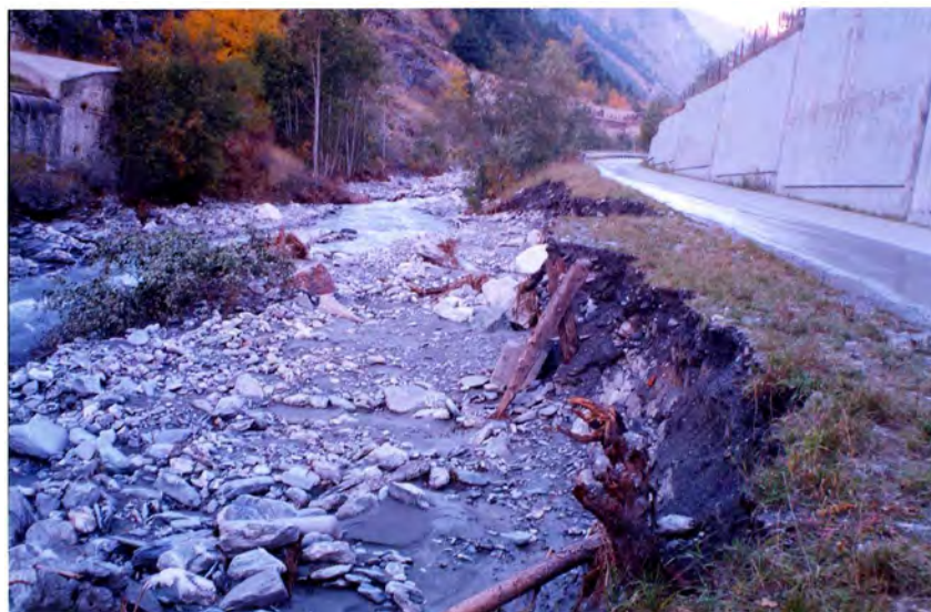
FOTO 78 - T.Rochemolles a Bardonecchia: erosione di sponda in sinistra.
