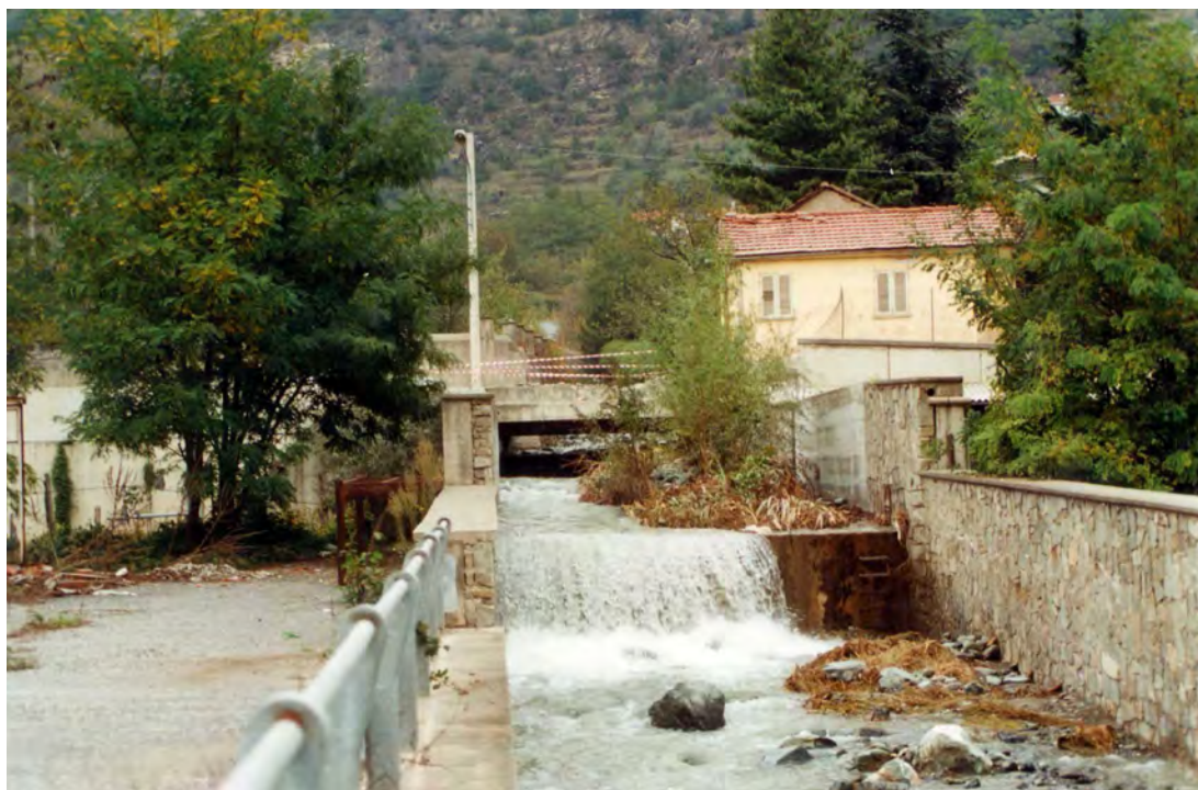
FOTO 16 - Il ponte sul T.Gendola a Susa, danneggiato per effetto dell'ingente trasporto solido, nel tratto tra la ferrovia Susa-Bussoleno a la S.S. 25.
