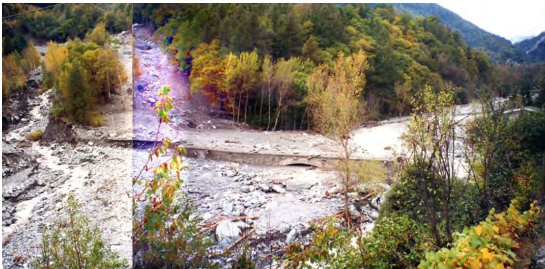
FOTO 50 - Exilles - Ponte sulla Dora crollato, strada per stazione FS (conf. Rivo Comba Bosco)
