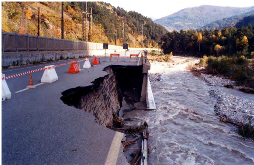
FOTO 66 - Dora di Bardonecchia poco a valle di Royeres (Oulx): erosione spondale punto di intestazione muro di difesa strada statale (il fenomeno è stato fermato dal muro di difesa realizzato in epoca precedente all'ampliamento della carreggiata).
