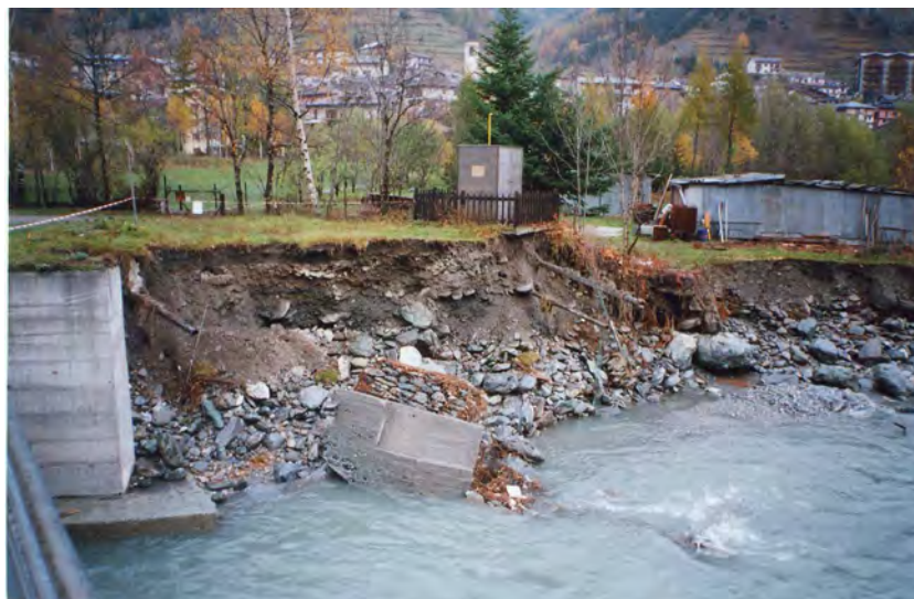
FOTO 16 - T.Chisone a Fenestrelle: erosione spondale; interruzione tubi distribuzione metano.
