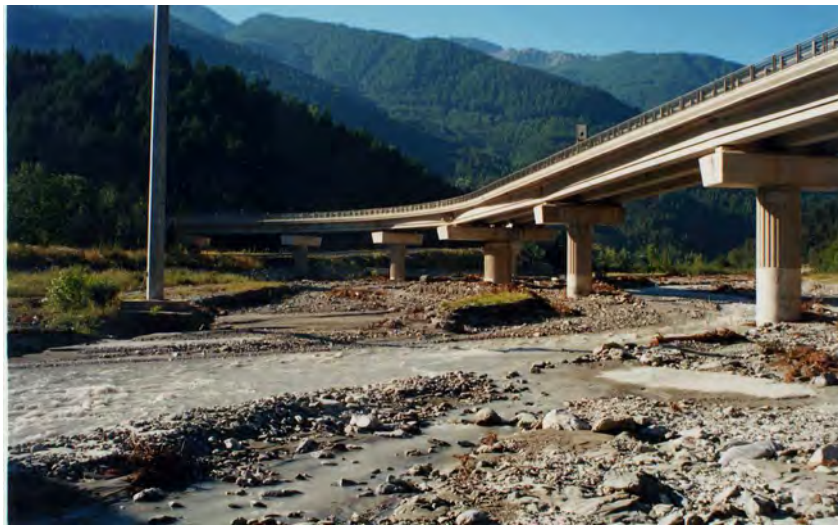
FOTO 34a- Dora Riparia ad Oulx; viadotto S.S. n. 24: canali di erosione aperti nel piazzale del ex cantiere per l'edificazione dell'attraversamento.
