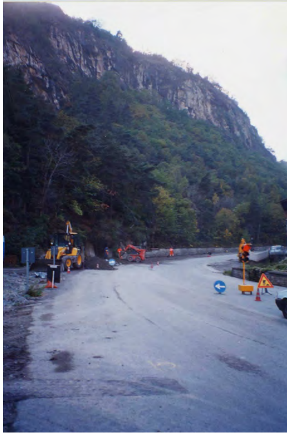
FOTO 42 - Gravere - Frana sulla SS 24
