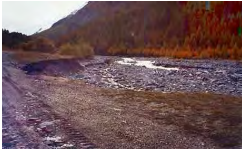
FOTO 34 - T.Ripa nei pressi di Ponte delle Albere (Sauze di Cesna). Erosione spondale in destra a monte dell'attraversamento.
