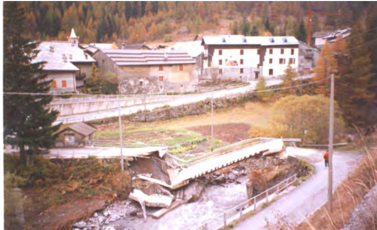
FOTO 129 - Pragelato - Ponte crollato per fraz. Soucheres Basses sul T. Chisone
