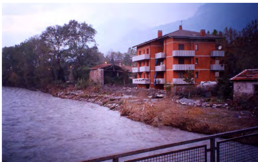
FOTO 7 - Bussoleno - Ponte in ferro sulla Dora Riparia, vista sponda sx esondata
