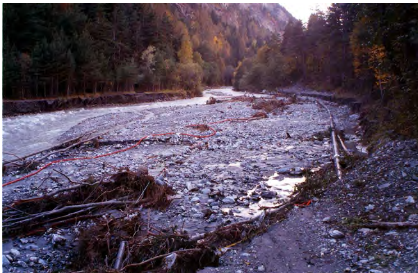
FOTO 64 - Dora di Bardonecchia a monte confluenza rio Perilieux (Bardonecchia): ampia erosione spondale in sinistra; messa a giorno tratto di metanodotto ed interruzione linee elettriche interrante.
