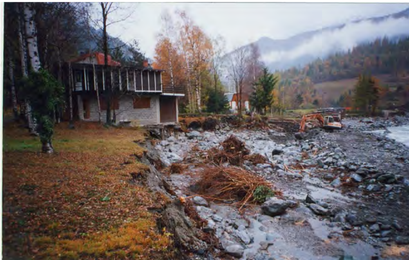
FOTO 14 - T.Chisone a Fenestrelle: erosione spondale in sinistra idrografica. Scopertura delle fondazioni di un edificio abitativo.
