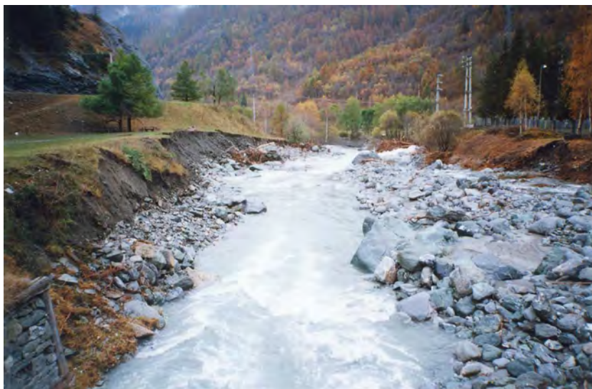
FOTO 18 - T.Chisone a Fenestrelle; ponte presso centrale SKF; erosione spondale tratto a valle dell'attraversamento.
