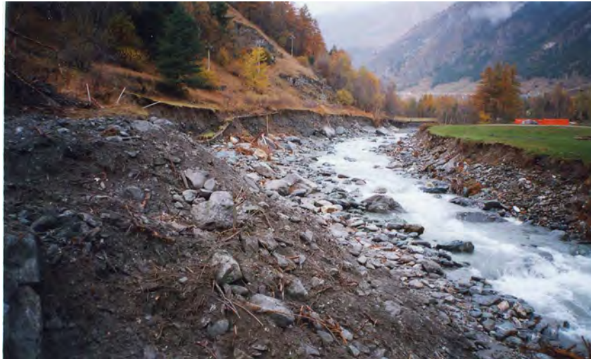
FOTO 15 - T.Chisone a Fenestrelle: erosione spondale; in sponda destra scoperta del metanodotto.
