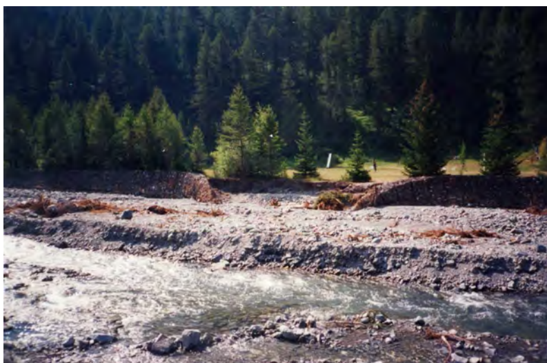
FOTO 3a- Ripa a Rollieres: gabbionata in sponda sinistra a protezione area colonia estiva; tratto brecciato per erosione al piede dell'opera.
