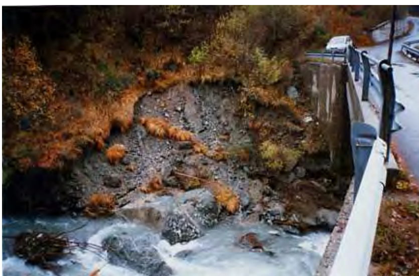
FOTO 10 - T.Chisone al ponte stradale per località Laux (Usseaux): frana di sponda, a monte dell'attraversamento in sponda sinistra.
