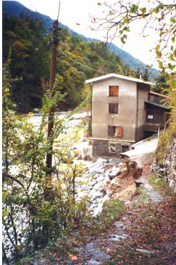
FOTO 51 - Exilles - Rilevato stradale eroso (sponda sx Dora), casa danneggiata e p.te strada per stazione FS crollato.
