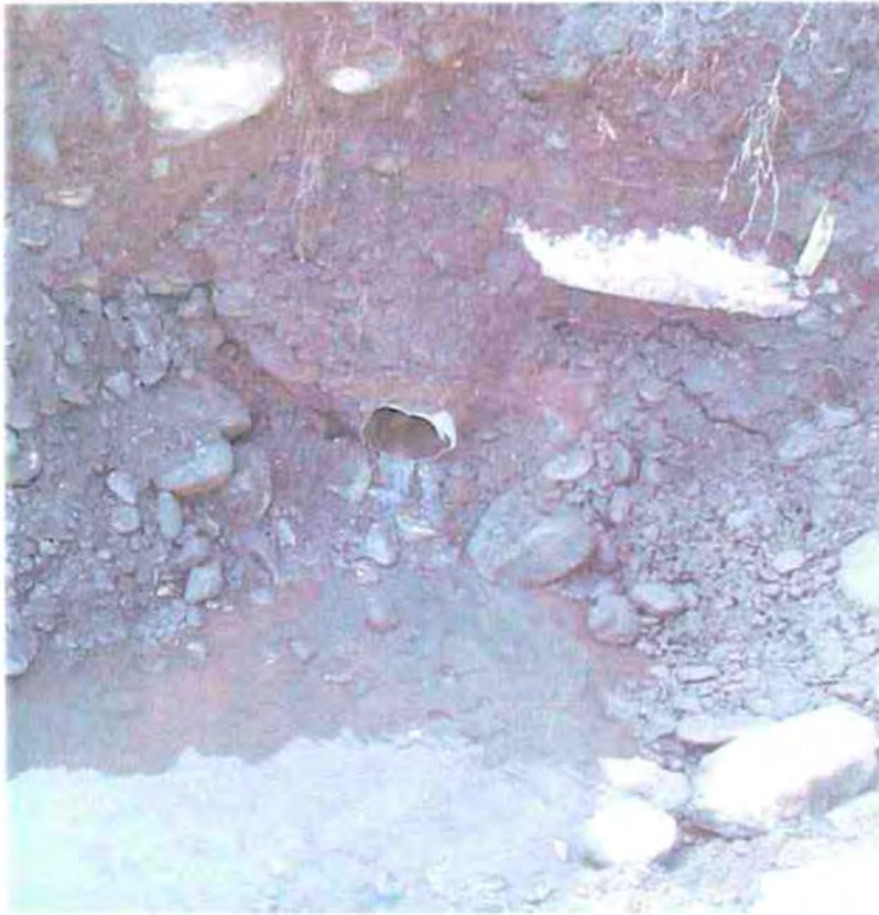
Foto 1: FENESTRELLE – località Chambon, rottura tubazione fognatura
