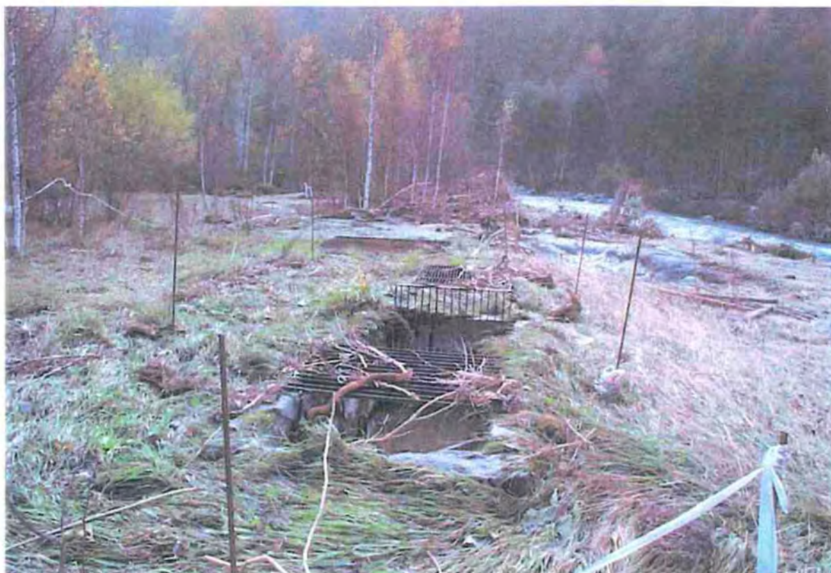
Foto 6: FENESTRELLE – località Chambon, rottura tubazione fognatura
