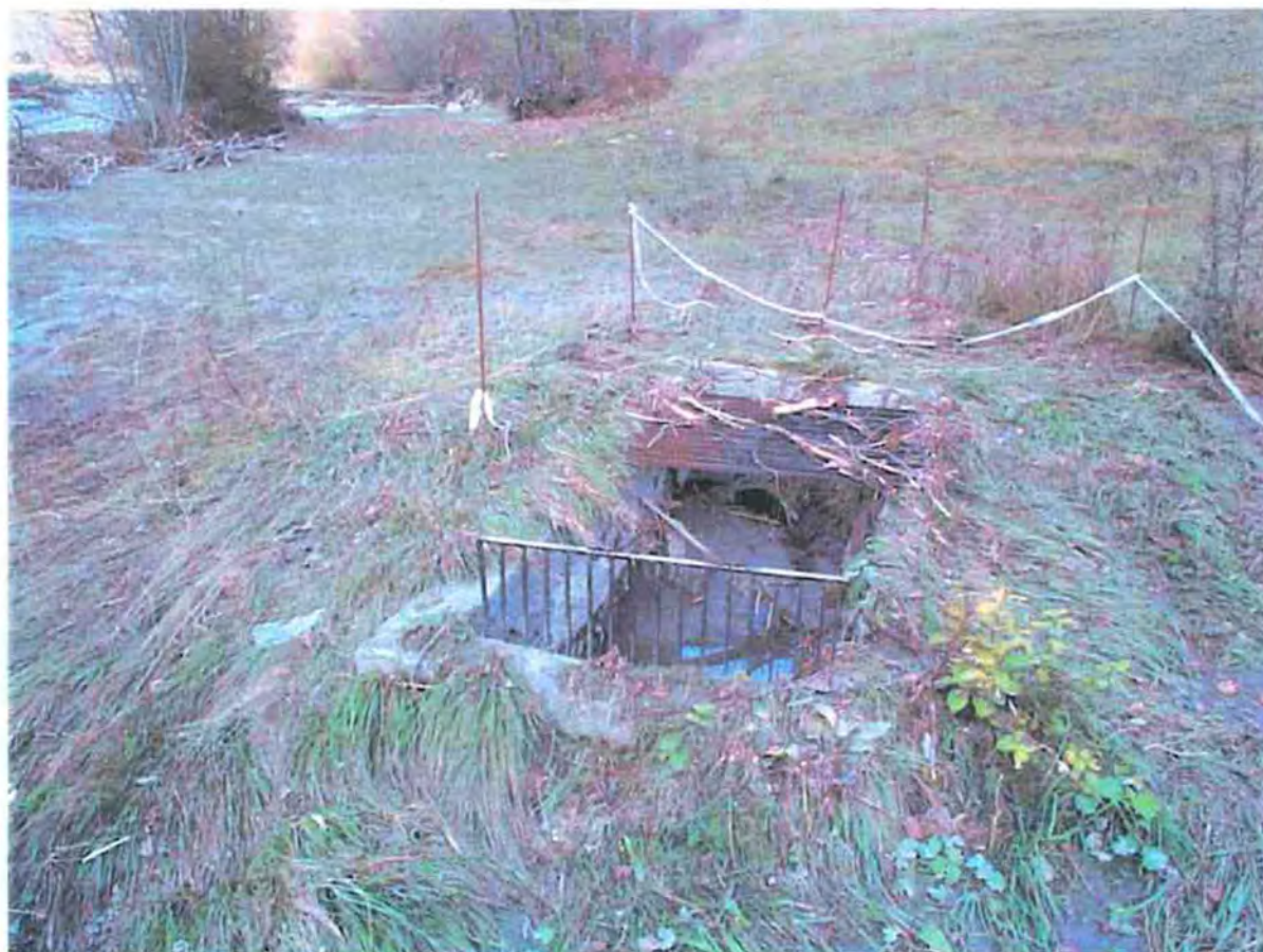
Foto 6, 7: FENESTRELLE – località Mentouilles, Vasche imhoff insabbiate.
