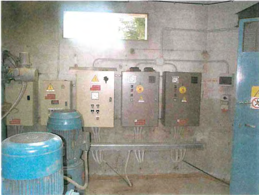
FOTO 5 Campo pozzi acquedotto intercomunale
