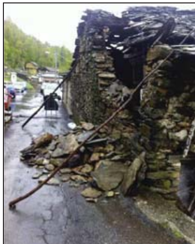
Danni a fabbricati
