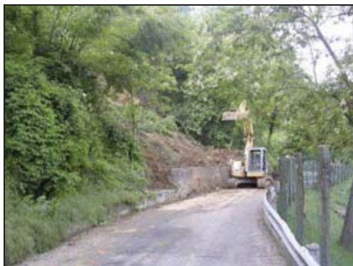
Figura 6 _franamento a Valfenera
