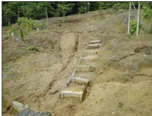
Figura 12 – franamento in località Vietti
