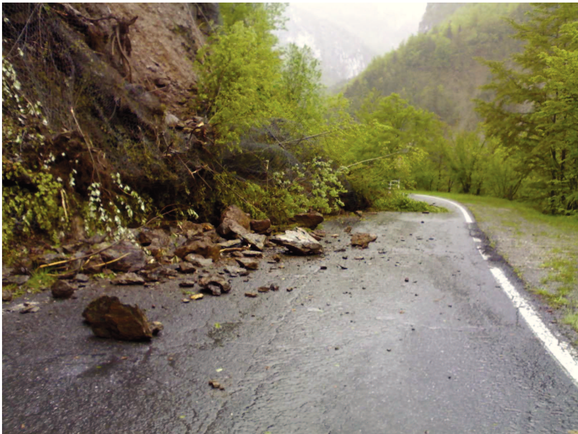
Fig. 14 – Frana sulla SP n. 154 (Ponte di Nava – Viozene)
