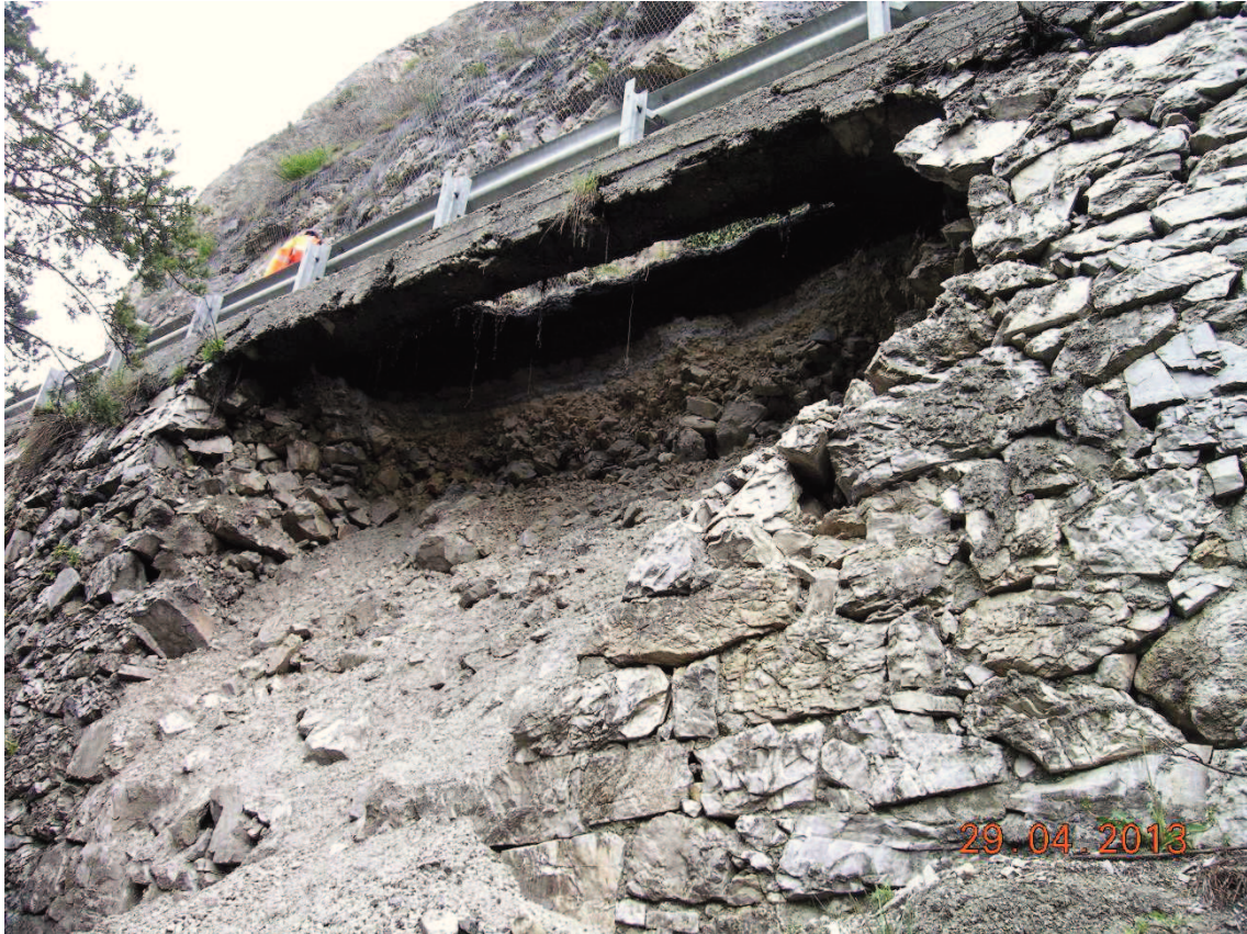
Fig. 16 – Frana sulla SP n. 422 (Km 58+500)
