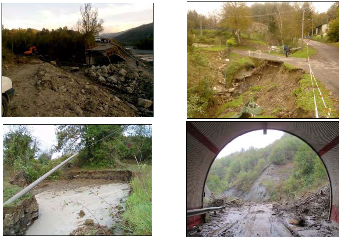
Figura 14 – Borghetto Borbera, in alto danni a sedi stradali; in basso frana per scivolamento planare ed imbocco galleria SP 120 .
