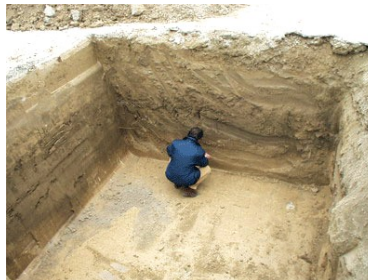
Ambiente confinato Fossa con possibile presenza di CO 2 , H 2 S, SO 2
