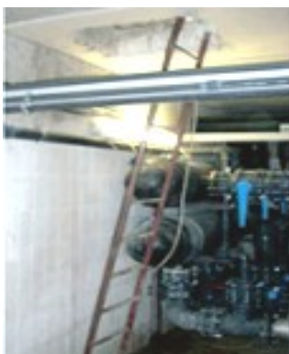
Ambiente assimilabile: locale tecnico piscine
