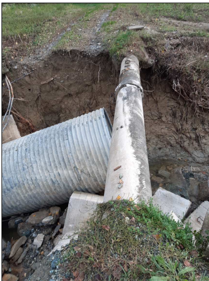
Mornese – Danni alla rete fognaria
