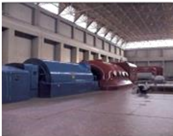
Sala macchine prima dello smantellamento
