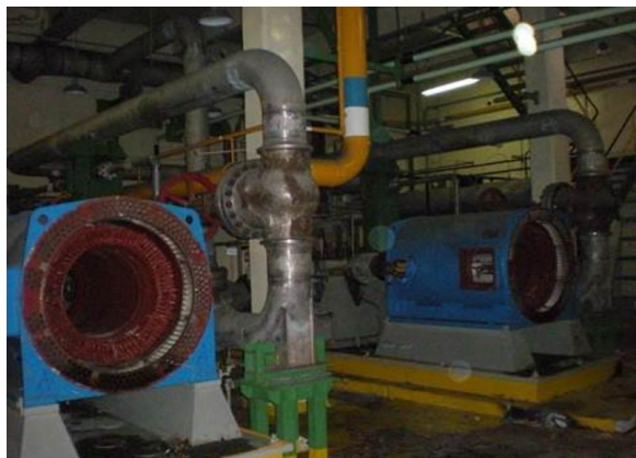
Locale scambiatori prima dello smantellamento
