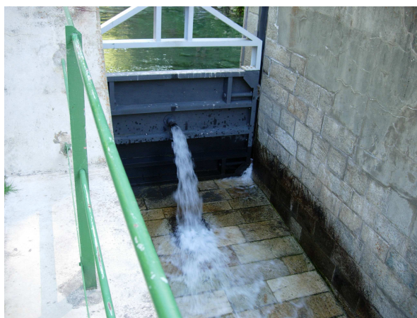
Figura 15: Rilascio del DMV tramite foro circolare con tubo addizionale sulla paratoia di callone: opera sussidiaria della Diga di Castello (ENEL) in valle Varaita (Foto Comoglio)
