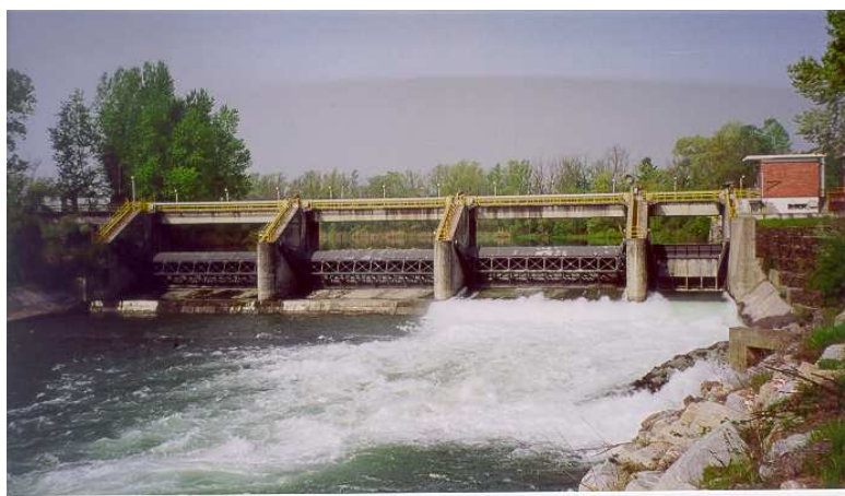
Figura 20: Traversa con organi di regolazione sul Fiume Po a La Loggia – AEM Torino (Foto Comoglio)
