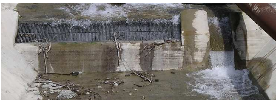
Figura 19: Particolare di traversa derivante con sezione di deflusso del DMV sul T. Clarea – AEM Torino (Foto Comoglio)
