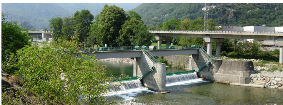
Figura 21: Traversa con sfioro su paratoie a settore - Torrente Orco a Pont Canavese (TO) – ENEL (Foto Comoglio)
