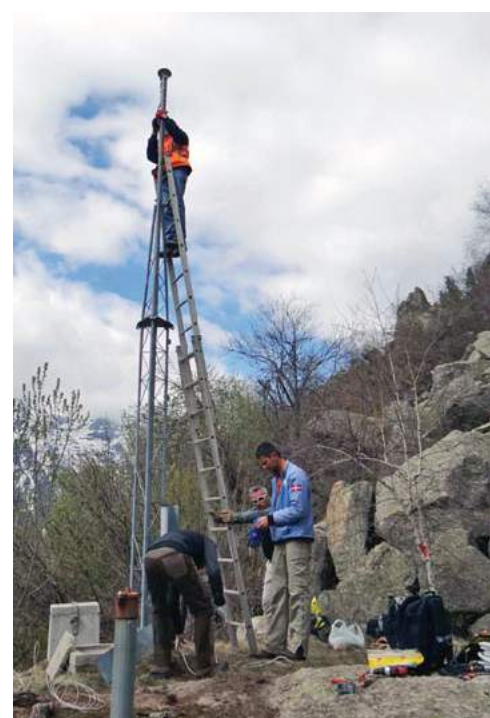
Frana di Rosone - antenna GPS. L'immagine evidenzia le attività che Arpa Piemonte, tramite ditte specializzate, sta conducendo in loco per il ripristino degli strumenti. Un operatore ha da poco collocato una nuova antenna GPS all'estremità del traliccio metallico, posizione che garantisce una buona ricezione dei segnali satellitari
