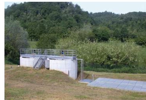
Impianto di depurazione realizzato
