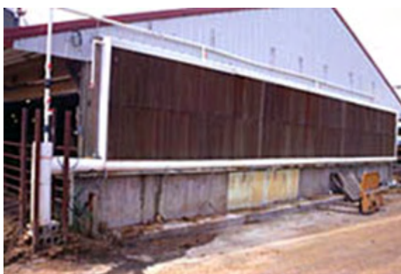
Foto 13—14: edifici attrezzati con pannelli rinfrescanti (pad cooling)
