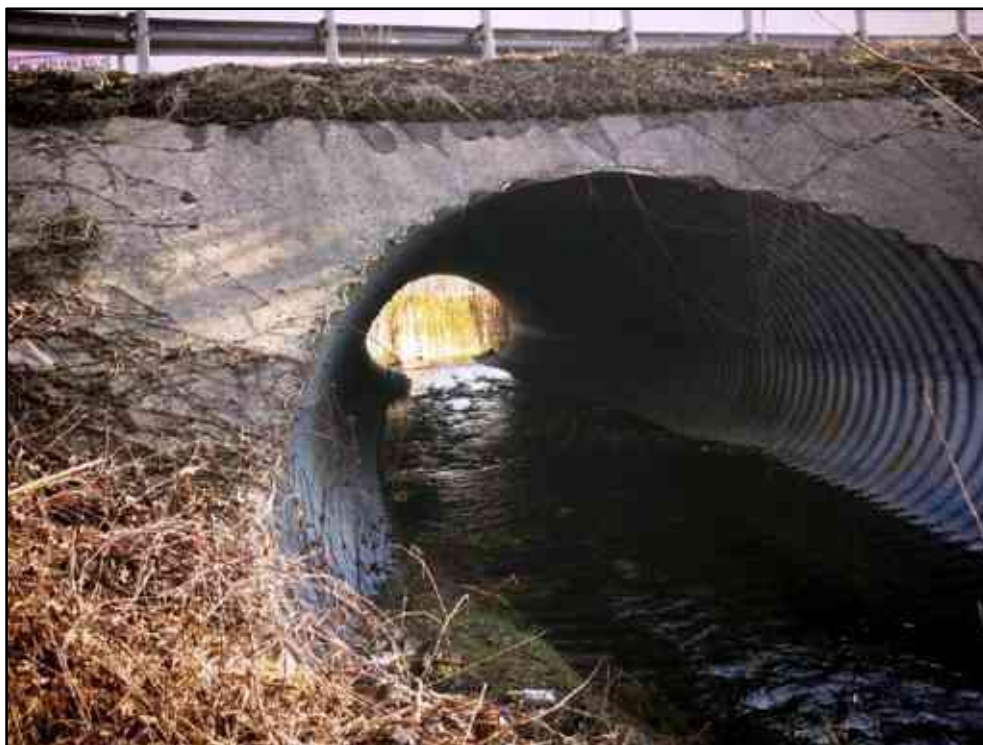
Figura 78 – Passaggio in lamiera grazie al quale il fosso Geola scorre sotto la SR142 Biellese.
