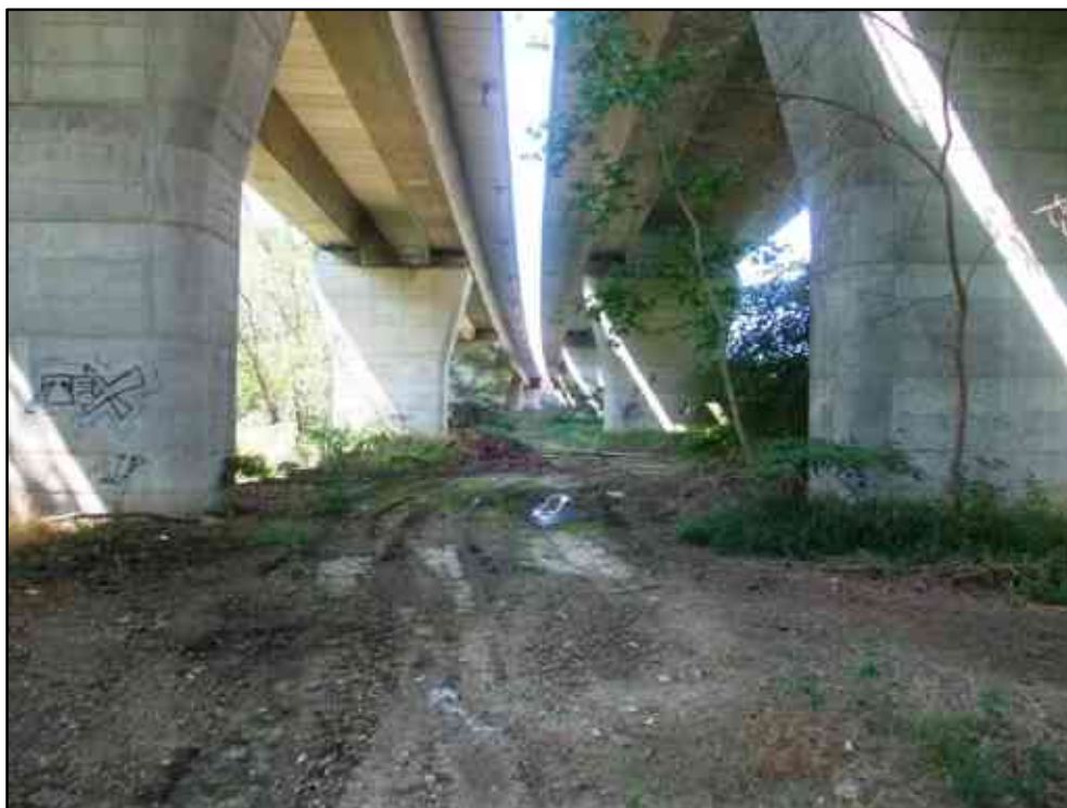
Figura 120 – Veduta dell'ampio fronte di potenziale attraversamento sotto il cavalcavia Lirone della A26-Genova Voltri/Gravellona Toce.
