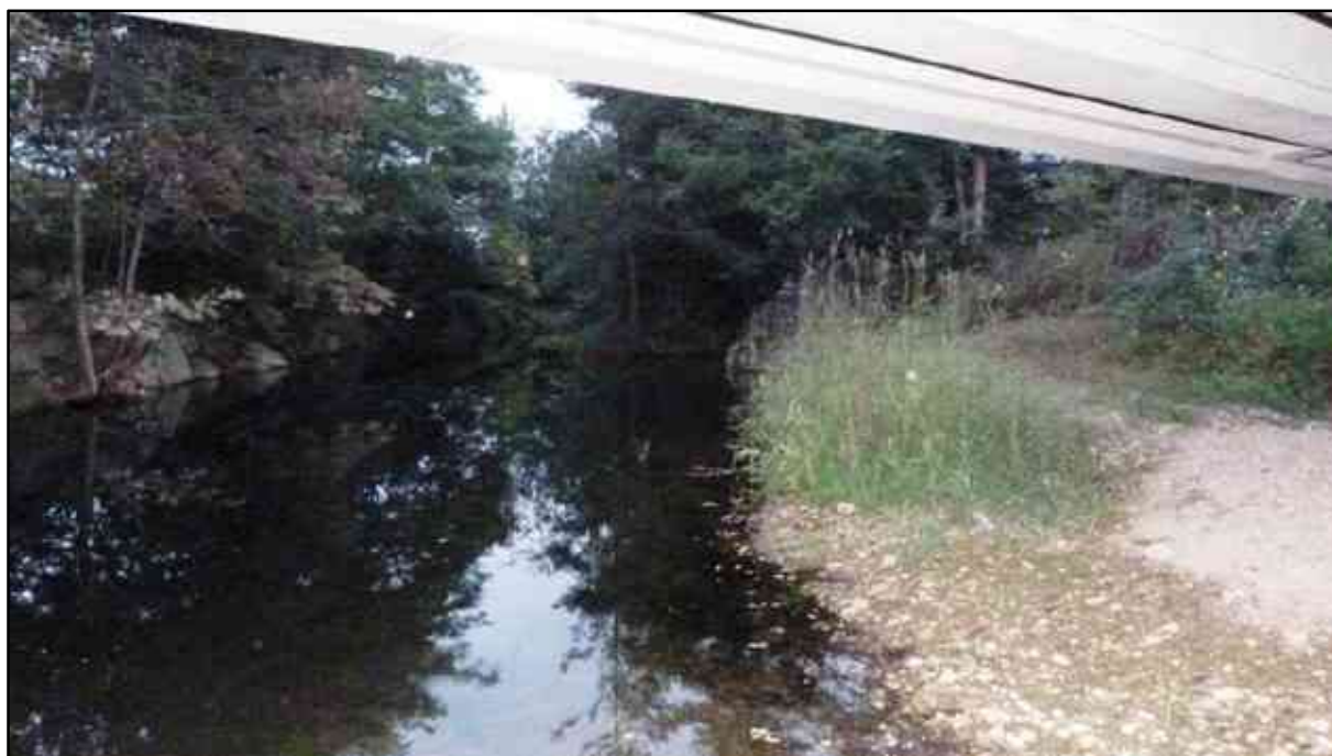
Figura 253 - Interruzione lungo la sponda sinistra idrografica del torrente Terdoppio, nel tratto sottostante la SP17.
