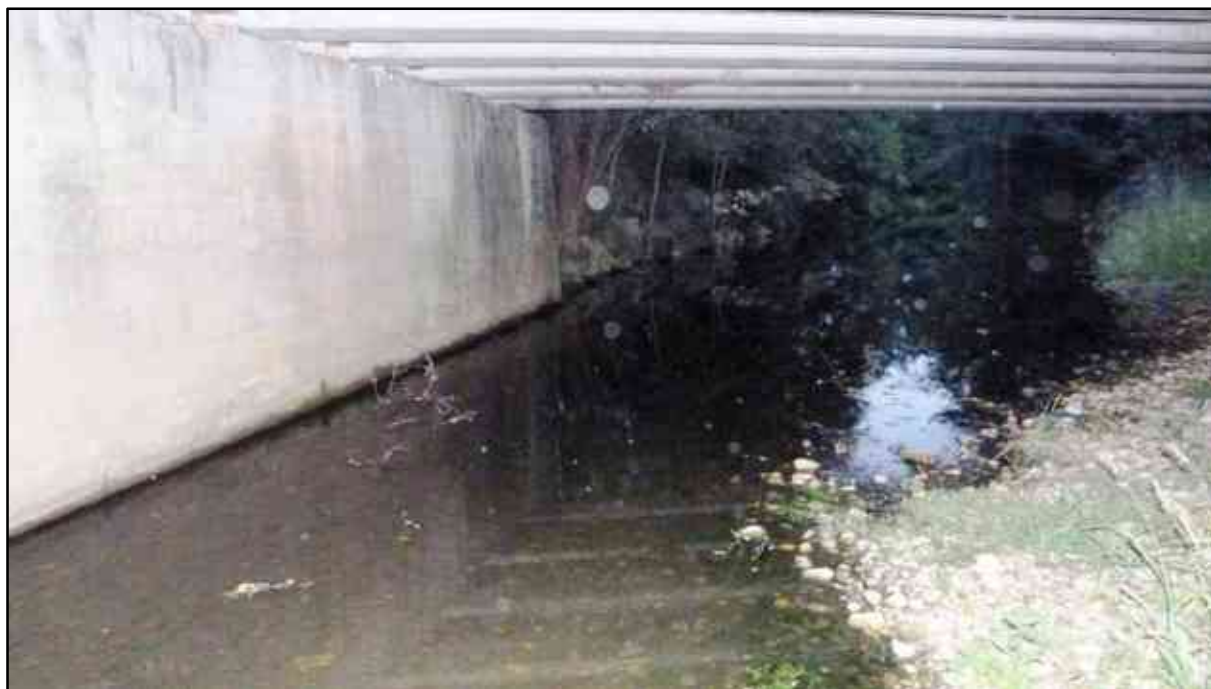
Figura 252 – Interruzione lungo la sponda destra idrografica del torrente Terdoppio, nel tratto sottostante la SP17.
