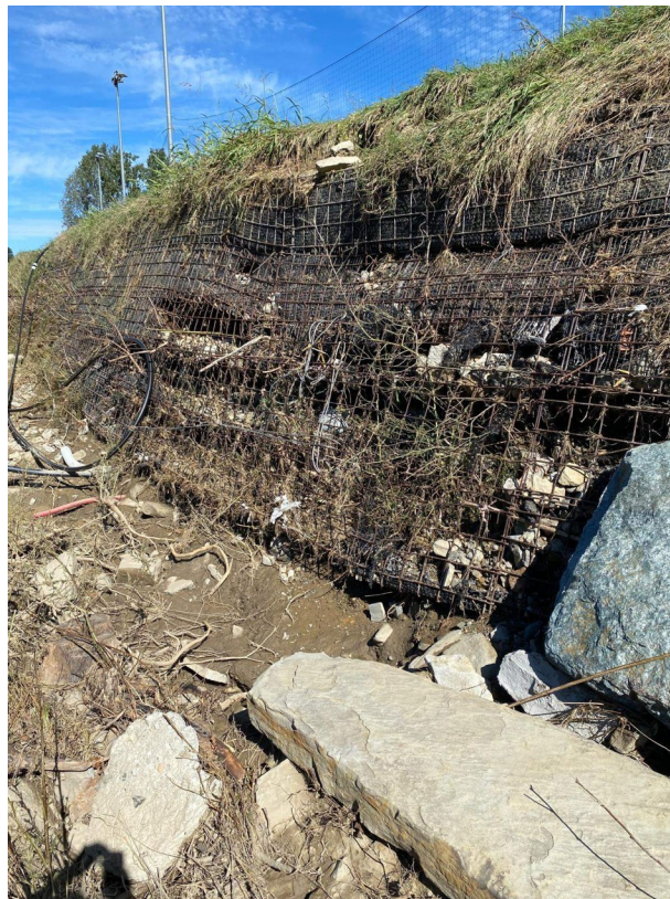
Figura 11. Opere di difesa danneggiate, via Carlo Alberto. Comune di Ponti (AL). Fonte Regione Piemonte
