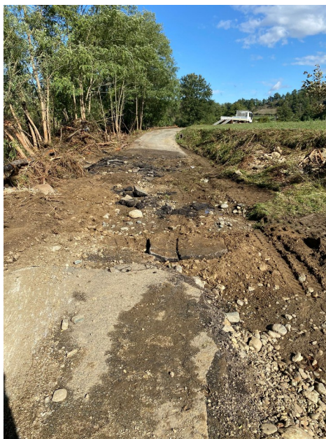
Figura 15. Strada Martini Bricco: esondazione del Torrente Valla con danneggiamento di un tratto di carreggiata per la lunghezza di circa 20 metri. Comune di Spigno Monferrato (AL). Fonte Regione Piemonte
