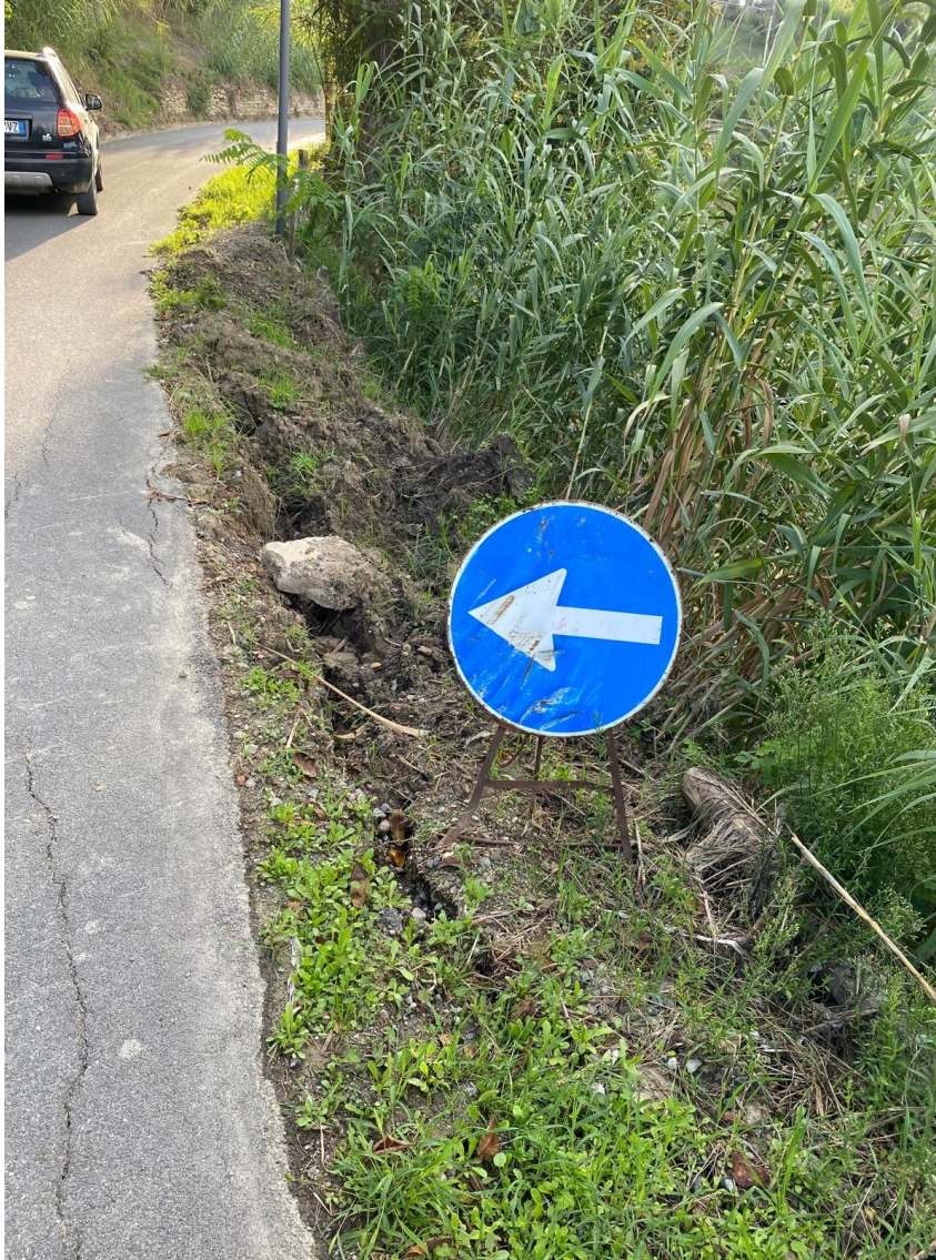
Figura 30. Smottamento via San Rocco. Comune di Montabone (AT). Fonte Regione Piemonte
