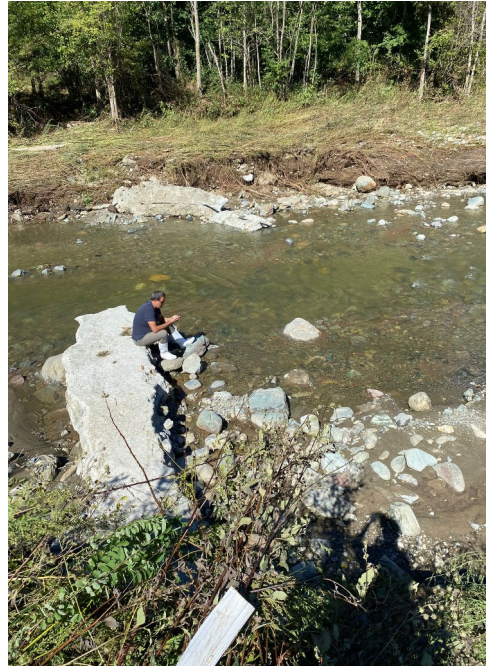
Figura 21. Torrente Valla, Località Prato Ronchi interruzione rete acquedotto. Comune di Spigno Monferrato. (AL). Fonte Regione Piemonte
