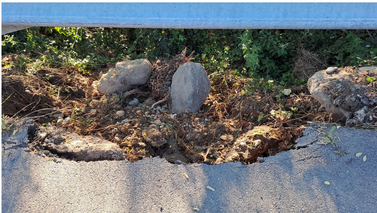
Figura 9. Cedimento sottoscarpa della sede viabile della strada comunale Granozza. Comune di Ovada (AL). Fonte Regione Piemonte
