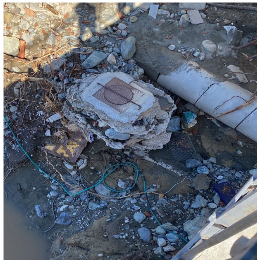
Figura 22: Ponte Via Gattere sul torrente Valla: scalzamento delle fondazioni. Comune di Spigno Monferrato. (AL). Fonte Regione Piemonte
