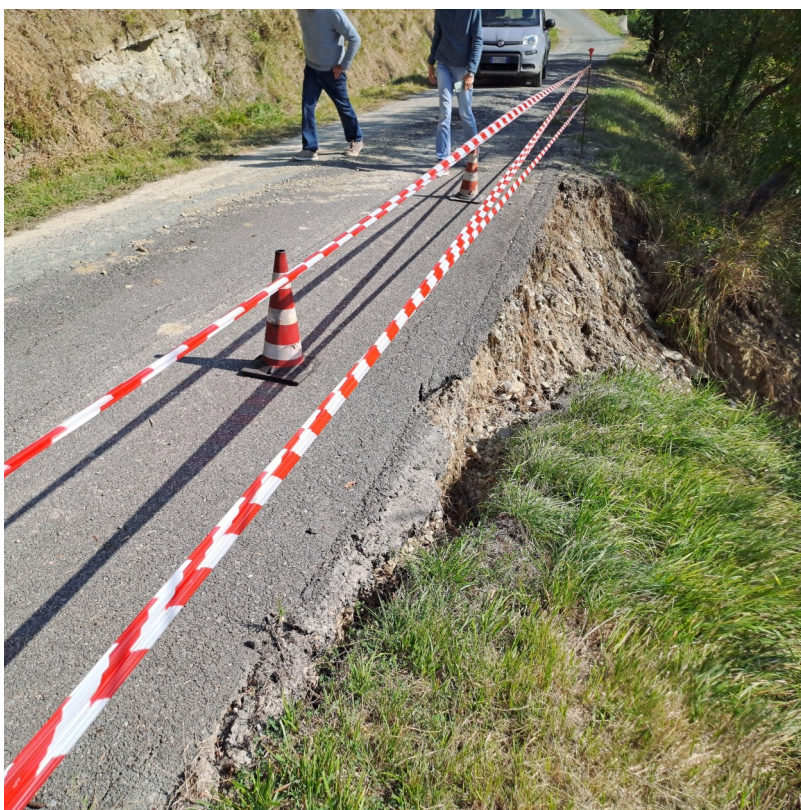
Figura 6. Danni strada comunale Valle Croce. Comune di Cavatore (AL). Fonte Regione Piemonte
