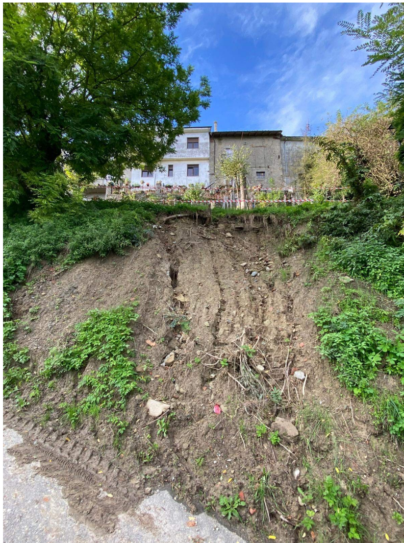
Figura 29. Smottamento via Orsola Caccia e via Sotto Fosso. Comune di Montabone (AT). Fonte Regione Piemonte
