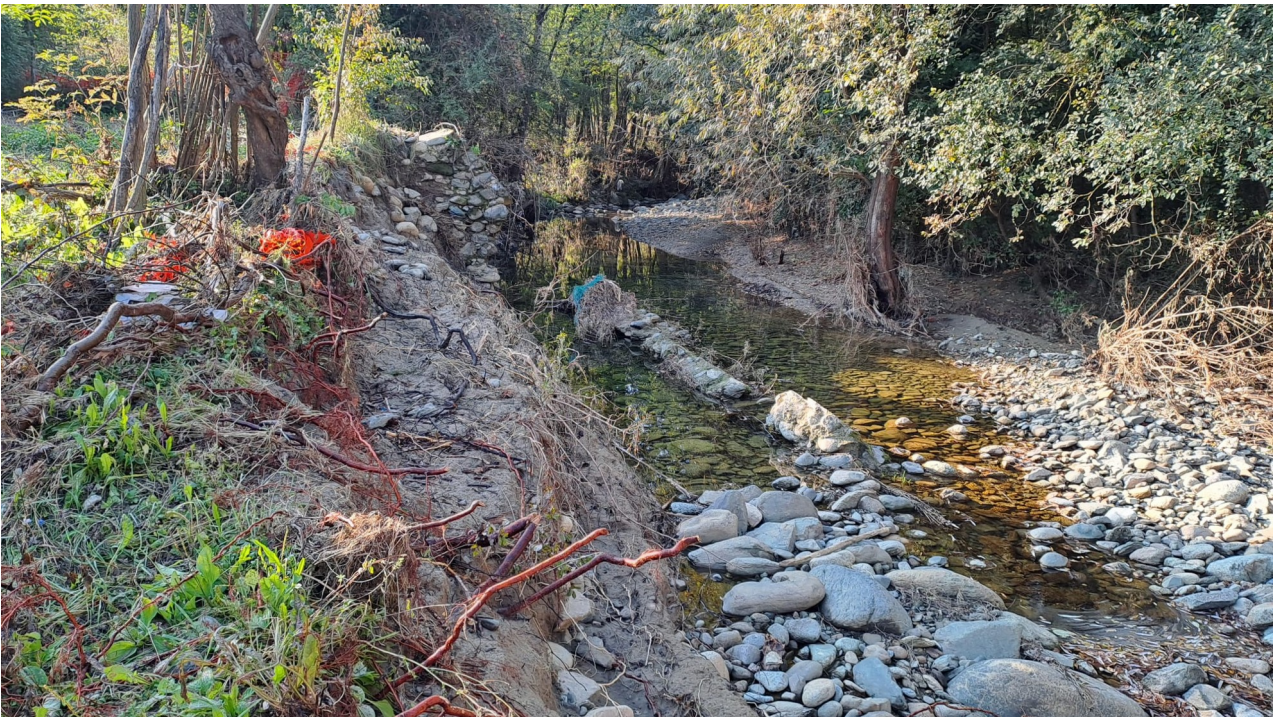
Figura 7. Erosioni di sponda lungo il rio Requagliolo. Comune di Ovada (AL). Fonte Regione Piemonte
