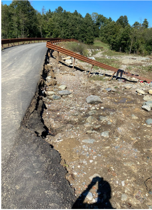
Figura 20. Danneggiamento ponte sul Torrente Valla in Località Prato Ronchi. Comune di Spigno Monferrato. (AL). Fonte Regione Piemonte
