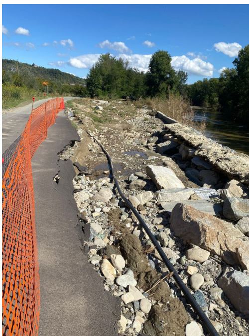
Figura 18. Strada Fornarini: danneggiamento del corpo stradale a seguito dell'esondazione del fiume Bormida di Spigno. Comune di Spigno Monferrato. (AL). Fonte Regione Piemonte
