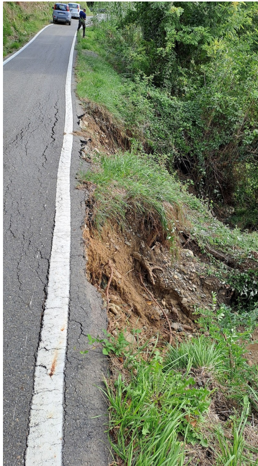
Figura 12. Smottamento lungo la strada comunale “della Valle”. Comune di Rocca Grimalda (AL). Fonte Regione Piemonte
