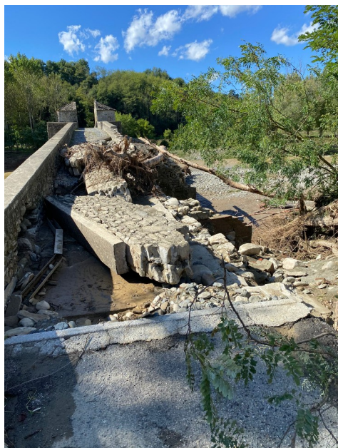
Figura 14. Ponte medievale danneggiato. Comune di Spigno Monferrato. (AL). Fonte Regione Piemonte
