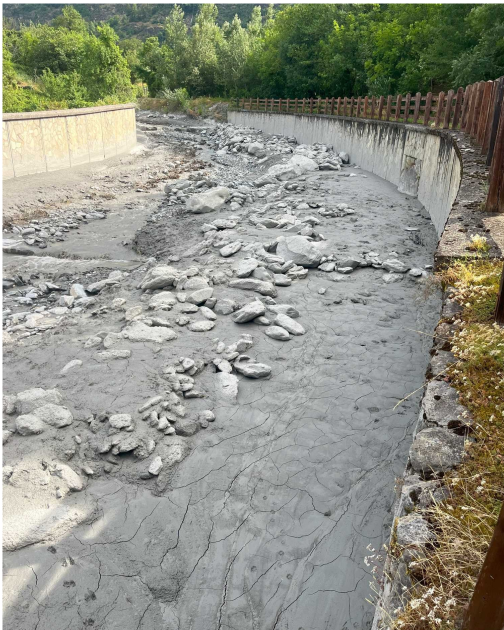
Figura 27. Rio Claretto a Novalesa (TO): tracce di deposito di fango e detriti in alveo. Foto del 7/07/2025. Fonte Regione Piemonte
