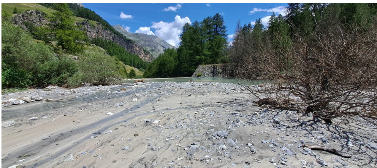
Figura 39. Accumulo materiale a monte della briglia sulla Stura di Demonte. Foto del 4/7/2025. Fonte Regione Piemonte
