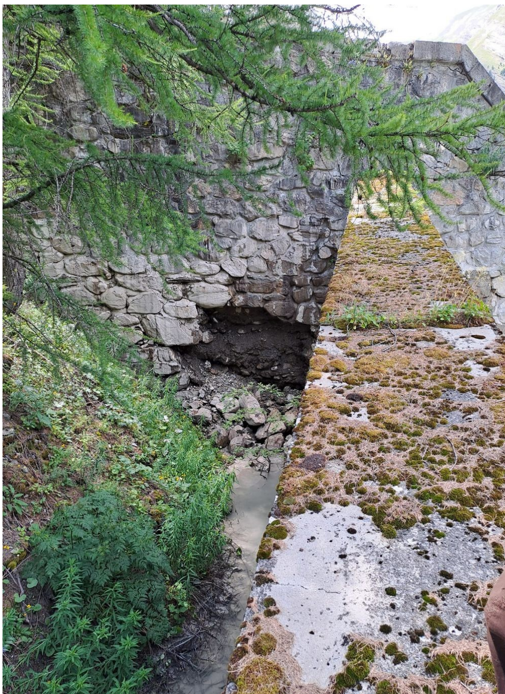
Figura 40. Zoom sul danno alla briglia sulla Stura di Demonte. Fonte Regione Piemonte
