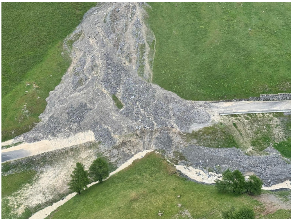
Figura 31. Colata detritica che ricopre la Strada Statale n.21. Fonte Comune di Argentera
