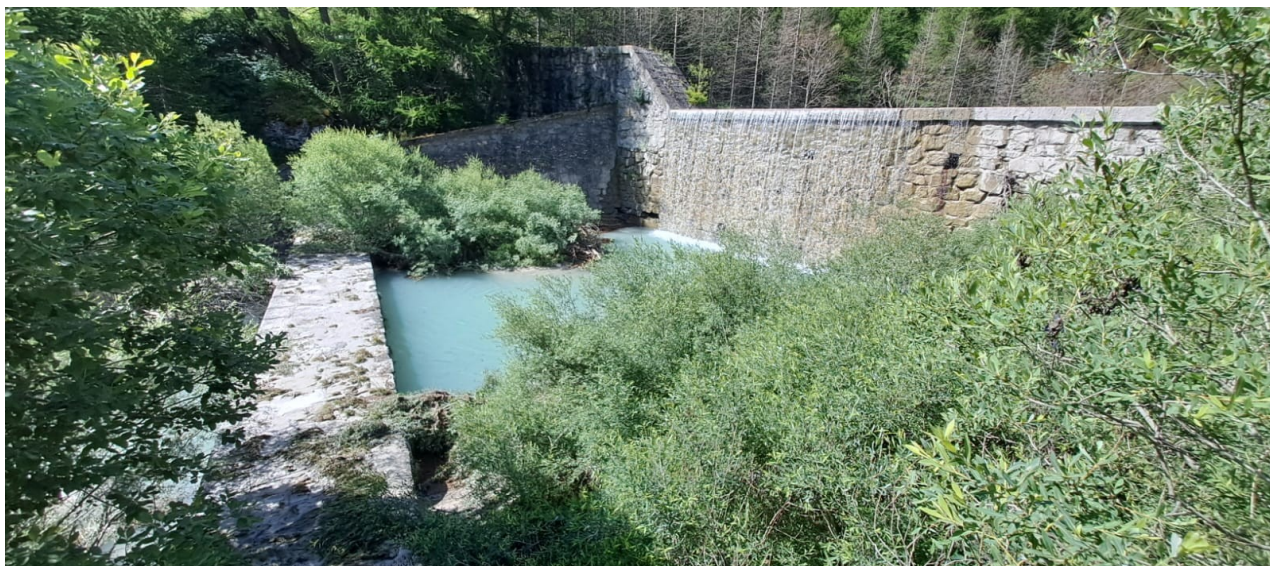
Figura 38. Vista laterale della briglia sulla Stura di Demonte post evento. Foto del 4/7/2025. Fonte Regione Piemonte
