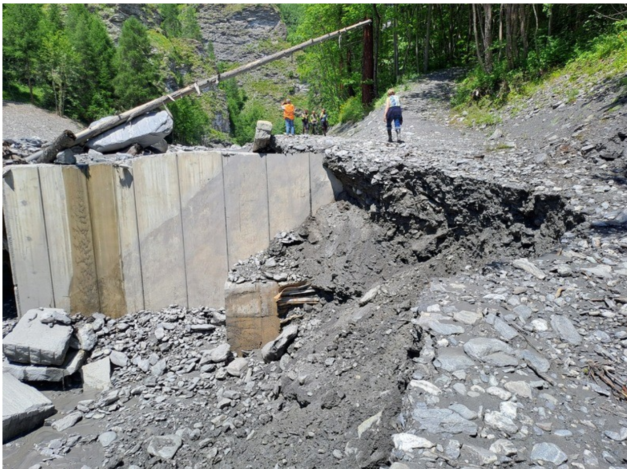
Figura 7. Erosione e deposito di materiale detritico. Briglia sul rio Frejus. Foto del 1° luglio 2025. Fonte Regione Piemonte
