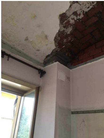
Distacco intonaco dalle volte
