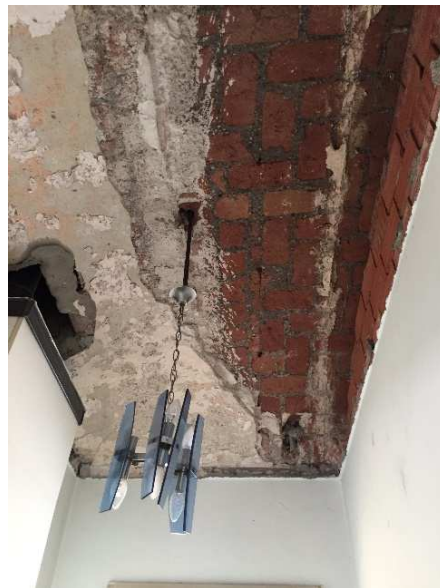
Distacco intonaco dalle volte
