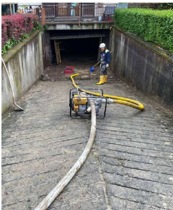
Lauriano Po. Attività di pompaggio dalle abitazioni colpite dall'inondazione
