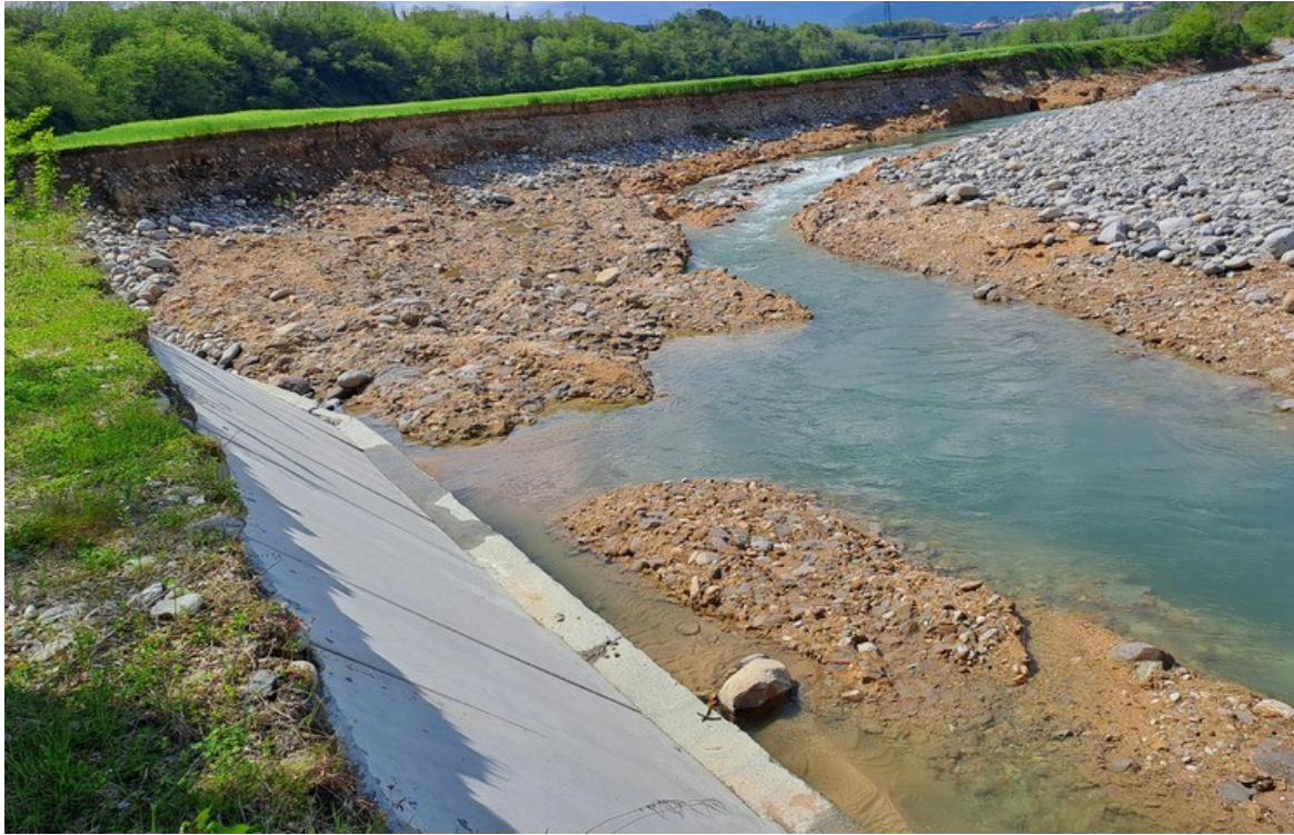
Figura 69 Torrente Cervo in comune di Biella, erosione fondo alveo di 4-5 metri (i pannelli in cls posati a seguito dell'evento alluvionale del 2020 a protezione della ex discarica RSU).
