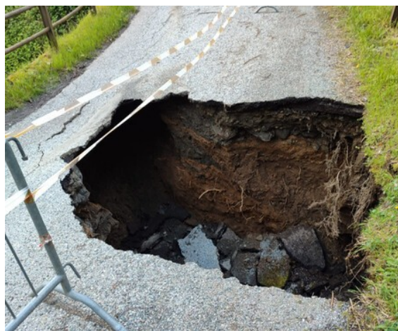
Figura 38. Voragine su strada comunale a Villar Perosa (TO).
