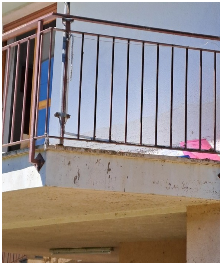
Figura 8. Tracce di fango al primo piano di un'abitazione a Cavagnolo (TO). Data 24/04/2025. Fonte Regione Piemonte
