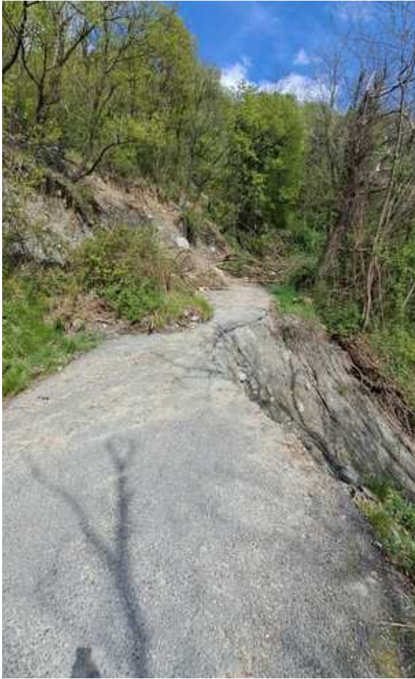
Figura 27. Frana su strada comunale a Caprie (TO). Fonte Regione Piemonte
