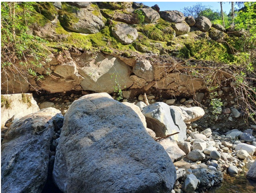
Figura 72. Rio Piletta, scogliera di monte a protezione della frazione San Sudario in Comune di Magnano (BI) scalzata di circa 3 metri. Fonte Regione Piemonte
