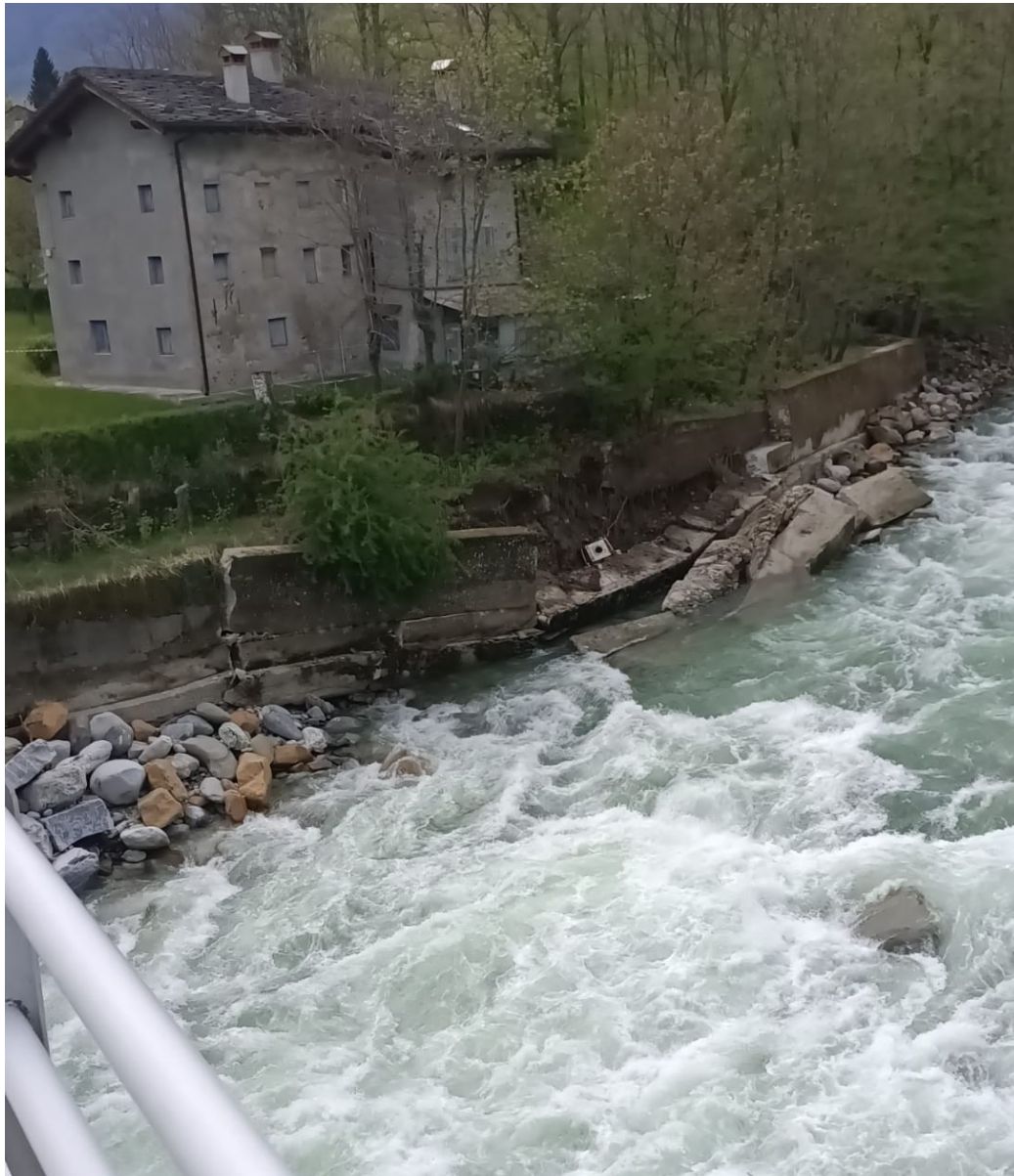
Figura 61. Danni ponte e sponda fiume Sesia a Vocca (VC).
