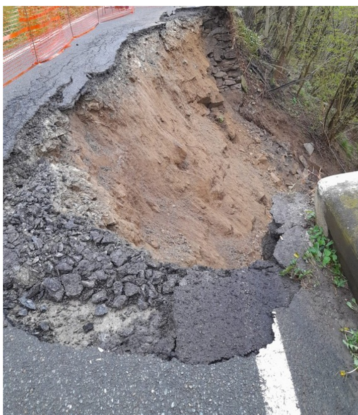
Figura 40. Frana sulla SP n.168
