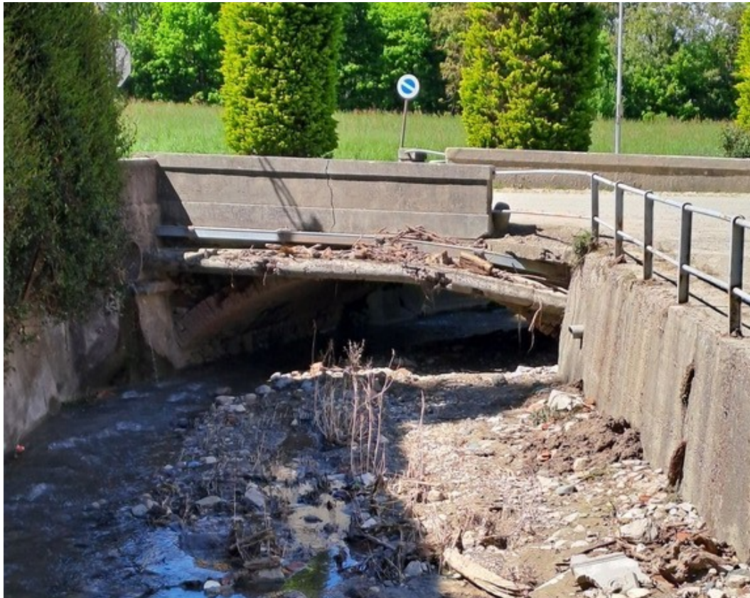
Figura 21. Rio della Valle – Monteu da Po (TO). Fonte Regione Piemonte
