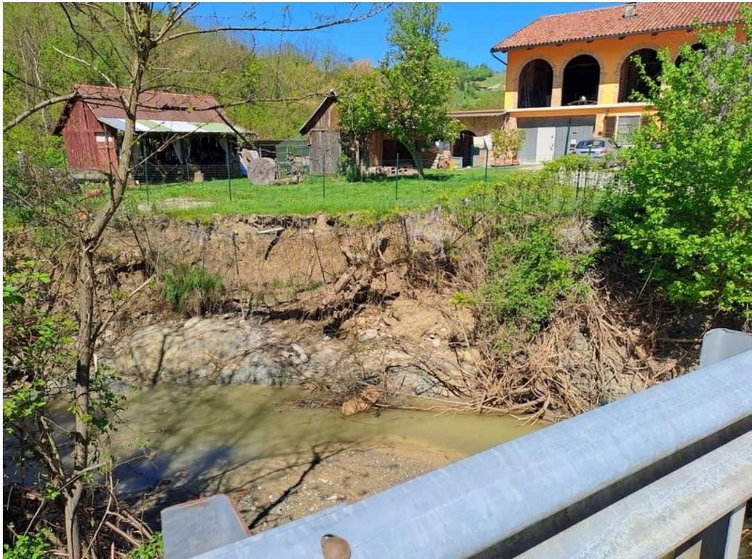
Figura 9. Erosione di sponda rio Trincavena - Cavagnolo (TO). Data 24/04/2025. Fonte Regione Piemonte
