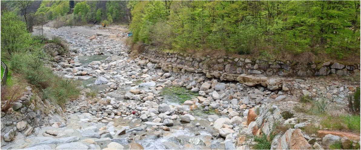
Figura 67. Torrente Cervo in prossimità della confluenza con il torrente Mologna in Comune di Piedicavallo, erosione fondo alveo di circa 3-4 metri. Fonte Regione Piemonte
