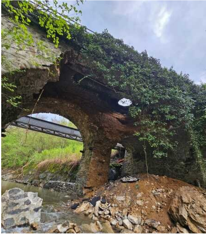
Figura 63. Crollo parziale ponte SP Biella-Pollone. Fonte Provincia di Biella
