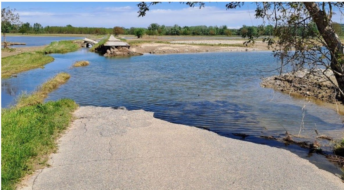
Figura 45. Massicciata stradale totalmente asportata in destra Po in località Piagera di Gabiano (AL). Fonte Regione Piemonte
