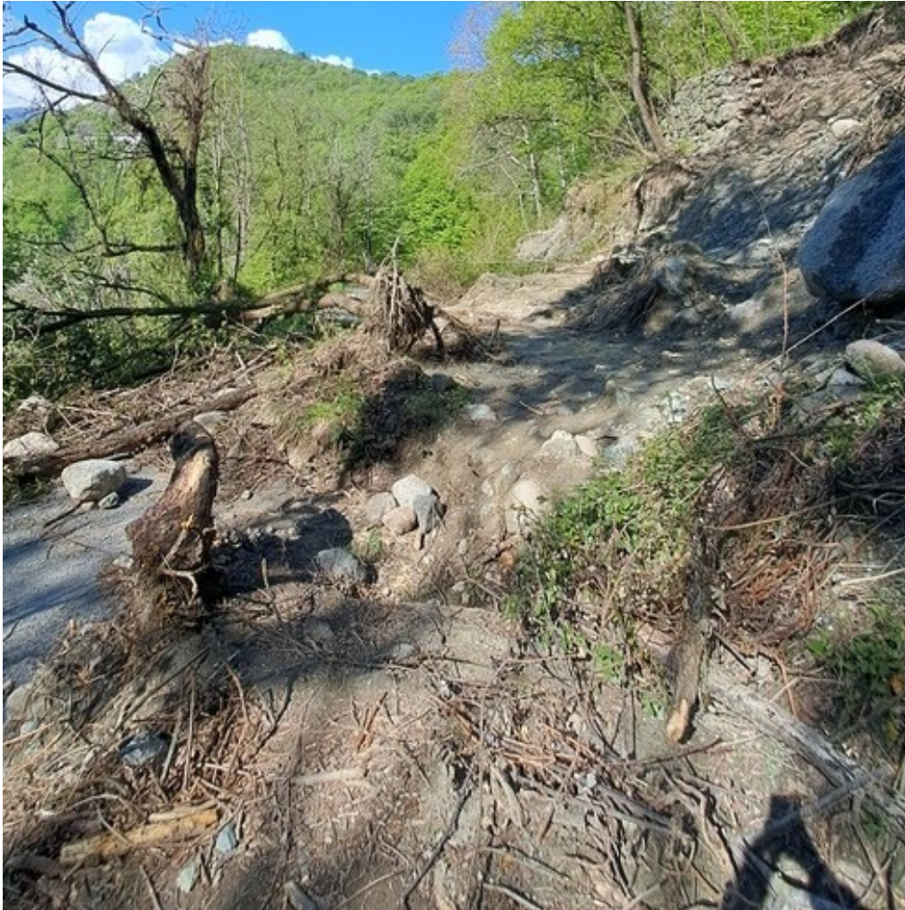
Figura 30. Frana su strada comunale a Caprie (TO). Fonte Regione Piemonte
