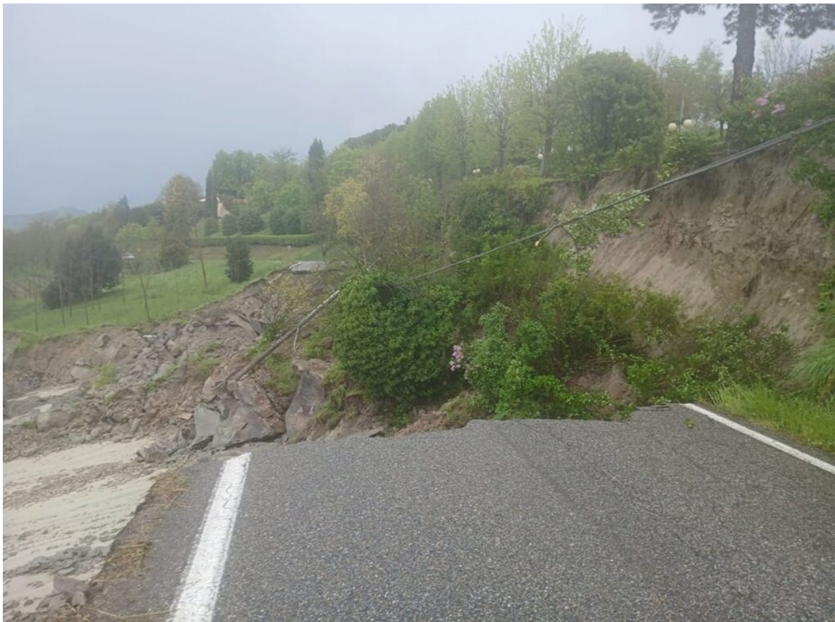
Figura 53. Frana SP n.18 Cocconato d'Asti. Fonte Regione Piemonte
