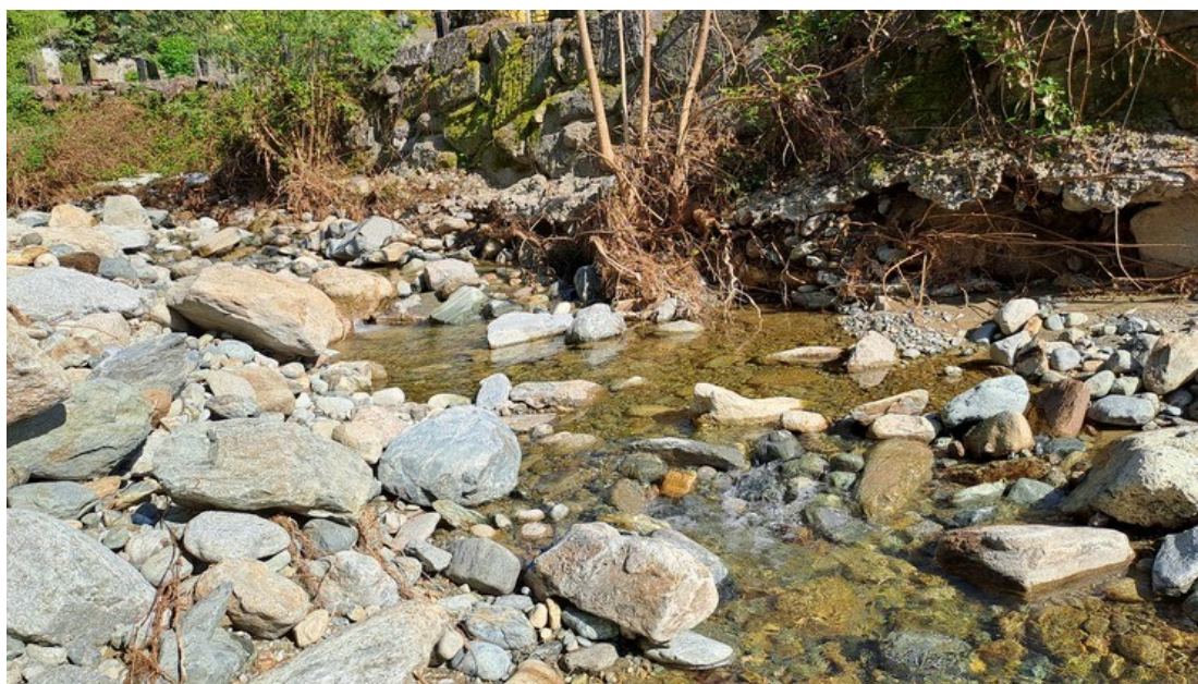
Figura 73. Rio Piletta, scogliera di valle a protezione della frazione San Sudario in Comune di Magnano (BI) scalzata di circa 1 metro. Fonte Regione Piemonte
