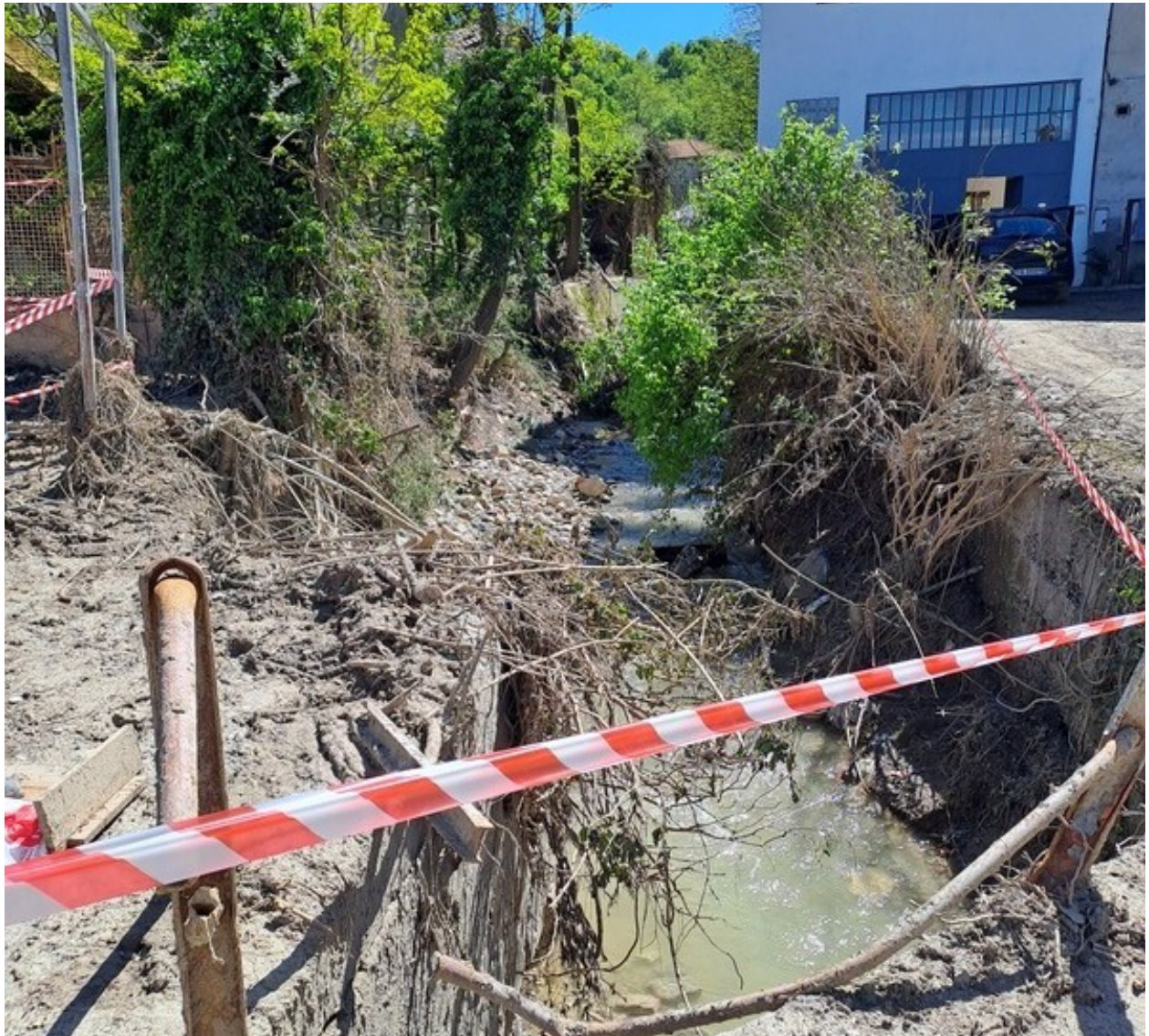
Figura 18. Rio della Valle – Monteu da Po (TO). Fonte Regione Piemonte
