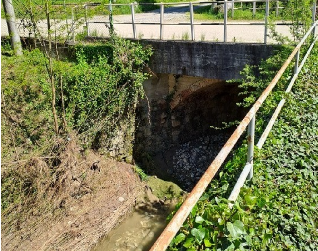
Figura 19. Rio della Valle – Monteu da Po (TO). Fonte Regione Piemonte
