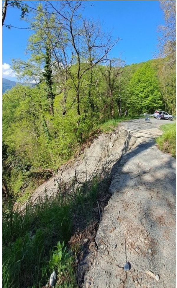
Figura 28. Frana su strada comunale a Caprie (TO). Fonte Regione Piemonte
