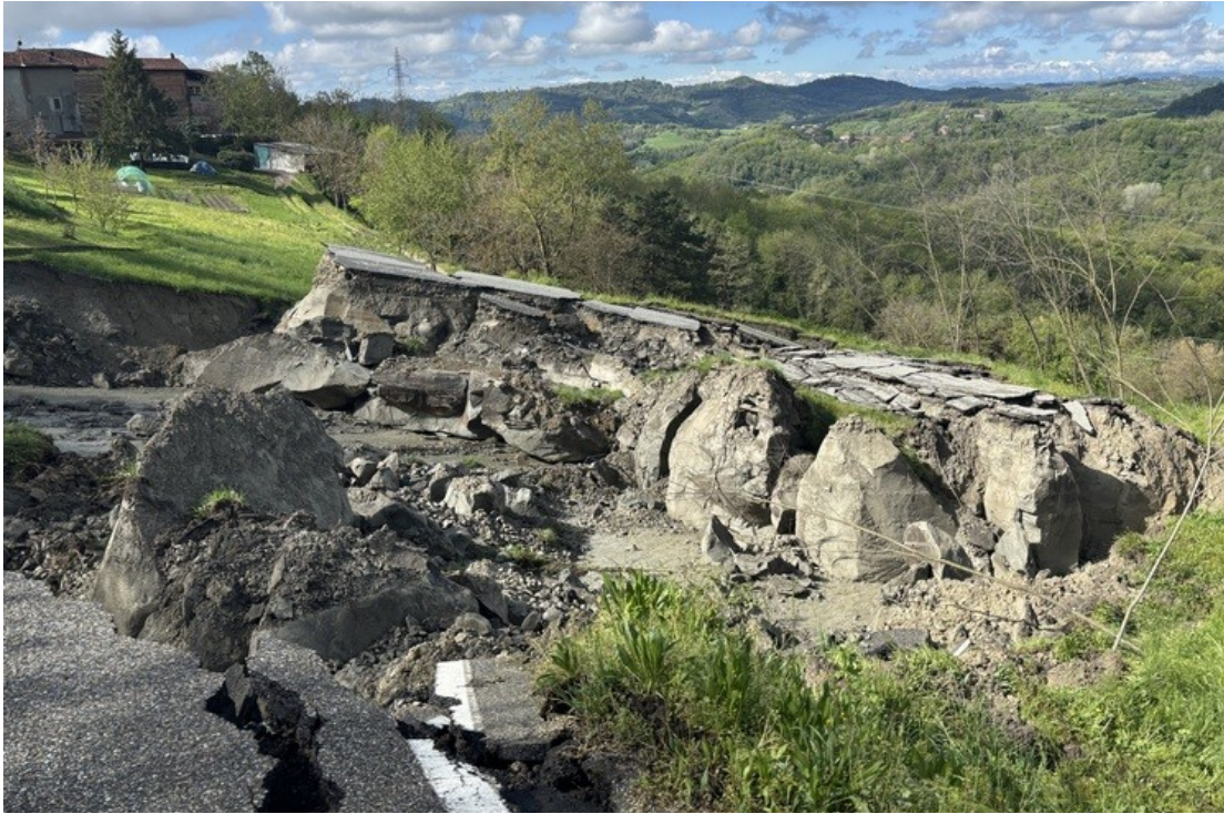
Figura 54. Frana SP n.18 Cocconato d'Asti. Fonte Regione Piemonte
