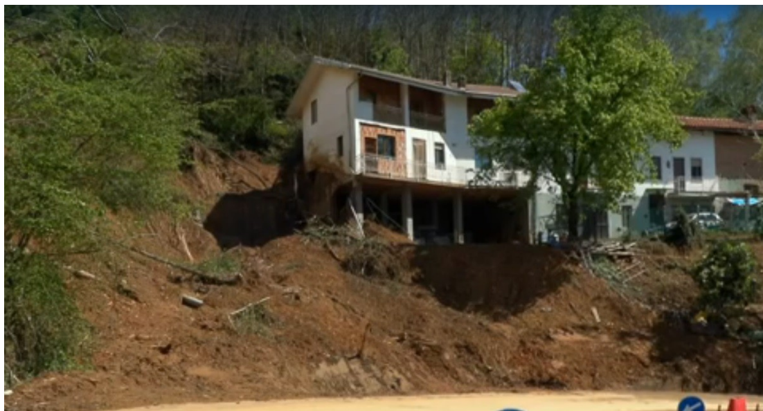
Figura 37. Frana a Sant'Anna dei Boschi, Castellamonte (TO). Fonte Internet
