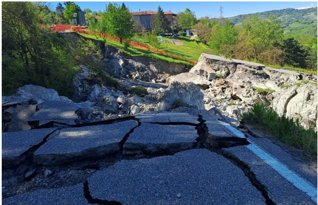
Figura 55. Frana SP n.18 Cocconato d'Asti. Fonte Regione Piemonte
