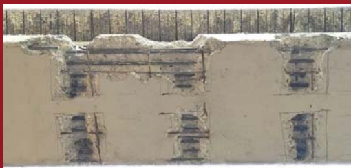
Dettaglio di trave 9 danneggiata artificialmente con 8 trefoli tagliati nella mezzeria
