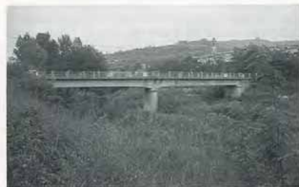
Fig. 2 - Ponte sul T. Belbo, come appariva nel settembre 1991. L'alveo, occupato da una fitta vegetazione arbustiva, necessita di lavori di manutenzione ordinaria per una adeguata ripulitura.
