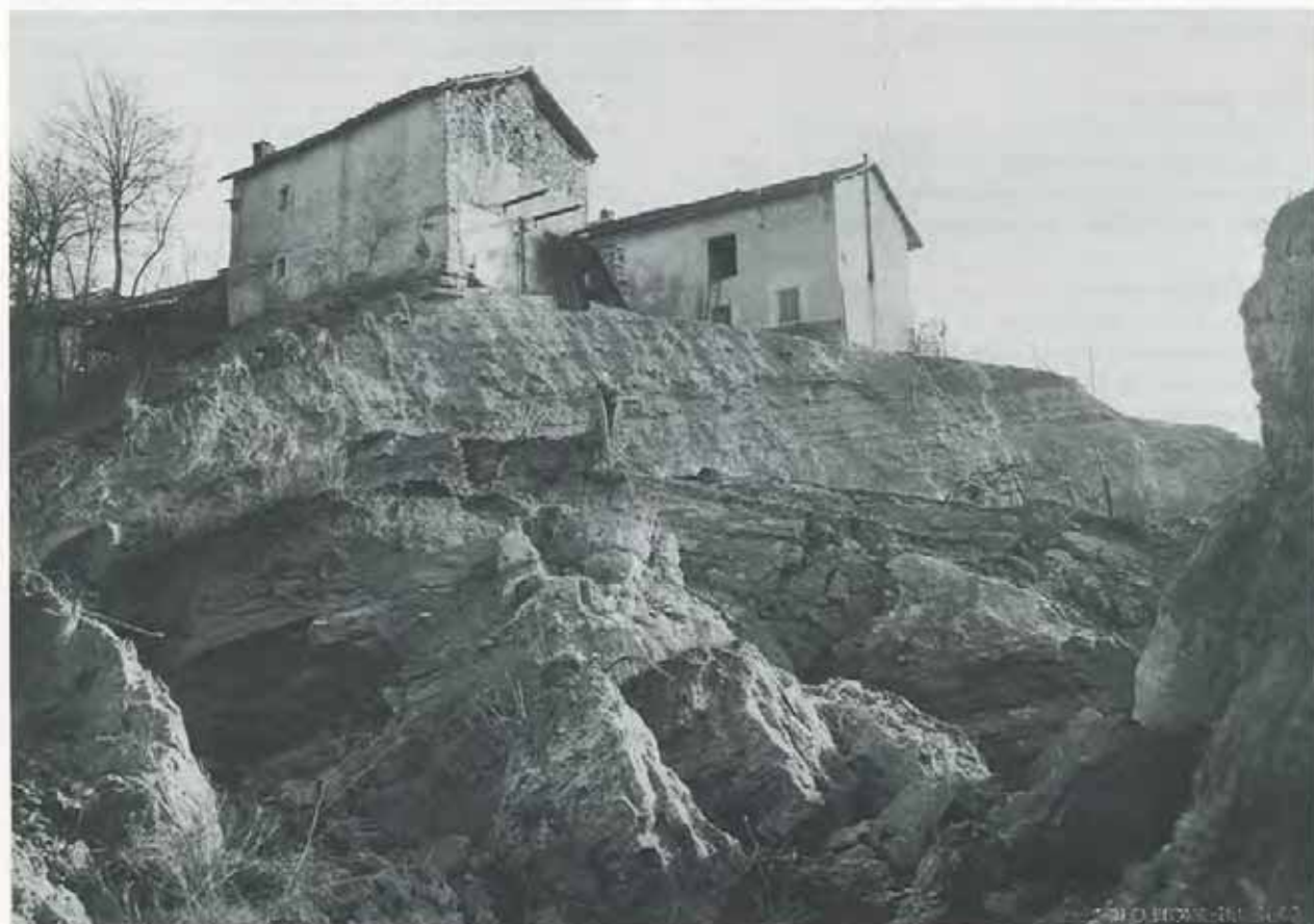
Fig. 3 - Particolare del fenomeno franoso del 1963 in zona di corona in fotografia dell'epoca. È distintamente visibile la struttura dell'affioramento di rocce sedimentarie di età terziaria poste a franapoggio e, a destra, parte di una zolla scivolata (Archivio C.N.R.-I.R.P.I. Torino).
