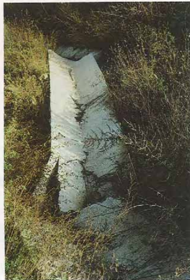
Fig. 7 - Particolare del vecchio corpo di frana. La canaletta in c.s., che attraversa obliquamente il versante franato nel 1963, è distrutta, nella sua parte media, da una parziale attivazione della porzione inferiore sinistra dell'accumulo.
