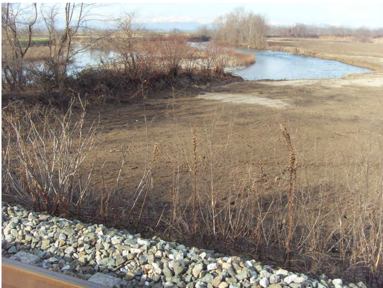
Foto 2 – Vista dalla ferrovia verso monte: erosione di aggiramento difesa spalla sx ponte e area allagata in prossimità del tombino
