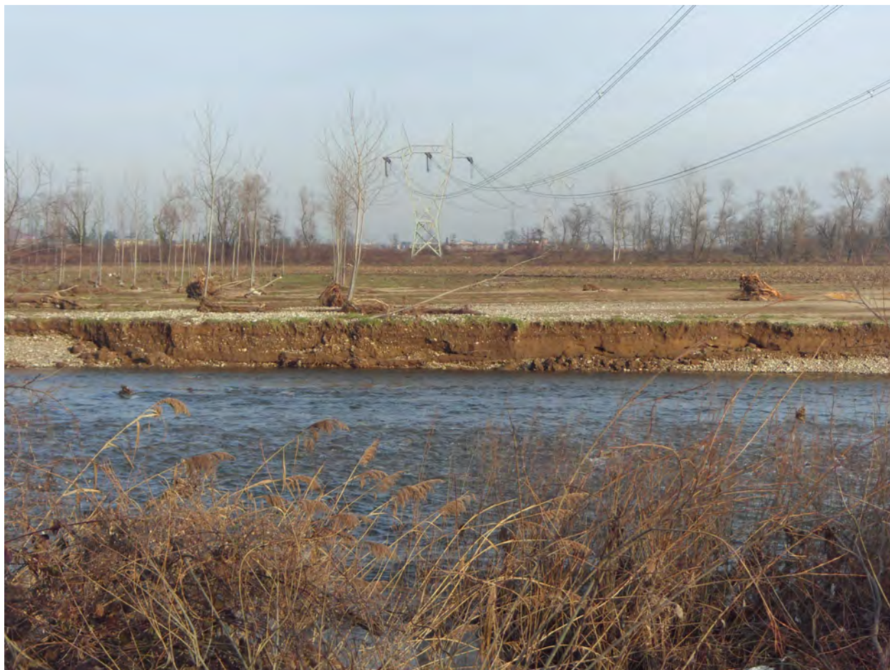
Foto 6 – Vista dell'erosione in sponda sx
