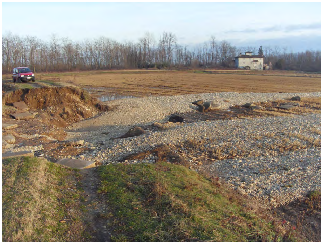
Foto 7 – Vista della rottura argine e sovrastante strada alzaia in direzione del mulino e del Canale Cavour
