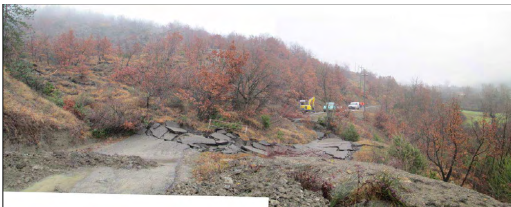
Figura 9 –Comune di Albera Ligure (AL); sede stradale completamente asportata
