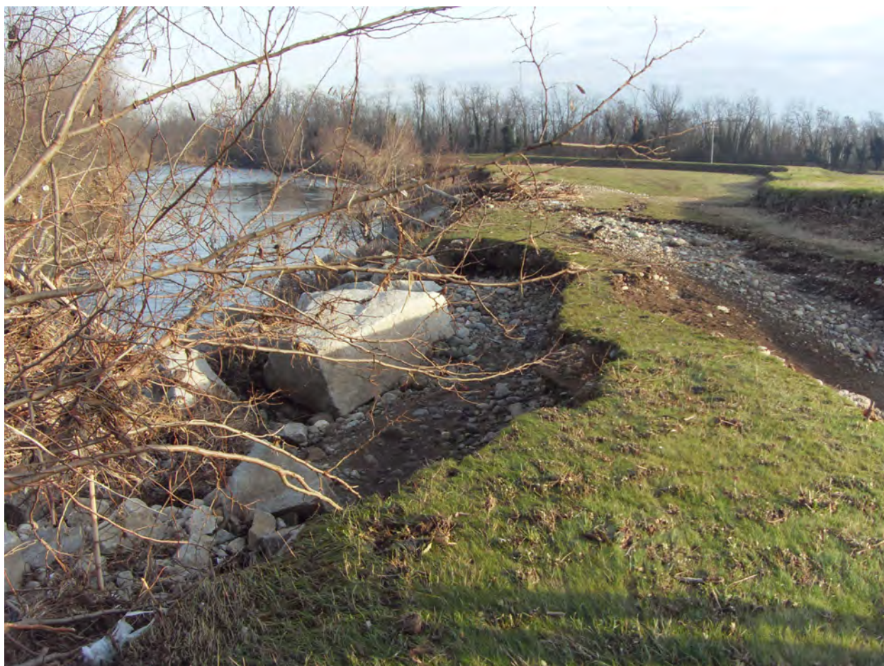
Foto 9 – Vista da monte in direzione della tenuta Camiano e del canale Cavour: erosione con crollo scogliera in massi ed esondazione in sponda dx Allegato 3 - TT. Agogna e Terdoppio (NO)
