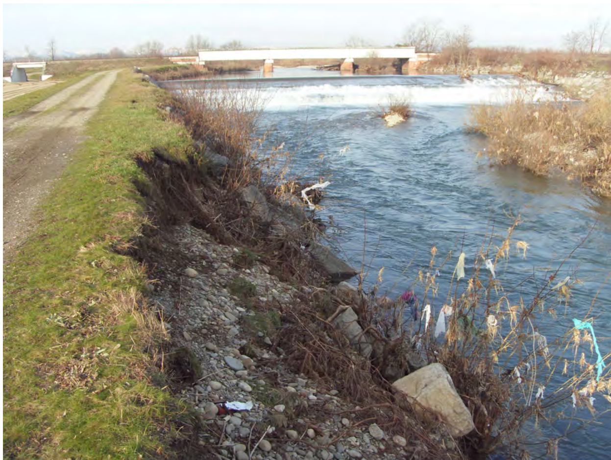
Foto 4 – Vista da valle verso ponte RFI: erosione e crollo scogliera in massi in sponda dx e presenza di vegetazione (prossimo intervento con squadre Forestali Regionali) ed accumulo inerti su lato sx Allegato 3 - TT. Agogna e Terdoppio (NO)
