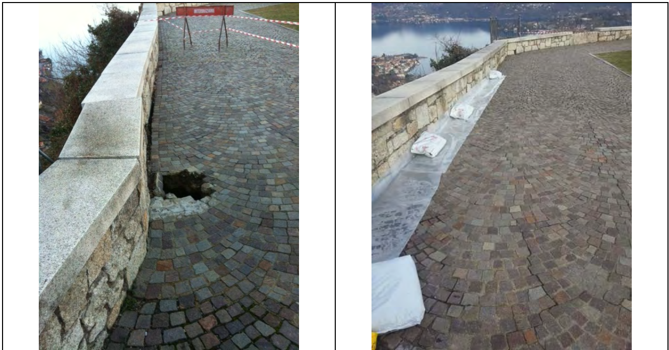
Figura 2 – Madonna del Sasso (VCO). Danni registrati sul piazzale del Santuario a seguito dell'evento meteo-pluviometrico del 25-26 dicembre 2013.
