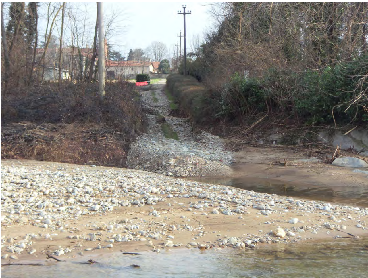
Foto 14 Dissesto attraversamento a guado verso cascina Mirasole.
