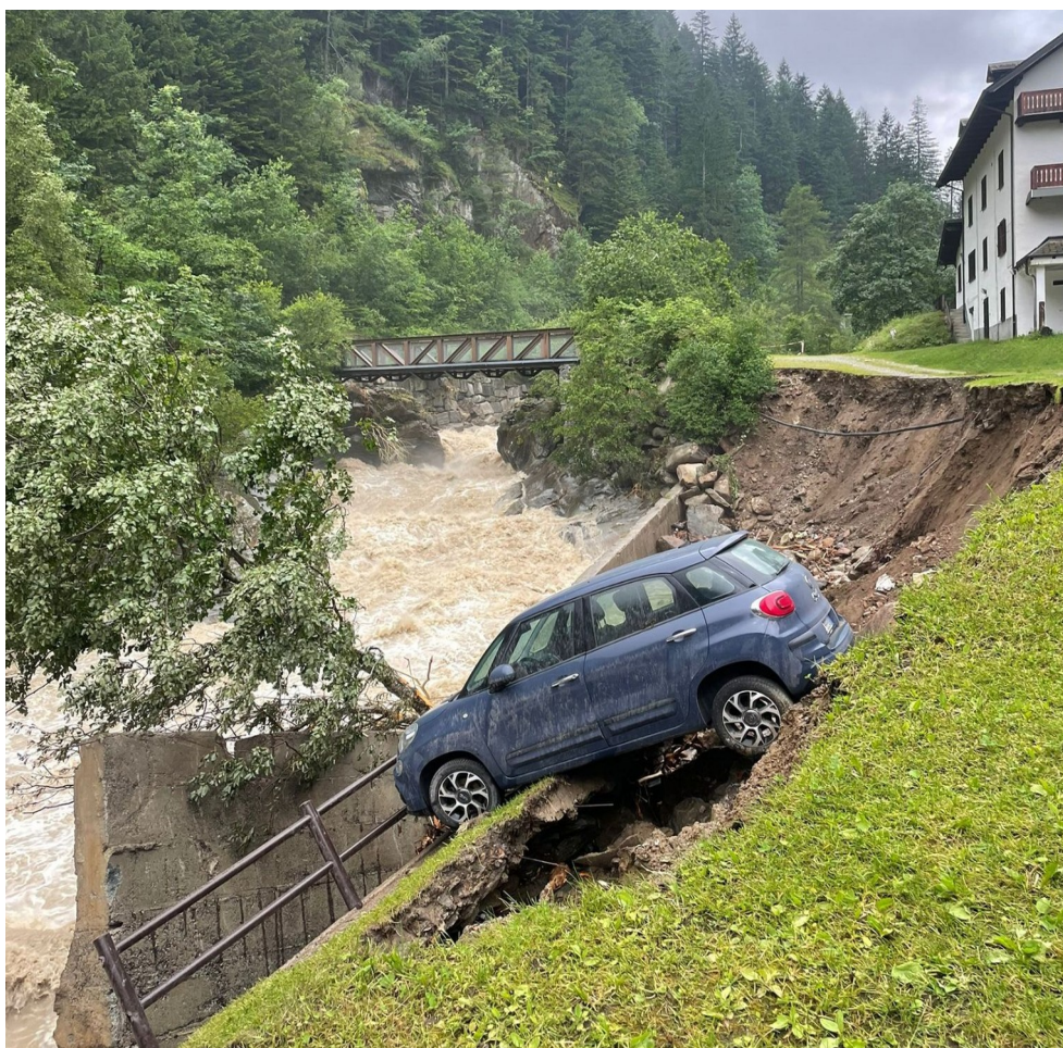
Figura 18. Erosione torrente Anza, località Pestarena Macugnaga. Fonte Regione Piemonte
