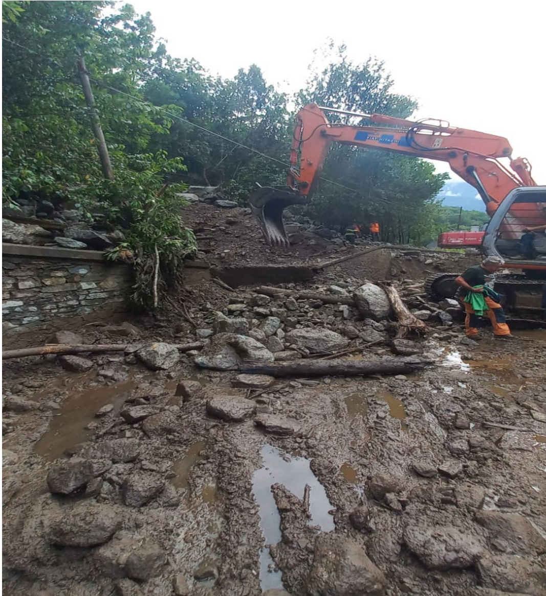
Figura 12. Frana in località Fornolosa – Locana (TO). Foto scattata domenica 30 giugno 2024 durante gli interventi di somma urgenza per la messa in sicurezza. Fonte Regione Piemonte
