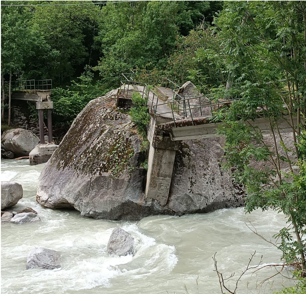
Figura 13. Passerella distrutta – Locana (TO) - Fonte Umberto Bado
