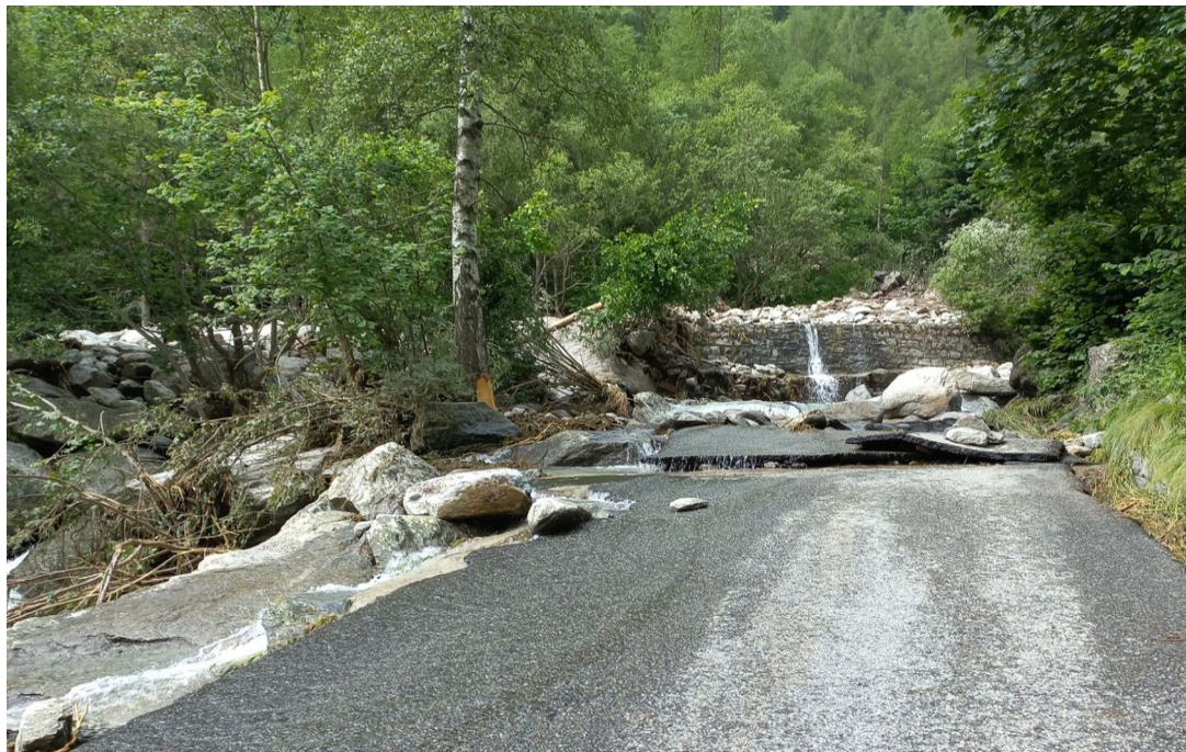
Figura 14. Tratto di viabilità danneggiato che conduce alla diga del Teleccio – Locana (TO). Fonte Regione Piemonte
