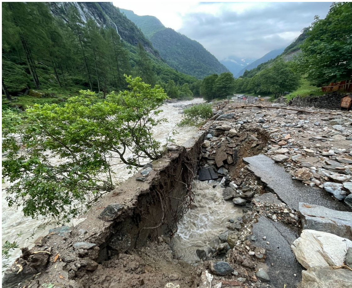
Figura 20. Danni sulla strada comunale Wold - Acqua Bianca. Fonte Comune di Alagna Valsesia
