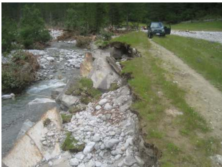
Asportazione di una tratta della scogliera in blocchi; l'intervento dovrà prevedere la ricostruzione della scogliera ed il ripristino del rilevato retrostante - tratta lunga 20.0 m, altezza da fondo alveo 3.50 m.
