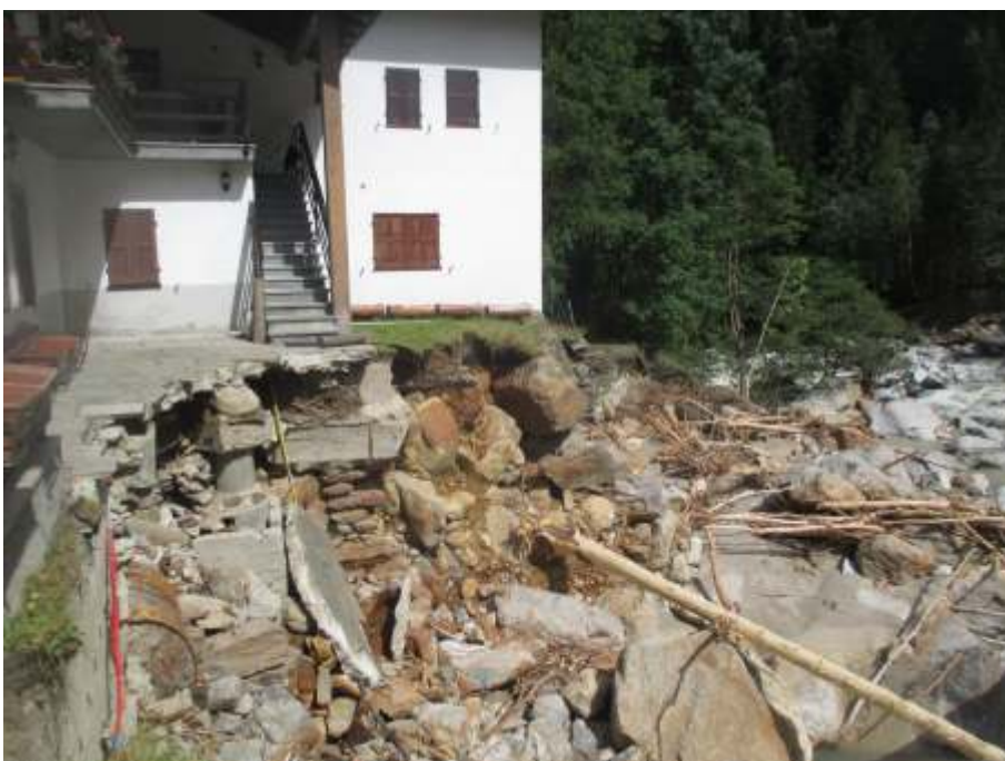
Stesso punto di ripresa di cui alla foto precedente, ruotato di 180°, con particolare della lunata di erosione che ha compromesso il latitante edificio residenziale, che dovrà essere protetto con una nuova opera di difesa (scogliera in blocchi di cava cementati ed ancorati con barre d'acciaio)
