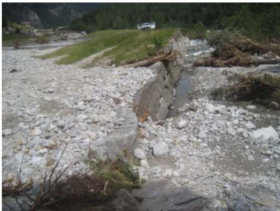
Veduta del rilevato a tergo della difesa spondale (scogliera in blocchi), alla cui sommità si sviluppa una porzione della strada carrabile, aggirato dall'esondazione del T. Quarazza
