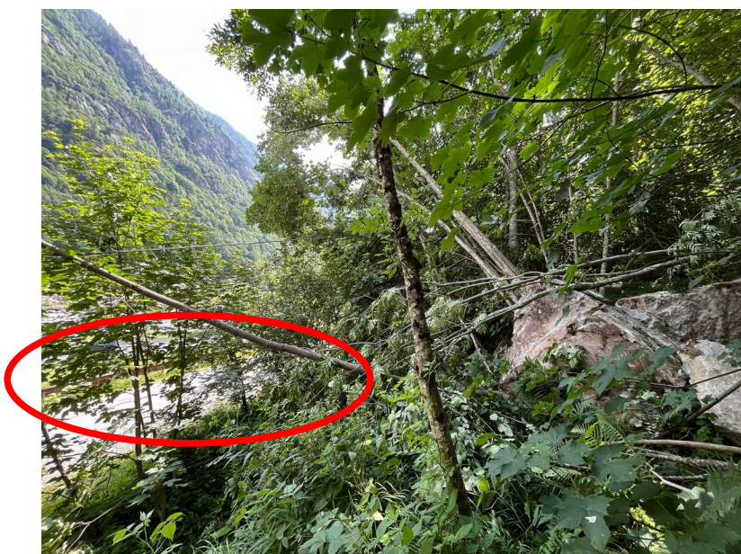
Materiale sciolto ai limiti del piede del versante (strada provinciale sottostante)
