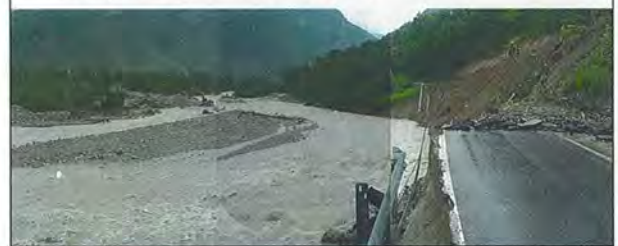
Figura 87 - Vinadio. Confluenza del rio Sant'Anna: tratto di strada asportato per erosione. (VD49)
