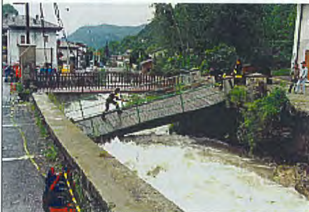
Figura 54 - Crissolo; P.za Umberto I. Rimozione dell'attraversamento crollato. (VP08)
