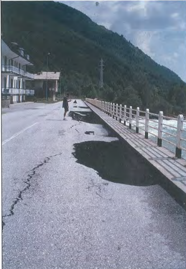
Figura 105 - Valdieri. Loc. S. Anna: danni alla SP 22 causati dal Torrente Gesso. (VG22)
