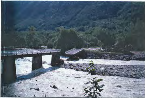
Figura 109 - Valdieri. Ponte nel concentrico semidistrutto ed erosione spondale. (VG27)
