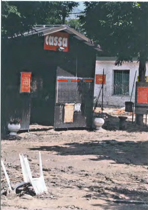
Altezza dell'acqua di inondazione nell'"area giochi" (tratteggio rosso); il materiale fine depositato ha raggiunto un'altezza massima di 40 cm
