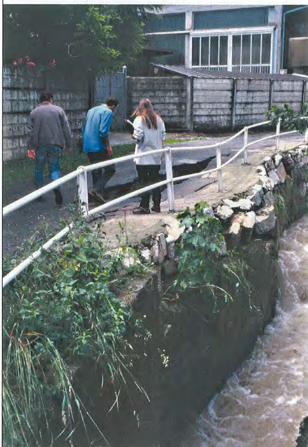
Figura 114 - Peveragno. Cedimento del muro di difesa e della strada comunale per erosione. (VJ13)
