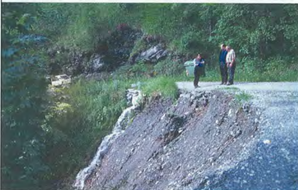
Figura 82 - Elva. Frana superficiale lungo la strada per la borgata Clari. (VM23)
