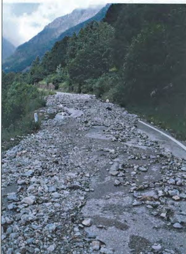
Figura 103 - Valdieri. Danni alla SP 22 all'attraversamento del rio Mondono. (VG16)
