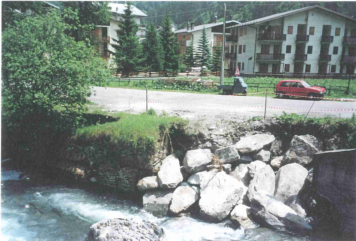
Foto 12d - Torrente Germanasca - Comune di Praly – Località Ghigo Nel concentrico immediatamente a valle di un ponticello, l'erosione spondale, amplificata dal blocco di muratura in alveo, ha causato il cedimento della scogliera in sponda destra.
