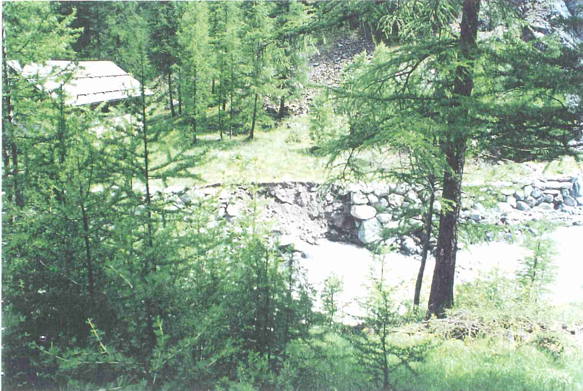
Foto 25c - Torrente Ripa - Comune di Sauze di Cesana – Val Argentera La piena ha asportato in destra idrografica, un tratto di scogliera (circa 10 m di lunghezza) poco a monte della Centrale Idroelettrica di località Giudigiai.
