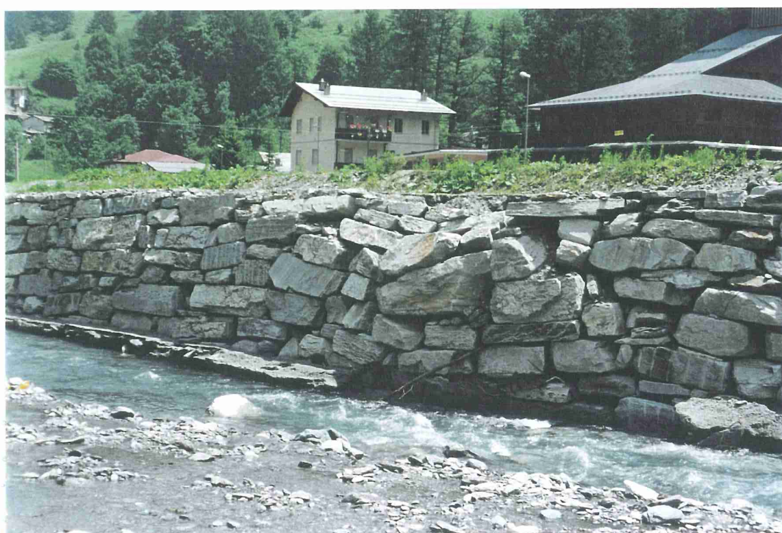
Foto 10d - Torrente Germanasca - Comune di Praly – Località Ghigo Presso la frazione Orgere, a monte del ponte distrutto, insiste una scogliera in sponda destra idrografica, il cui cordolo di fondazione in calcestruzzo è stato scalzato, causando un cedimento superficiale di circa 5 m.
