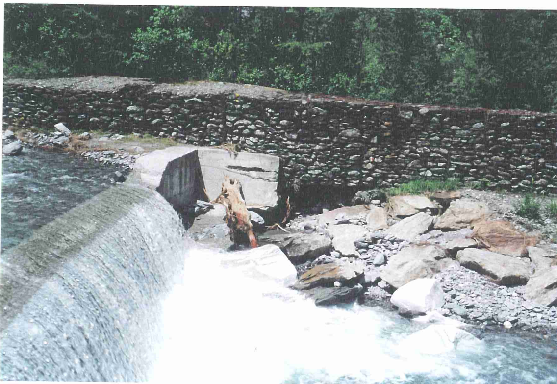
Foto 8d - Torrente Germanasca - Comune di Praly – Località Ghigo Poco a valle di frazione Giordano è stata realizzata una briglia (a valle di una confluenza), l'argine sinistro è costituito da una gabbionata (a protezione di un campeggio) scalzata per 2 m.
