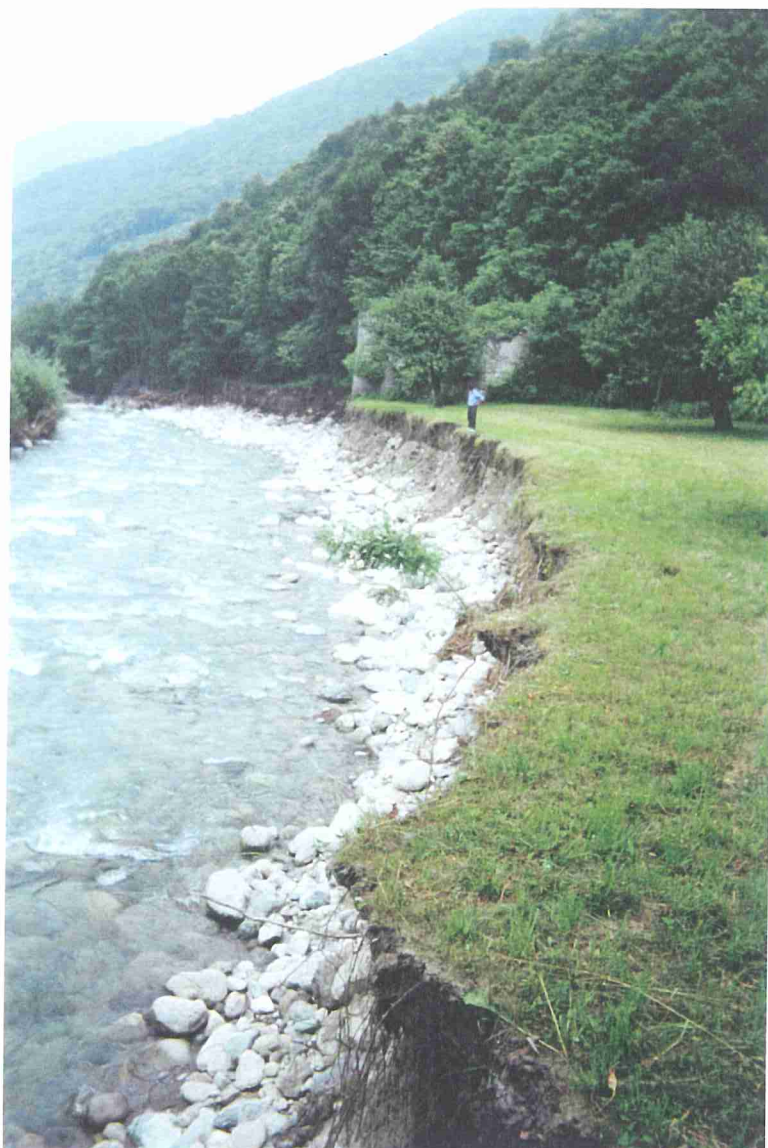
Foto 10 f - Torrente Pellice – Comune di Villar Pellice. Erosione in sponda destra del T. Pellice, a valle del ponte di Villar Pellice, per un tratto di circa 300 m con asportazione della sovrastante strada sterrata per un tratto di circa 30 m.
