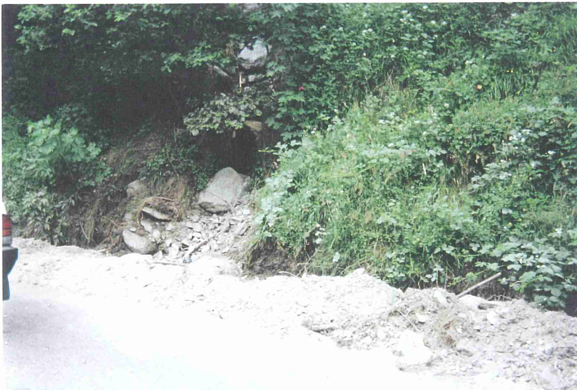
Foto 19f - Torrente Ghicciard – Bobbio Pellice – Comba dei Carbonieri. Strada per il Rifugio Barbara Lowrie a quota 904 m s.l.m. (in prossimità di Frazione Raimond): piccolo scarico di detriti sulla strada per l'occlusione della luce dell'attraversamento di un rio minore sul versante sinistro.
