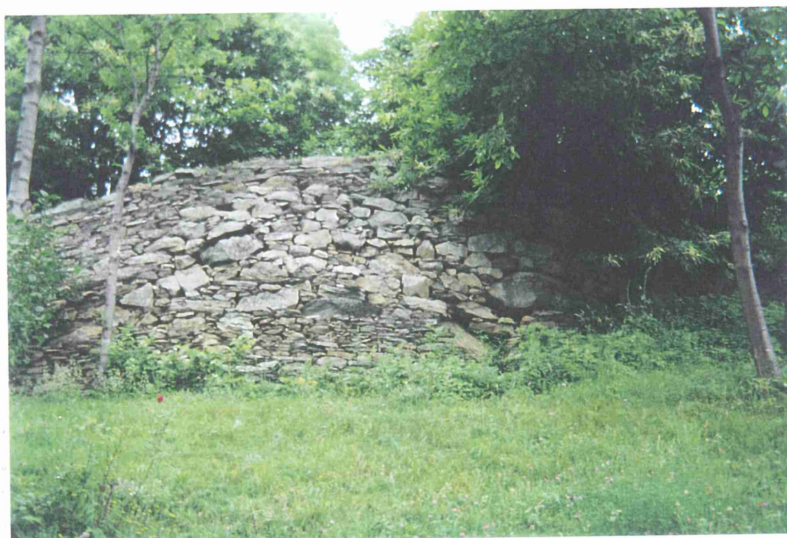
Foto 14f - Torrente Pellice – Villar Pellice. Lungo la SP 258 all'altezza di Località Muli, il muro di sostegno di valle della strada presenta lesioni e deformazioni.
