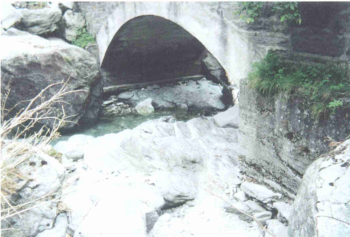
Foto 17f - Torrente Ghicciard – Bobbio Pellice – Comba dei Carbonieri. Strada per il Rifugio Barbara Lowrie a quota 1243 m s.l.m. (in prossimità di Località Prelapia): si notano le spalle del ponte per Prelapia parzialmente scalzate.
