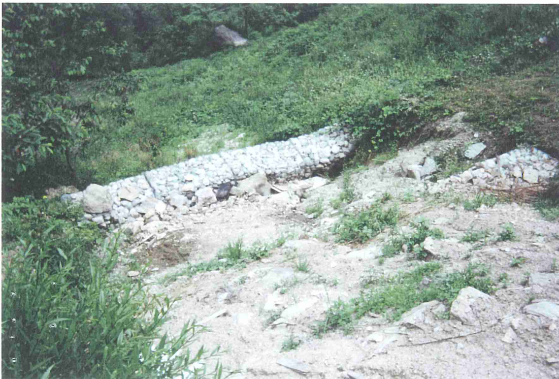
Foto 12f - Torrente Pellice – Villar Pellice. Lungo la SP 258 al km 3 + 250, tra Frazione Bodeina e Frazione Comba, blocchi e detriti sulle gabbionate per una frana già presente.
