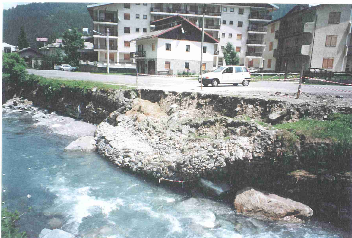
Foto 13d - Torrente Germanasca - Comune di Praly – Località Ghigo Nel concentrico immediatamente a valle di una pedanca, l'erosione spondale, ha scalzato e ribaltato in sponda destra circa 10 m di gabbionate.
