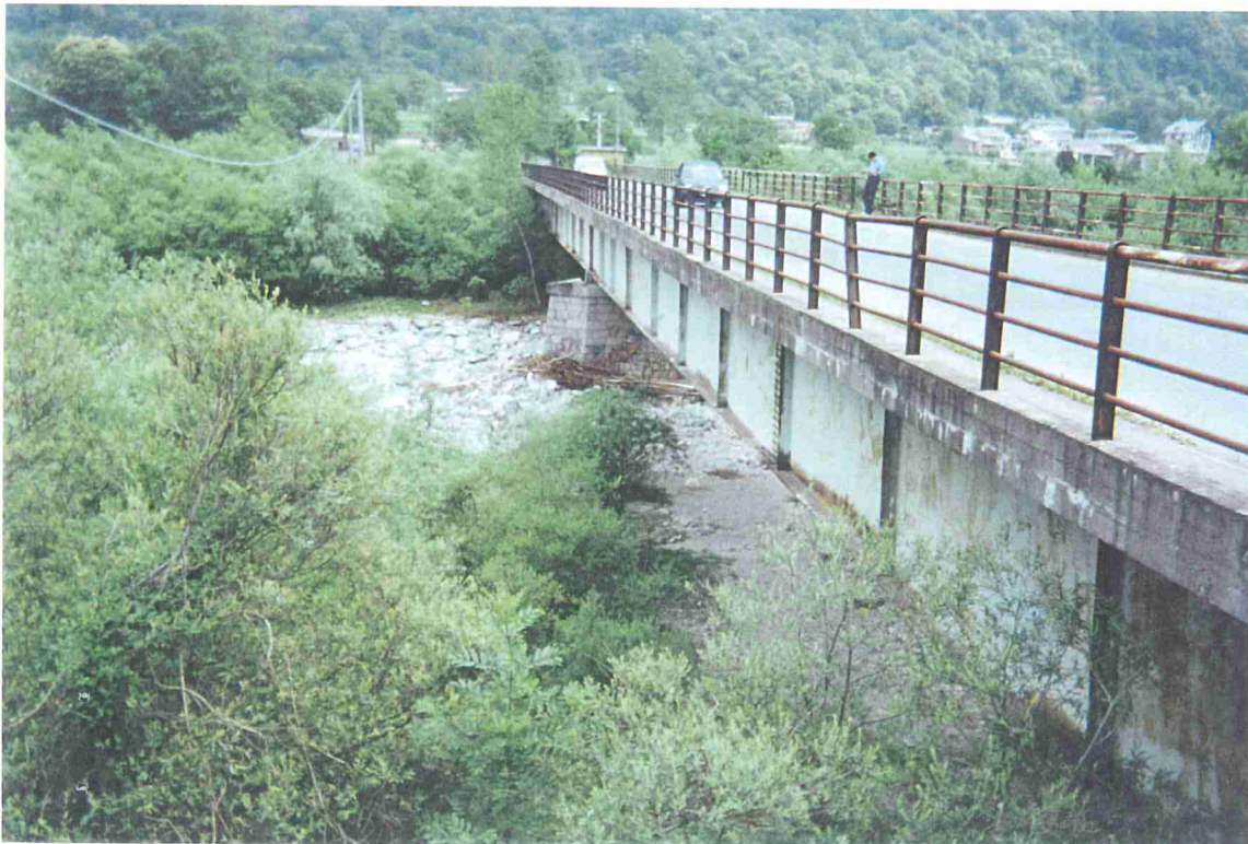
Foto 24f - Torrente Pellice – Villar Pellice. Ponte sul T. Pellice, a valle del concentratore, a servizio della strada per Frazione Buffa: accumulo a monte della pila in alveo e trasporto solido.
