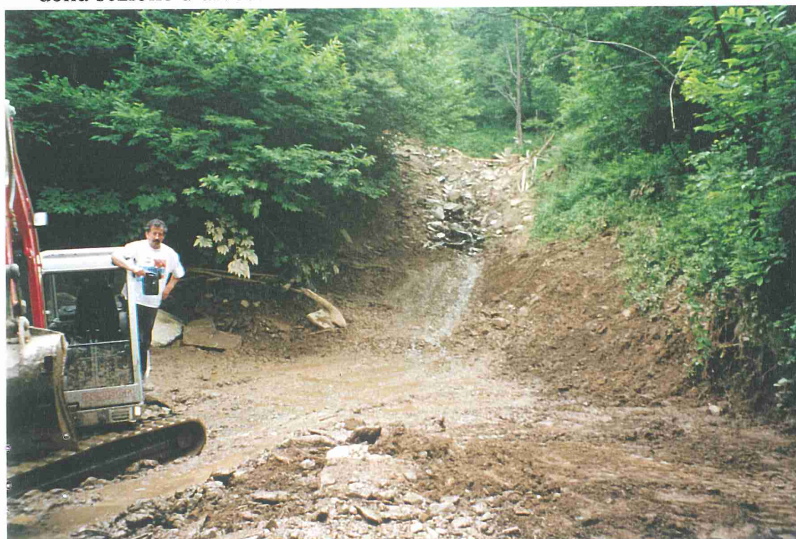
Foto 10e – Torrente Luserna – Comune di Luserna S. Giovanni. In corrispondenza dell'attraversamento di un rio minore (confluente del T. Luserna in prossimità del limite orientale della frazione Fenoglio), da parte della strada sterrata per Tribolotto (quota 700 m.), una colata detritica torrentizia ha occupato completamente la strada con detrito grossolano e ghiaioso – limoso.
