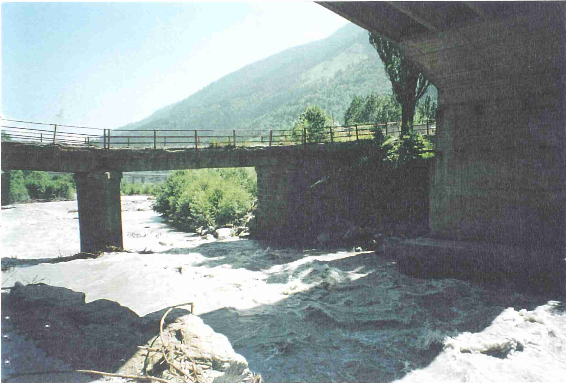
Foto 15b - Fiume Dora Riparia - Comune di Salbertrand - Concentrico Ponte Martinetto Vecchio, cedimento della pila centrale (scalzata e ruotata) e restringimento dell'alveo con gabbionate in spalla destra; pila del ponte Martinetto Nuovo con il basamento di fondazione in parte sottoescavato.
