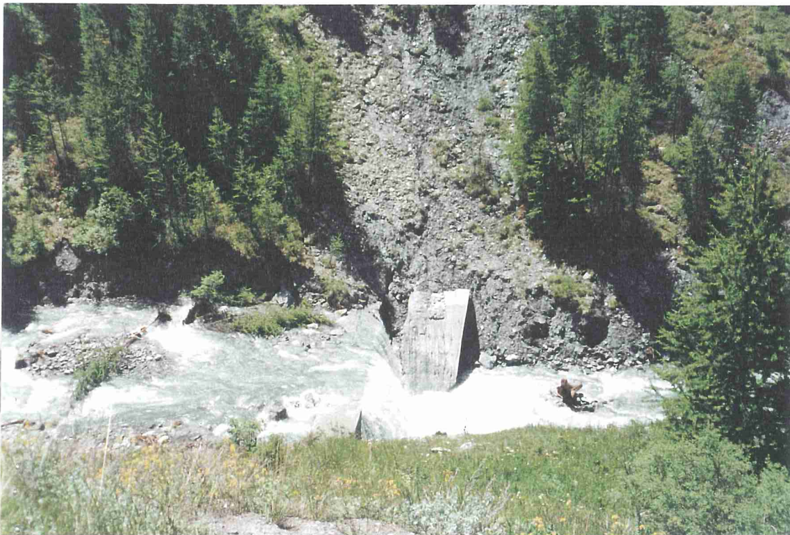
Foto 4a - Torrente Thuras - Comune di Cesana T.se A valle di Rhuilles briglia lesionata con spalla sinistra parzialmente traslata (quota 1680 m)
