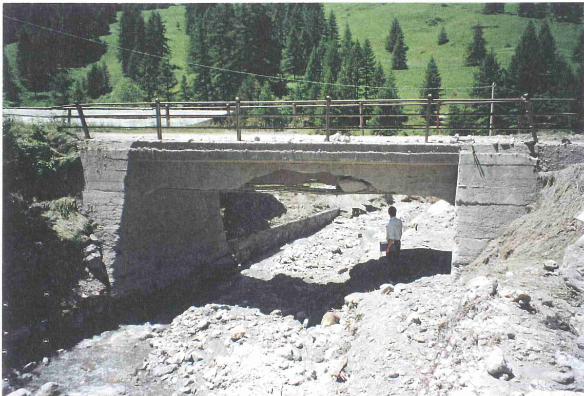
Foto 7a - Torrente Thurax - Comune di Cesana T.se - Frazione Rhuilles Rio Saint (Vallone Draia), ponte a servizio della strada ex militare per Thurax. Si può notare il sormonto del ponte da parte della piena e le travi gravemente danneggiate.
