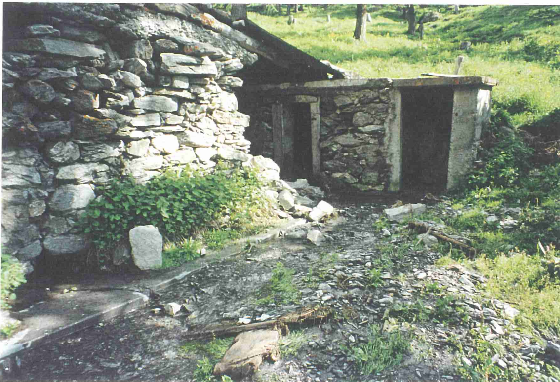
Foto 5b - Torrente Thuras - Comune di Cesana T.se – Località Berengie Caserme riattate per uso agricolo presso ponte Ciatagnera. Un lembo di una colata detritica torrentizia, proveniente da un rio affluente di sinistra del T. Thuras, ha investito ed attraversato un edificio (vista da valle).
