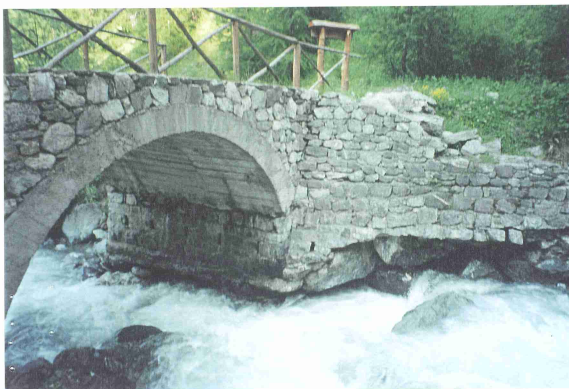
Foto 9b - Torrente Thuras - Comune di Cesana T.se – Località Argano Ai piedi di Cima Alberon (quota 1740 m) spalla destra del ponte vista da monte; sottoescavazione della spalla e del muro d'ala della stessa.
