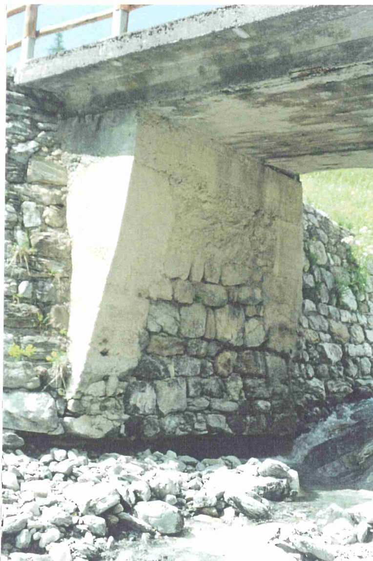
Foto 22a - Torrente Thuras - Comune di Cesana T.se – Rio della Musia Il ponte della ex strada militare risulta scalzato in spalla destra; le travi di monte per circa 1 m hanno subito una lieve rotazione, per cui risultano staccate dalle spalle.
