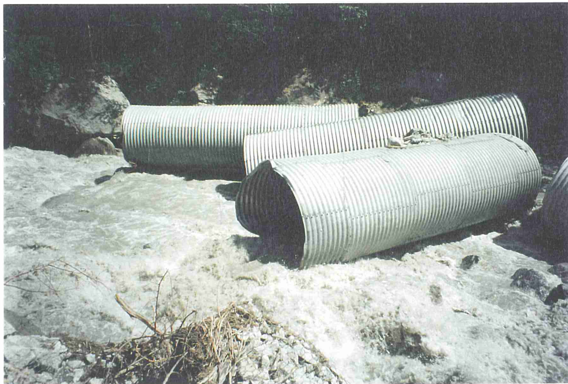
Foto 20b - Fiume Dora Riparia - Comune di Salbertrand – Località Serre La Voute Gli effetti della piena della Dora nel cantiere della Comunità Montana Alta Val Susa a monte della condotta forzata AEM presso località Sapè, Finsider trascinati in alveo a valle del cantiere; in basso, al centro della foto, sono visibili gabbionate scalzate e ribaltate.
