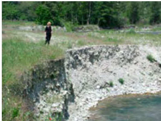
Torrente Staffora – Erosione spondale
