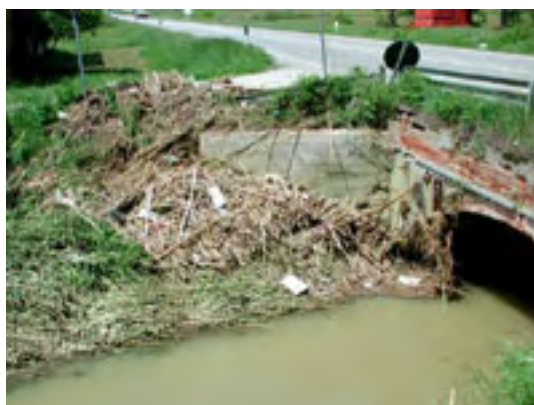
Torrente Rotaldo – Attraversamento della S.S. n. 31 "del Monferrato". Accumulo di detriti di varia natura responsabili dell'ostruzione del sottopasso
