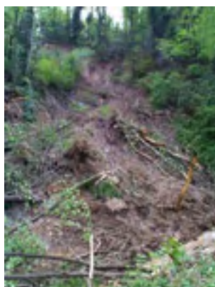
Riattivazione della frana sul versante destro della forra del rio Colorio. (foto Claudio Viviani)
