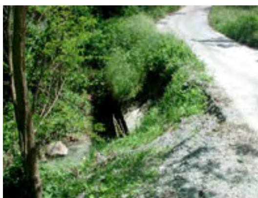
Rio di Basi (o rio Bazzi) - Fenomeni di erosione spondale sul rio di Basi danneggiano strutturalmente l'attraversamento della strada comunale Bozzola Scorticata, probabilmente anche a causa della insufficiente sezione dell'opera
