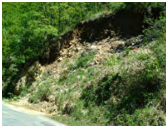
Particolare del dissesto della foto precedente
