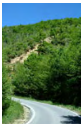
Esempio dei dissesti per colata della copertura superficiale diffusi lungo la scarpata di monte della S. P. n° 165, la maggioranza dei quali sono per lo più evoluzioni di fenomeni pregressi
