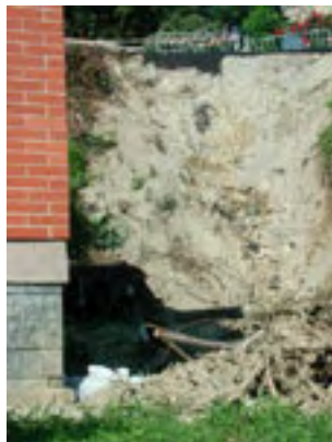
Capoluogo, Via Mazzini – Frana per mobilizzazione della copertura superficiale
