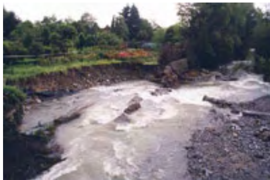
Sponda sinistra torrente Erno - Sifonamento del muro di sponda con aggiramento ed erosione spondale. (foto Alfredo Visentini, maggio 2002)
