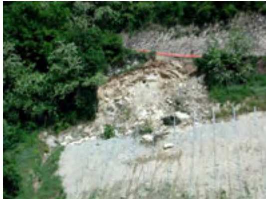
Strada comunale Moglia-S. Quirico. Fenomeno di crollo a valle della strada comunale, con danno strutturale alla stessa; la strada è impostata a mezza costa, su un ripido versante in calcareniti massicce molto fratturate. Alla base un materasso detritico coltivato a vigneto
