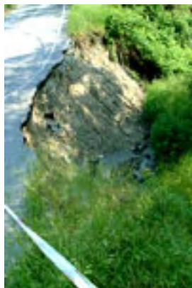
Case Setteventi - Colamento della coltre superficiale lungo la scarpata di valle della strada comunale Setteventi con asportazione di parte della carreggiata
