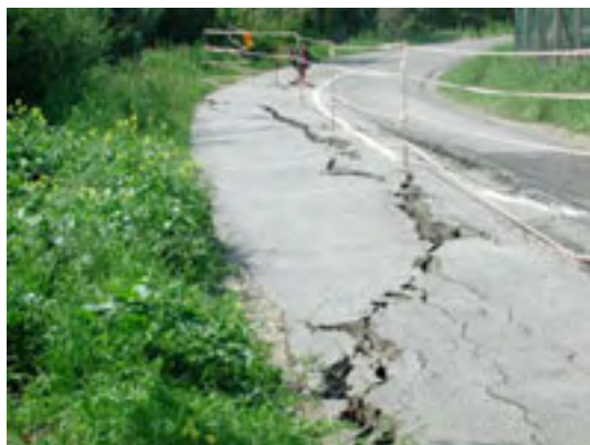
Strada comunale Avallano - Movimento franoso incipiente per mobilitazione della copertura superficiale
