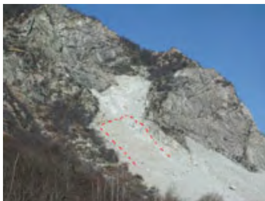
Autostrada A26 - La linea rossa tratteggiata indica il coronamento della frana accaduta l'8 luglio 1996 che si è riattivata con un consistente allargamento il 3 maggio 2002. Parte del materiale detritico franato ha raggiunto l'autostrada
