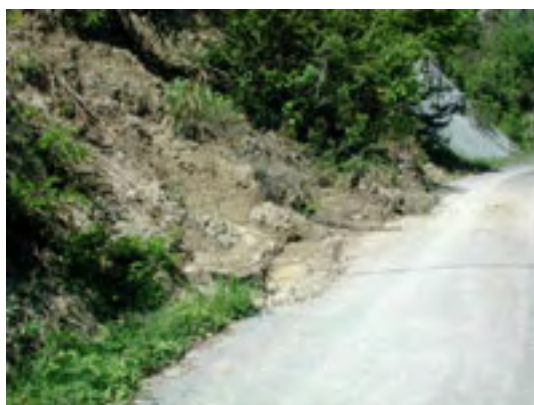
Strada comunale Bozzola Scorticata - Colata di coltre detritica superficiale, di potenza metrica, innescatasi a causa dell'erosione superficiale a margine di un pendio calanchivo
