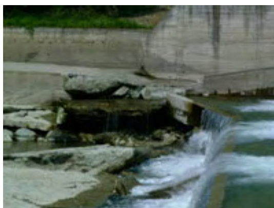
S.P. n° 170 - Ponte sul torrente Stura. Particolare dell'erosione relativa alla traversa di derivazione idroelettrica
