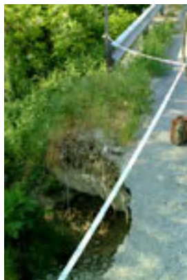
Case Setteventi - Vista del sottoescavamento della soletta a sbalzo precedentemente messa in opera per un fenomeno analogo
