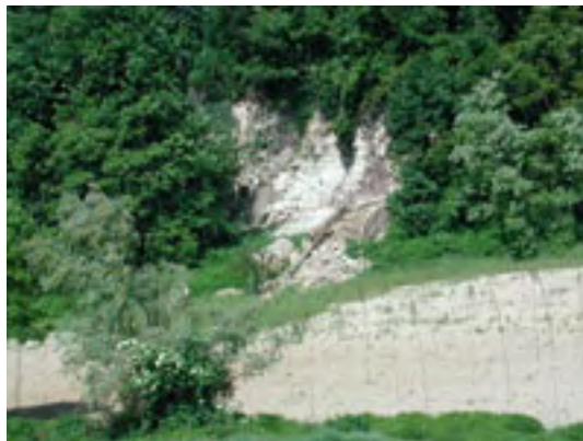
Strada comunale Moglia-S. Quirico. Fenomeno di crollo adiacente a quello verificatosi lungo la strada comunale, ma verificatosi su una parete naturale senza arrecare danni a manufatti
