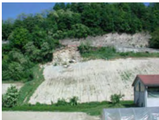
Fenomeno di crollo a valle della strada comunale; il materiale franato si è attestato sul sottostante materasso detritico che ne ha impedito il rimbalzo ed il rotolamento a valle
