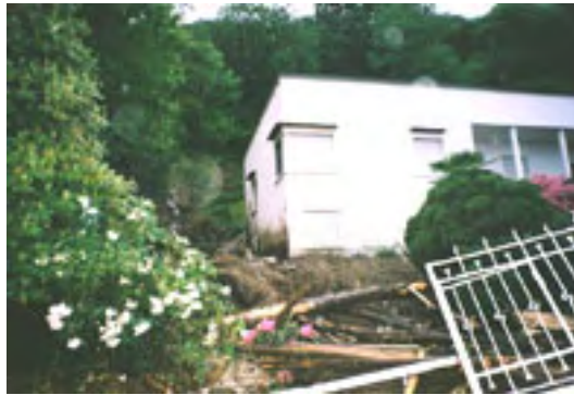
Il fenomeno di sfiancamento lungo la strada comunale di collegamento per il campo sportivo
