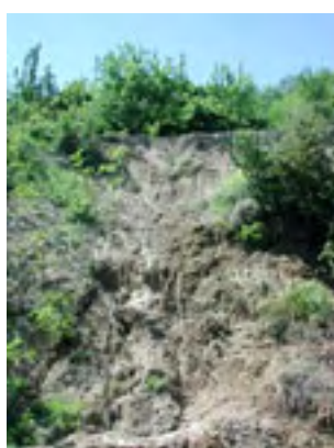
Strada comunale Bozzola Scorticata - Vista della nicchia della colata di coltre detritica superficiale, di potenza metrica, innescatasi a causa dell'erosione superficiale a margine di un pendio calanchivo
