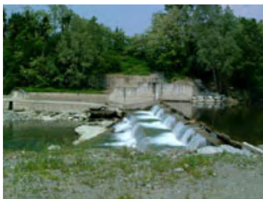
S.P. n° 170 – Ponte sul torrente Stura erosione della traversa di derivazione idroelettrica sul torrente Stura
