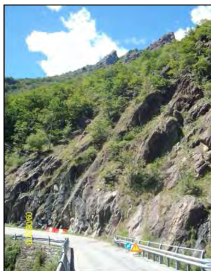
Crollo lungo la SP 1 a Ceres (TO). A sinistra il punto del crollo; a destra il settore stradale interessato dal crollo (fotografia fornita dall'Amministrazione Provinciale di Torino)
