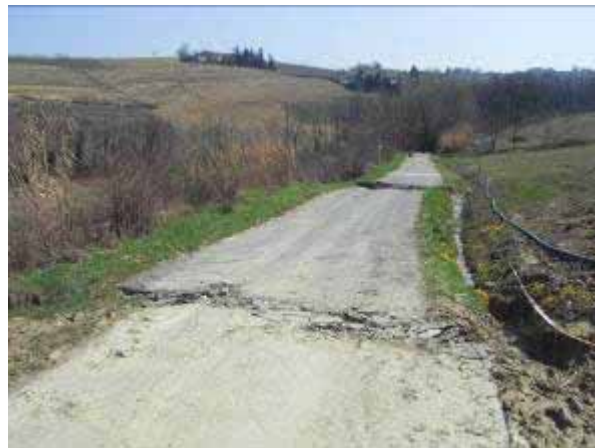
strada Baglio - Danni all'acquedotto
