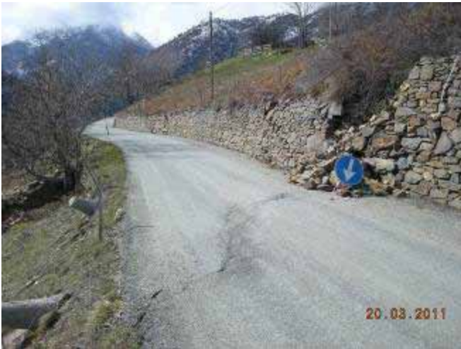
Maniglia-Baissa; Fessura a monte del tempio Baissa
