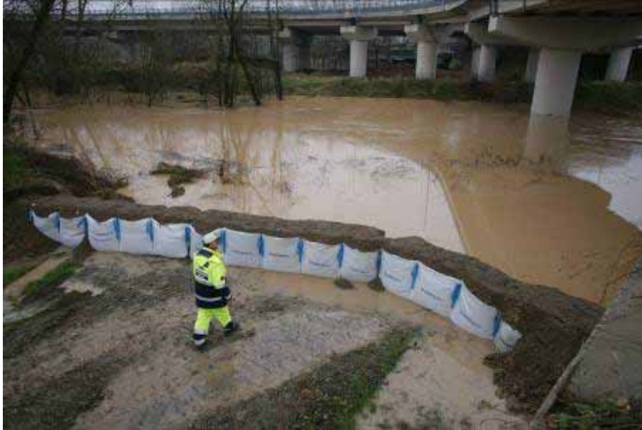
Posa di barriera big-bag in sponda sx del rio Loreto, nei pressi dell'ex-area cantiere della nuova tangenziale di Alessandria.
