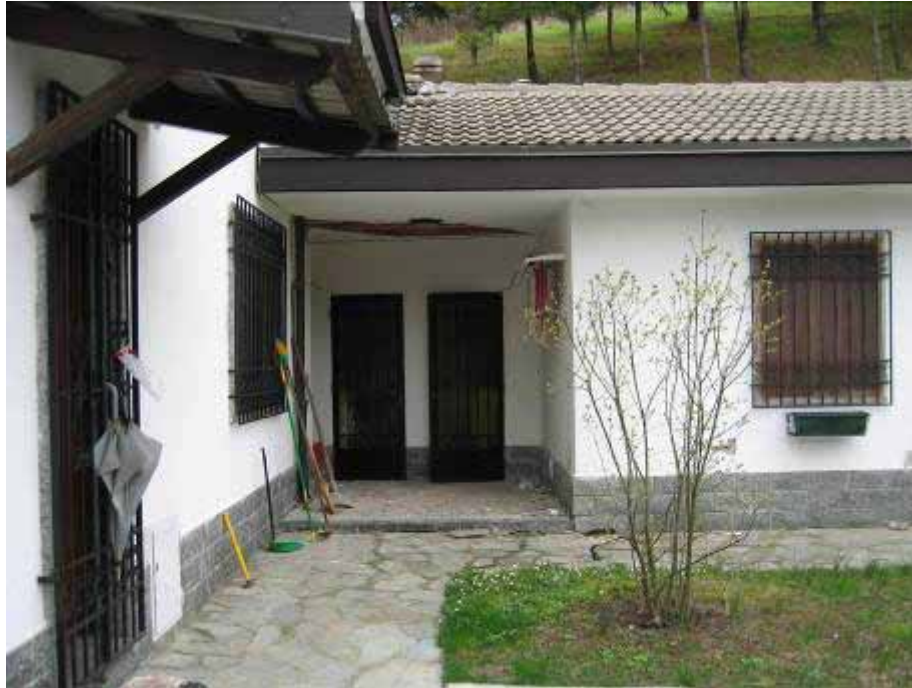
San Raffaele Cimena, via Casassa 5. Ala dell'edificio, ad un solo piano, fortemente danneggiata.
