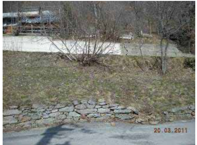
Maniglia Baissa; Fessura lato piazzale di Serre e lesioni muri strada per Saretto
