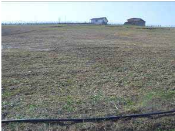
Fenomeno franoso a monte di strada Baglio – Fessure sul terreno
