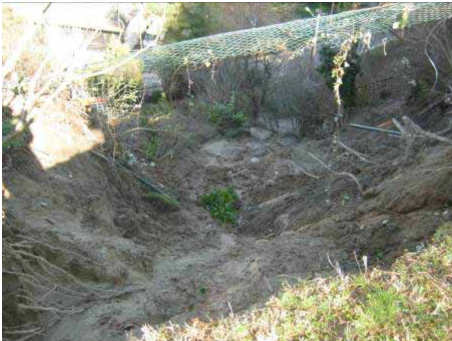
San Mauro T.se, via Rivodora 65. Tubazioni divelte dal fenomeno.
