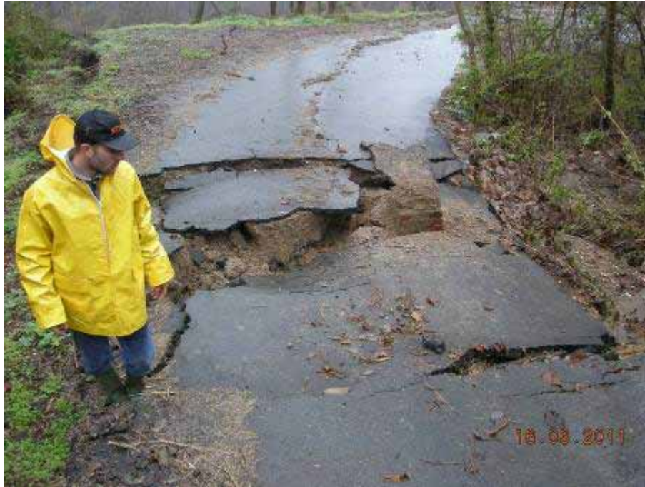
Danni al piano viario conseguenti la frana in strada Guardia
