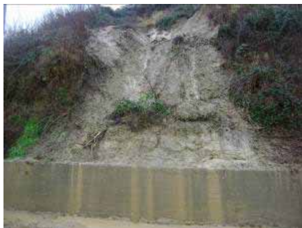
Montaldo scarampi - Frana lungo una strada comunale nei pressi del concentrico
