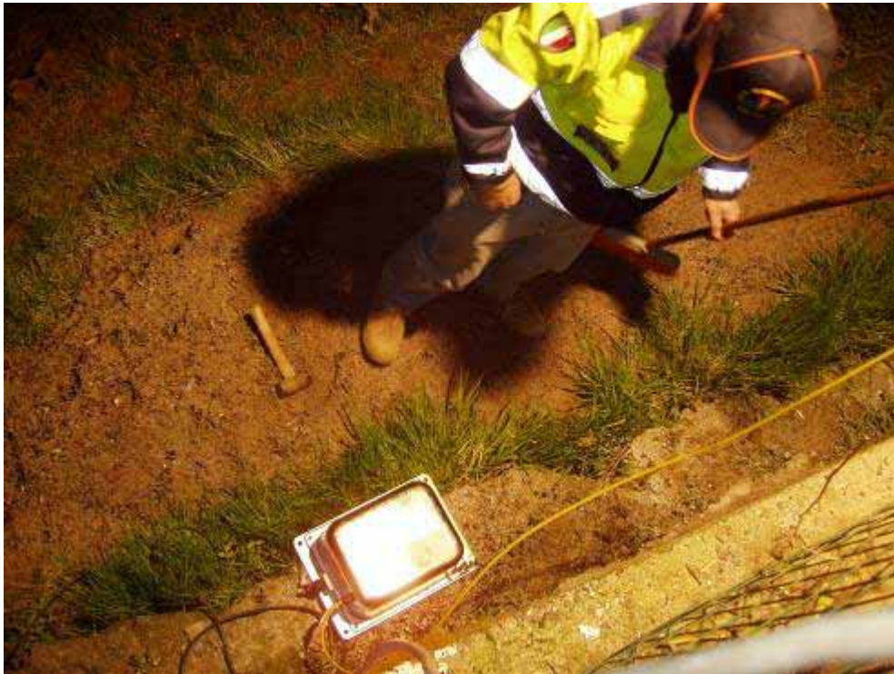
Punto di installazione dell'estensimetro a filo
