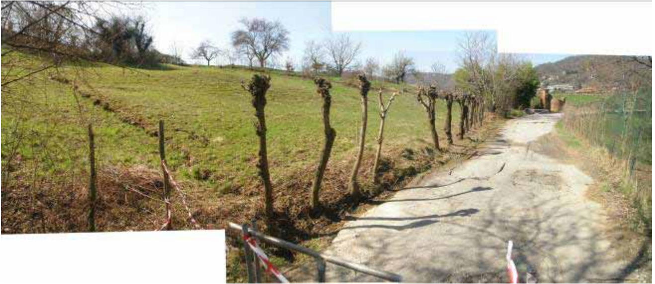
Pecetto Torinese via Ciattalina, strada lesionata e frattura lungo la spalla destra della frana (a destra nella fotografia)
