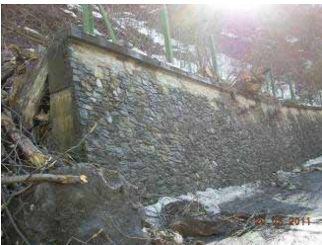
Danni al muro di contenimento – vista da valle
