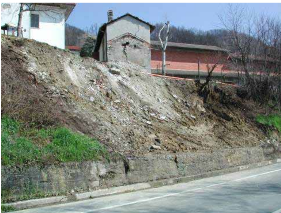
Ponti (AL) - edificio abbattuto a seguito di una frana lungo la ex S.S.30
