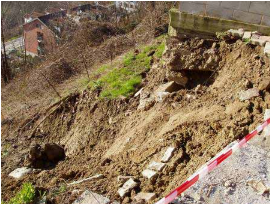
Coronamento della frana. Si nota l'interessamento della civile abitazione di via Fasella 16.
