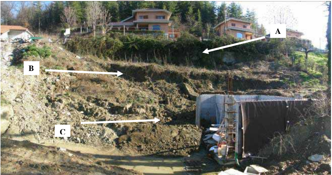
Pino Torinese, via Susa 6. In alto (A) il muro di contenimento lesionato a monte del quale si trova il tratto stradale di cui alla foto precedente. Al centro (B) il fronte di scavo parzialmente crollato nel corso delle piogge. In basso (C) il materiale franato ha raggiunto l'edificio in costruzione
