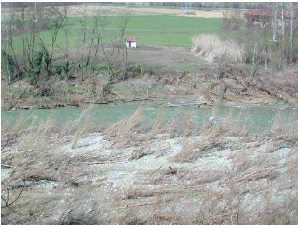
Bistagno (AL) - erosioni spondali e di fondo sulla Bormida evidenziano il substrato roccioso
