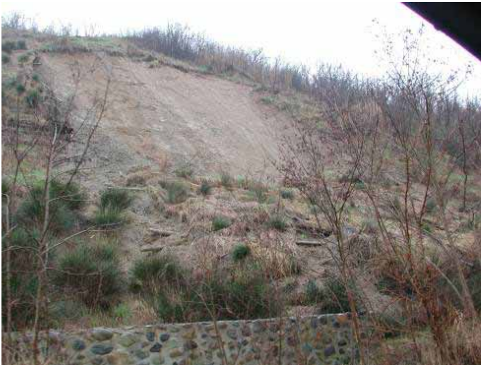
Montecastello (AL) - riattivazioni con franamento degli interventi di ingegneria naturalistica alla Frana delle Rocche.
