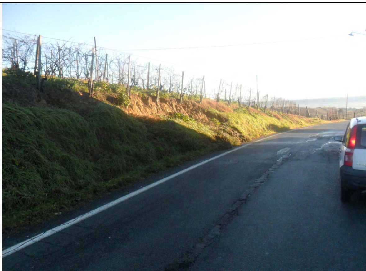
SP 233 “delle Rocche” km 0+700 sx n° 1
