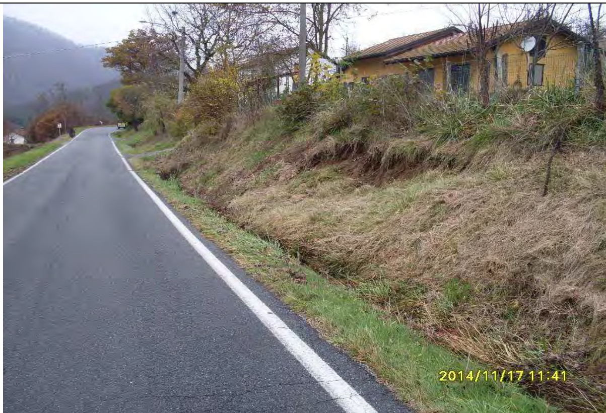
SP 215 "Spigno-Pareto" km 4+550 sx n° 1
