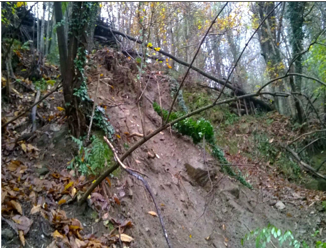
SP 456 “del Turchino” dal km 72+600 al km 72+750 foto n° 3b
