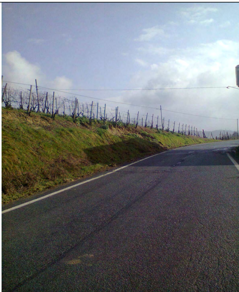
SP 233 “delle Rocche” km 1+050 sx n° 1
