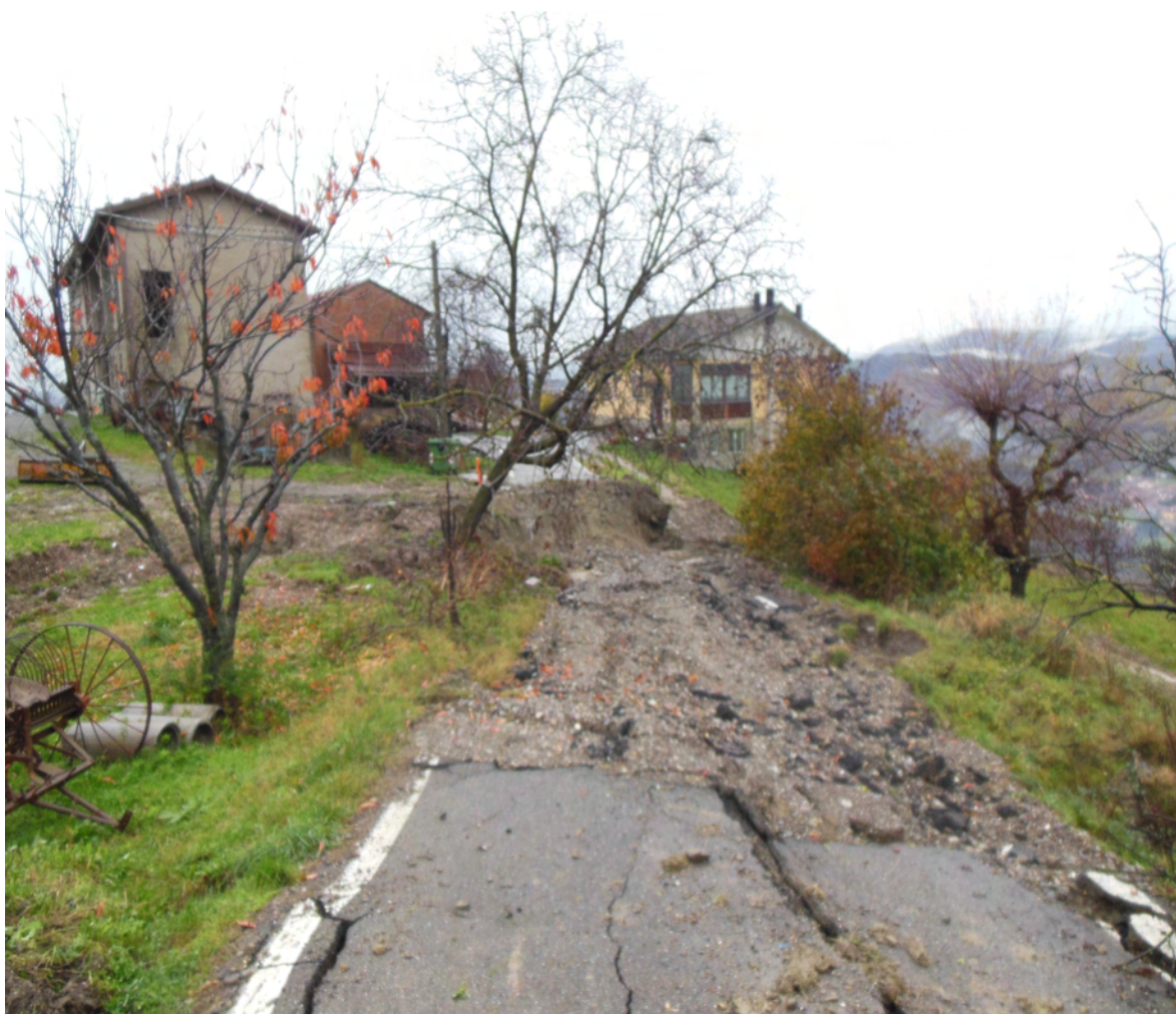
Sp 137“ Garbagna - Bastita” frana dal km 2+750 al km 2+800 foto n° 2
