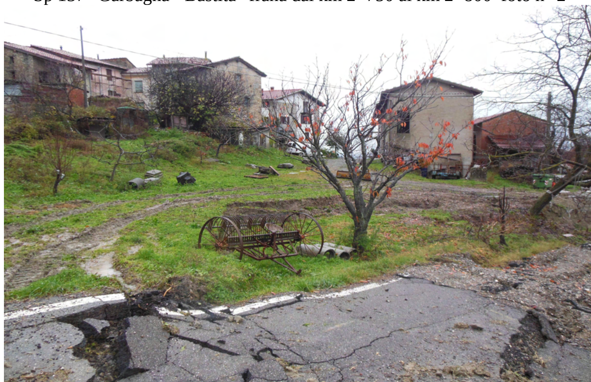
Sp 137“ Garbagna - Bastita” frana dal km 2+750 al km 2+800 foto n° 3
