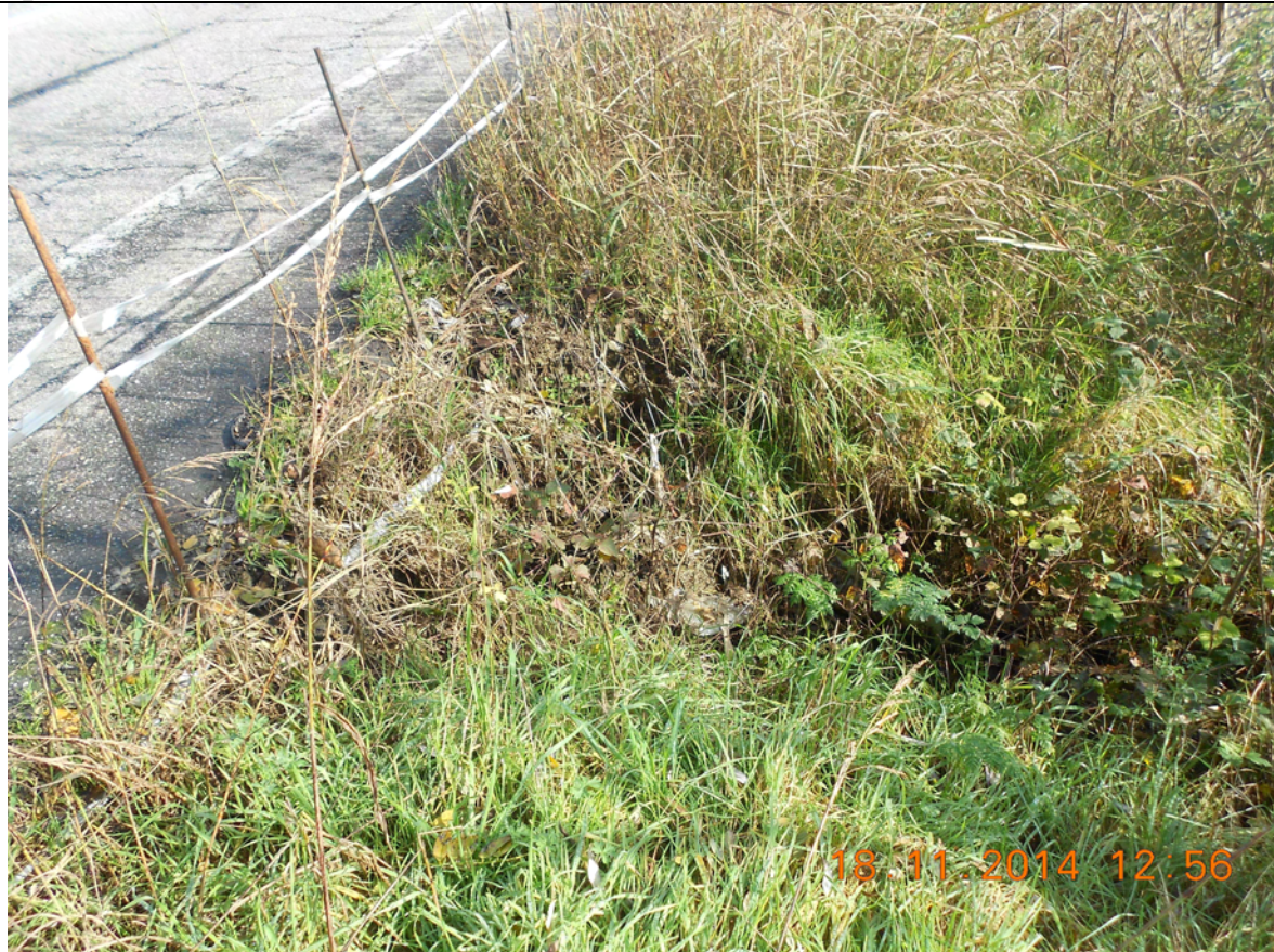
Sp10 "Padana Inferiore" frana scarpata dal km 84+770 al km 84+920 foto n° 2
