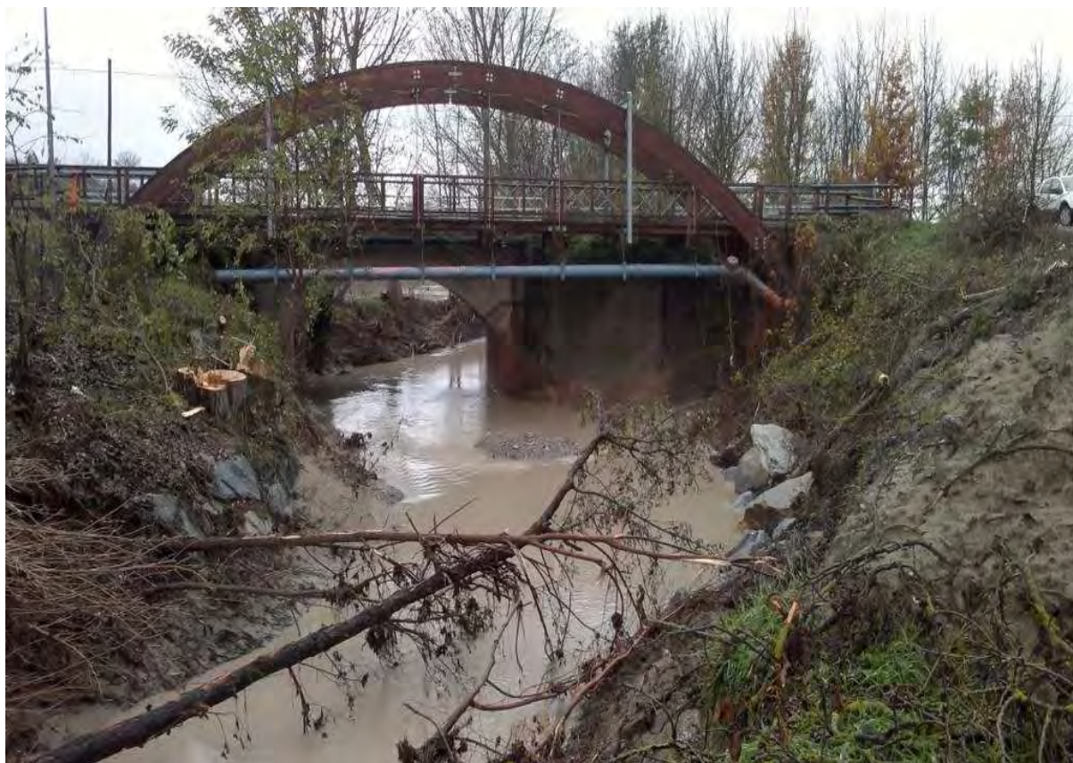
Sp 130 “della Valle Ossona” km 8+300 foto n° 1
