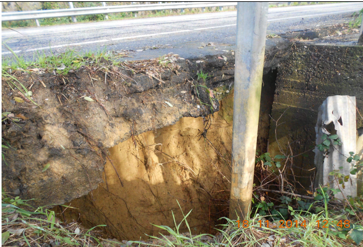
Sp10 "Padana Inferiore" frana scarpata dal km 84+770 al km 84+920 foto n° 1
