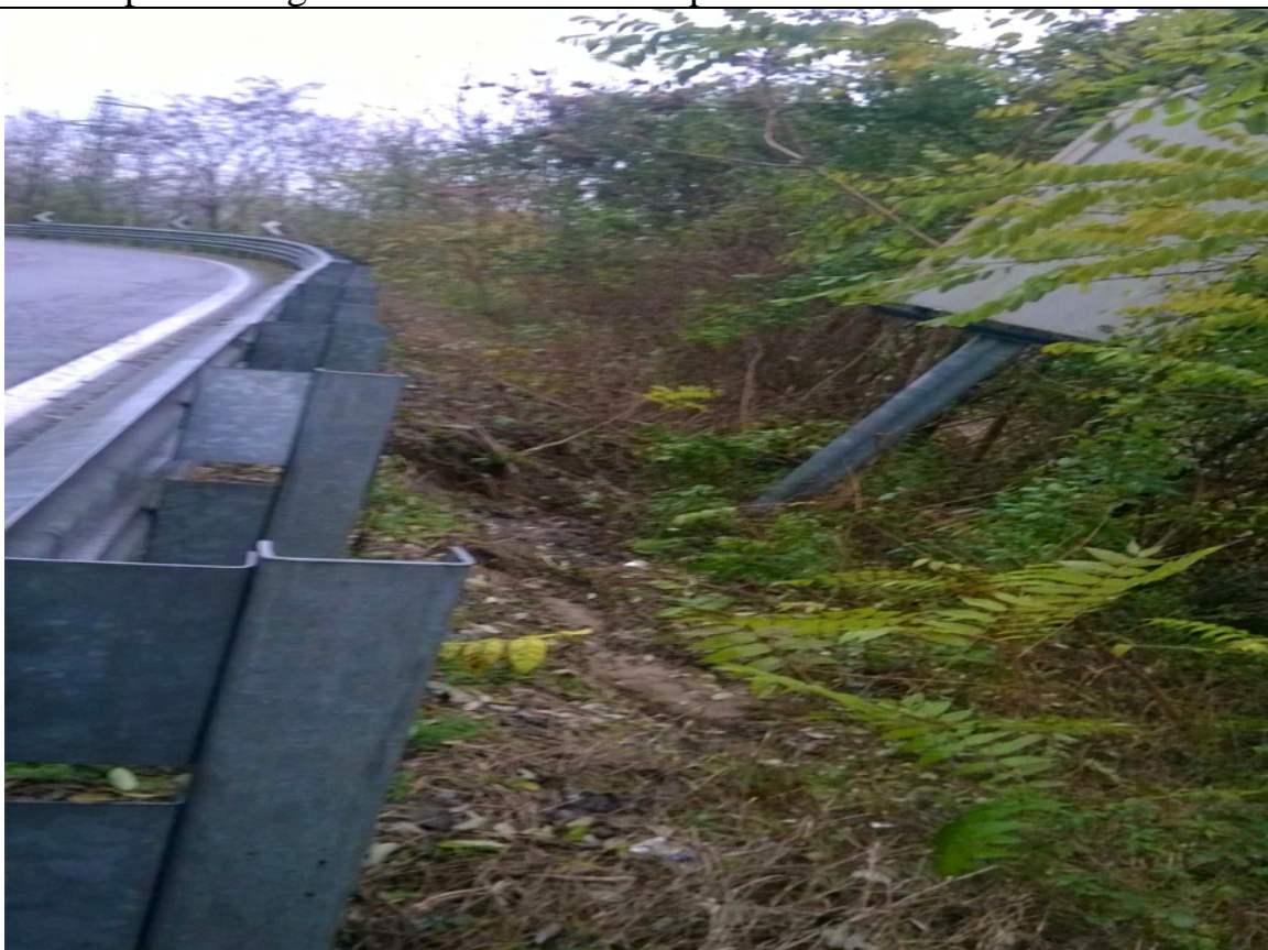
Sp 494 “Vigevanese” frana località Colla km 82+500 foto n°1
