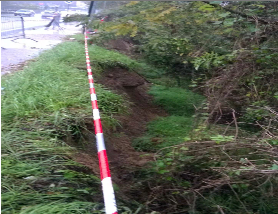
Sp 494 “Vigevanese” frana viale Repubblica km 75+950 foto n°2
