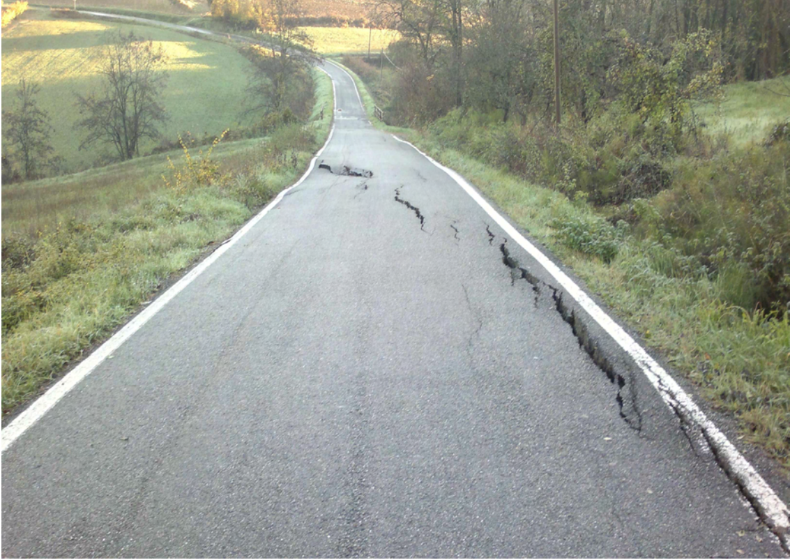
SP 104 “Volpedo-Pozzolgroppo” km 2+700 foto n° 1
