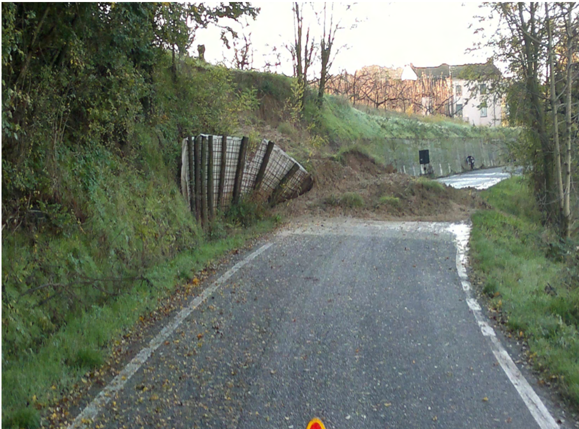
SP104 “Volpedo-Pozzolgroppo” km 5+000 foto n° 1
