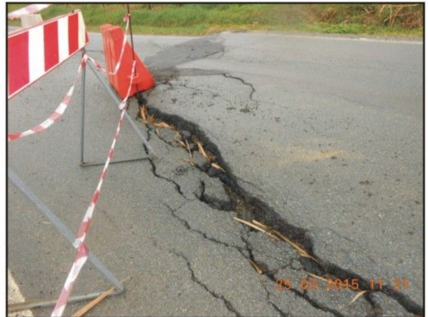
Particolare della foto precedente; sono chiaramente visibili le fratture del manto stradale
