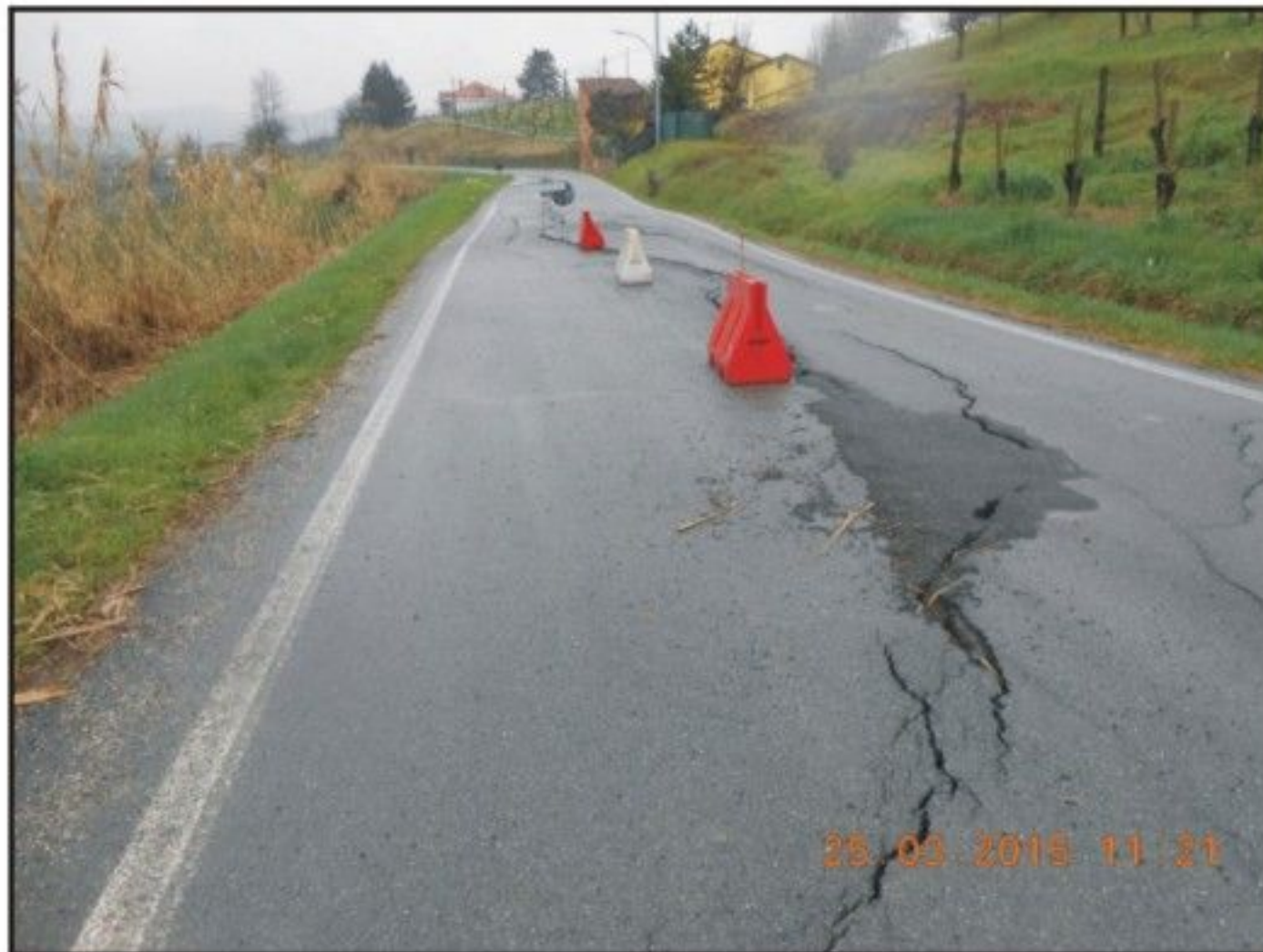
Movimento franoso al km 0+700 della S.P. 45C
