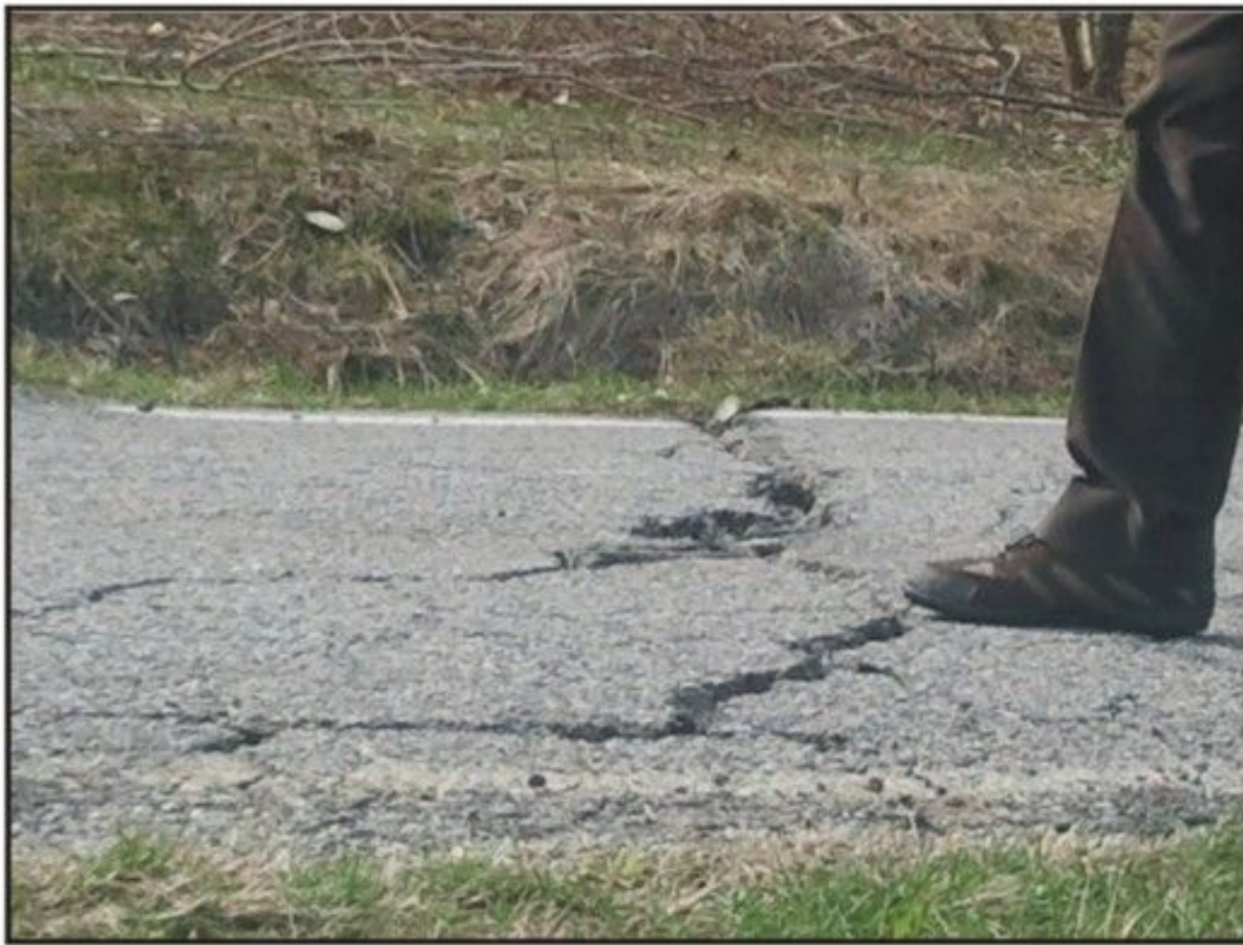
Movimento franoso al km 4+520 della S.P. 55 nel Comune di Cessole (AT)
