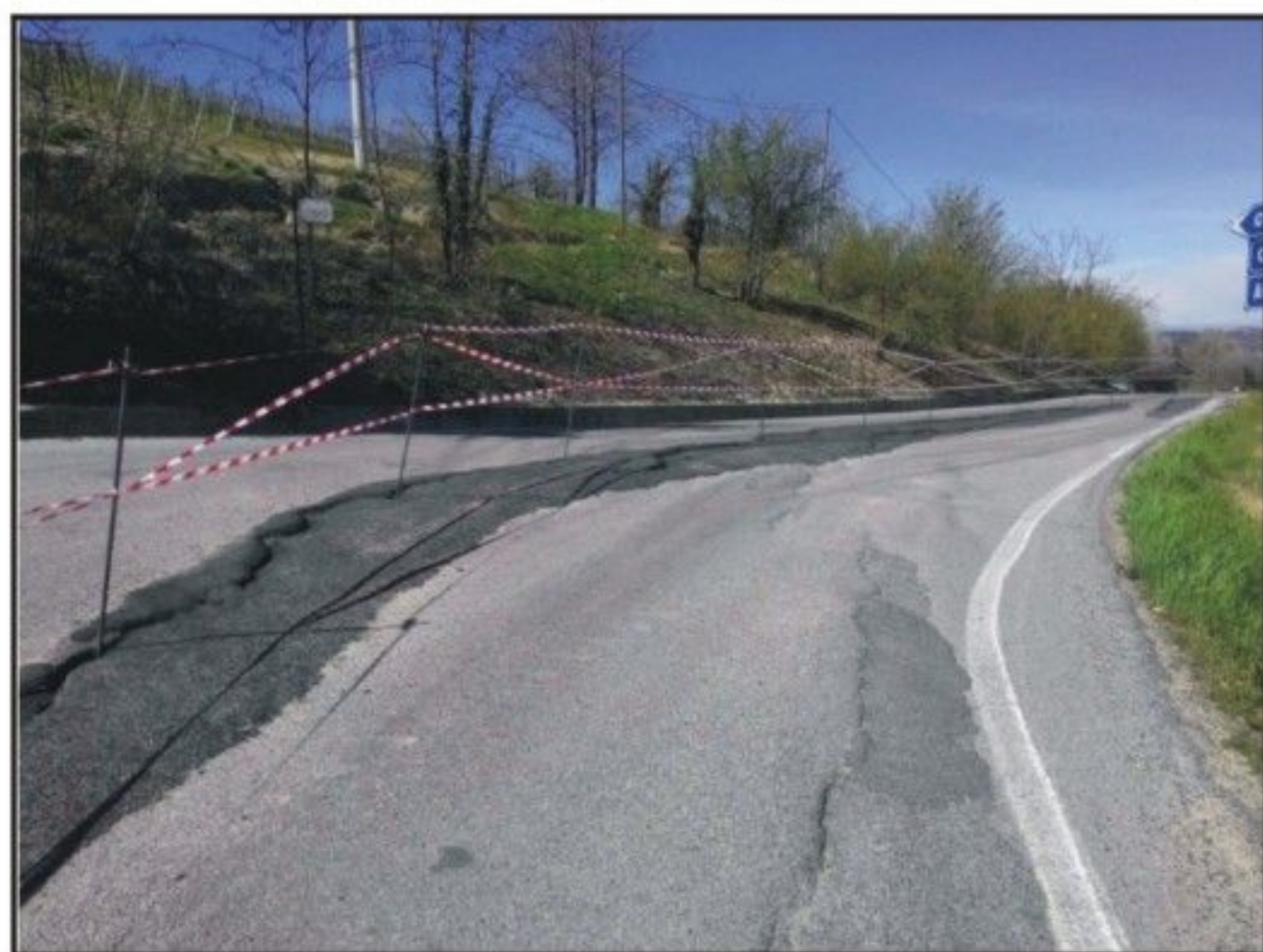
Movimento franoso al km 7+250 della S.P. 41
