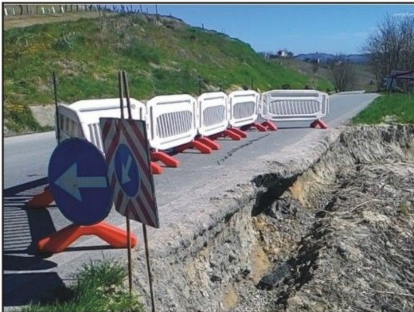
Movimento franoso al km 23+700 della S.P. 41
