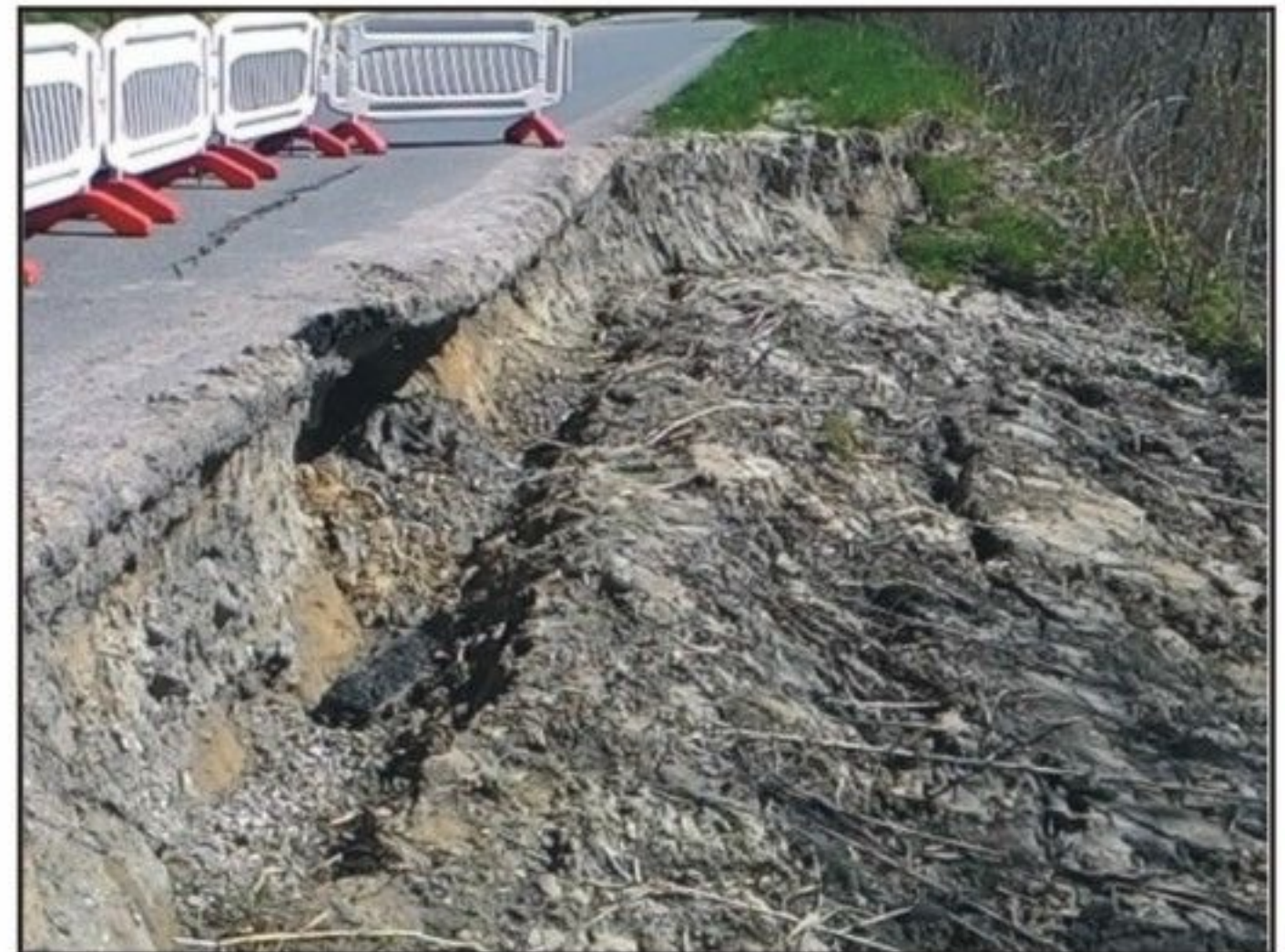
Dettaglio del ciglio stradale franato e dell'accumulo di materiale sul versante a valle della S.P.
