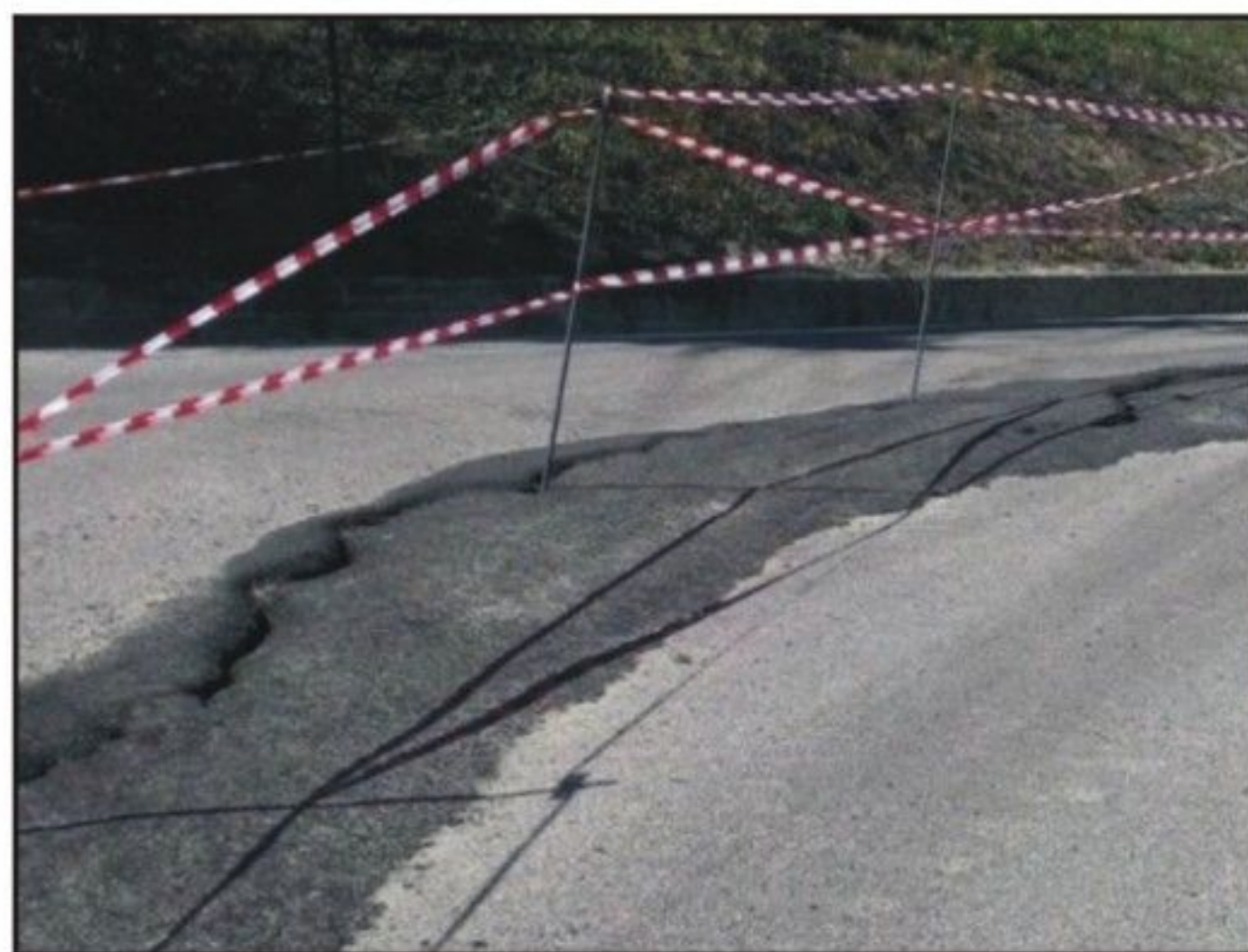
Particolare della foto precedente; è evidente la fratturazione del manto stradale, in più punti
