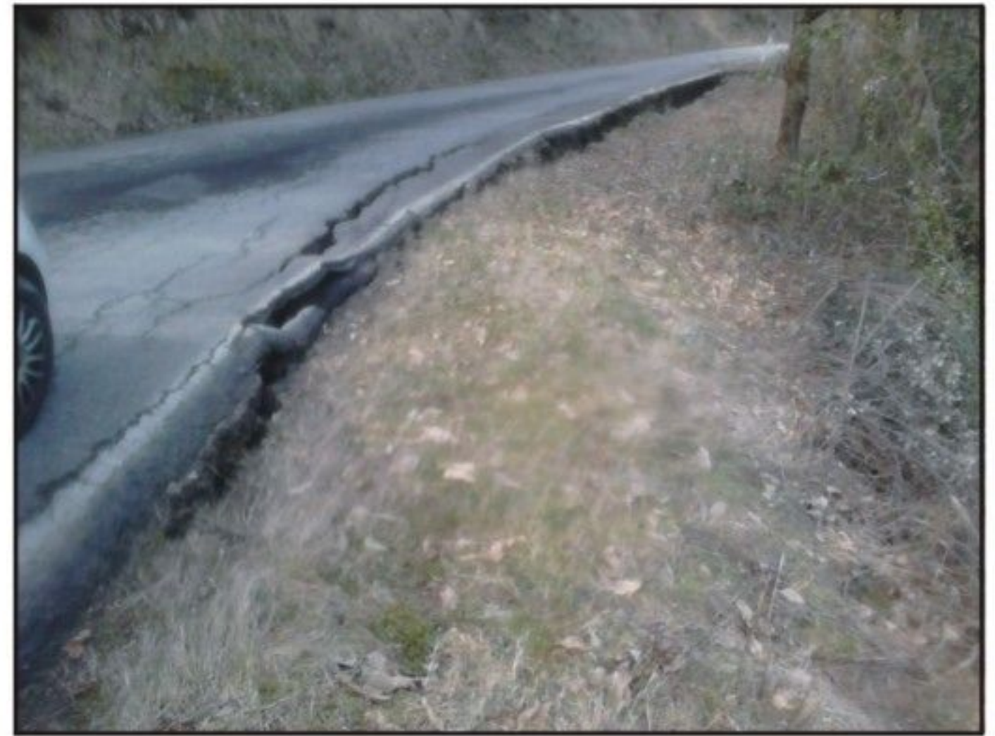
Movimento franoso al km 4+645 della S.P. 55 nel Comune di Cessole (AT)
