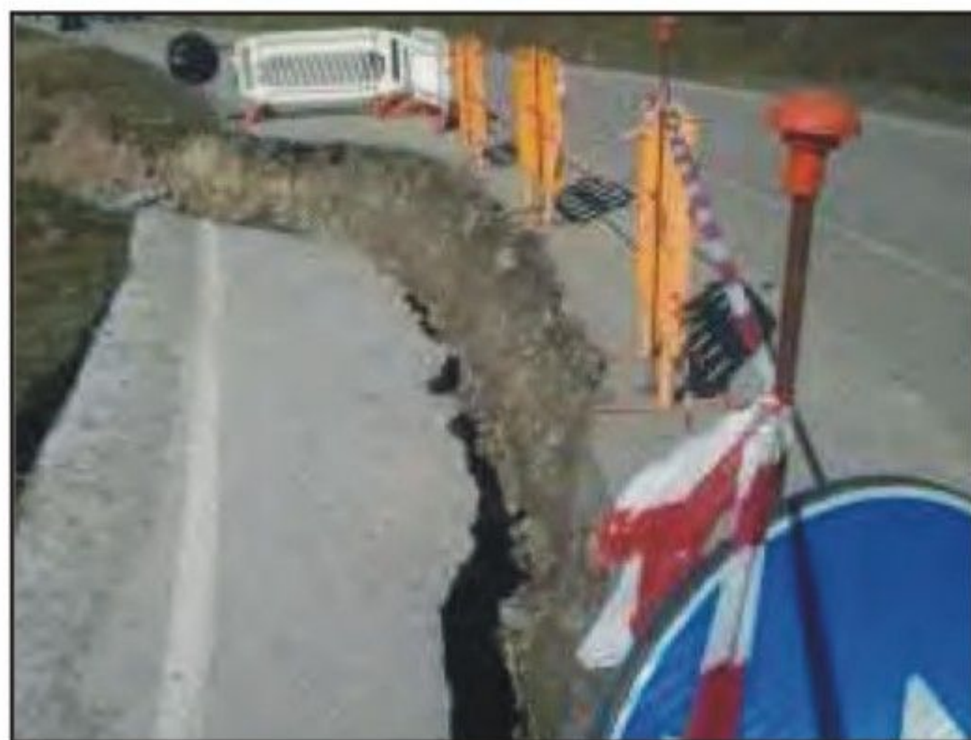
Particolare della foto precedente; è evidente la frattura del manto stradale con formazione di un gradino di altezza metrica
