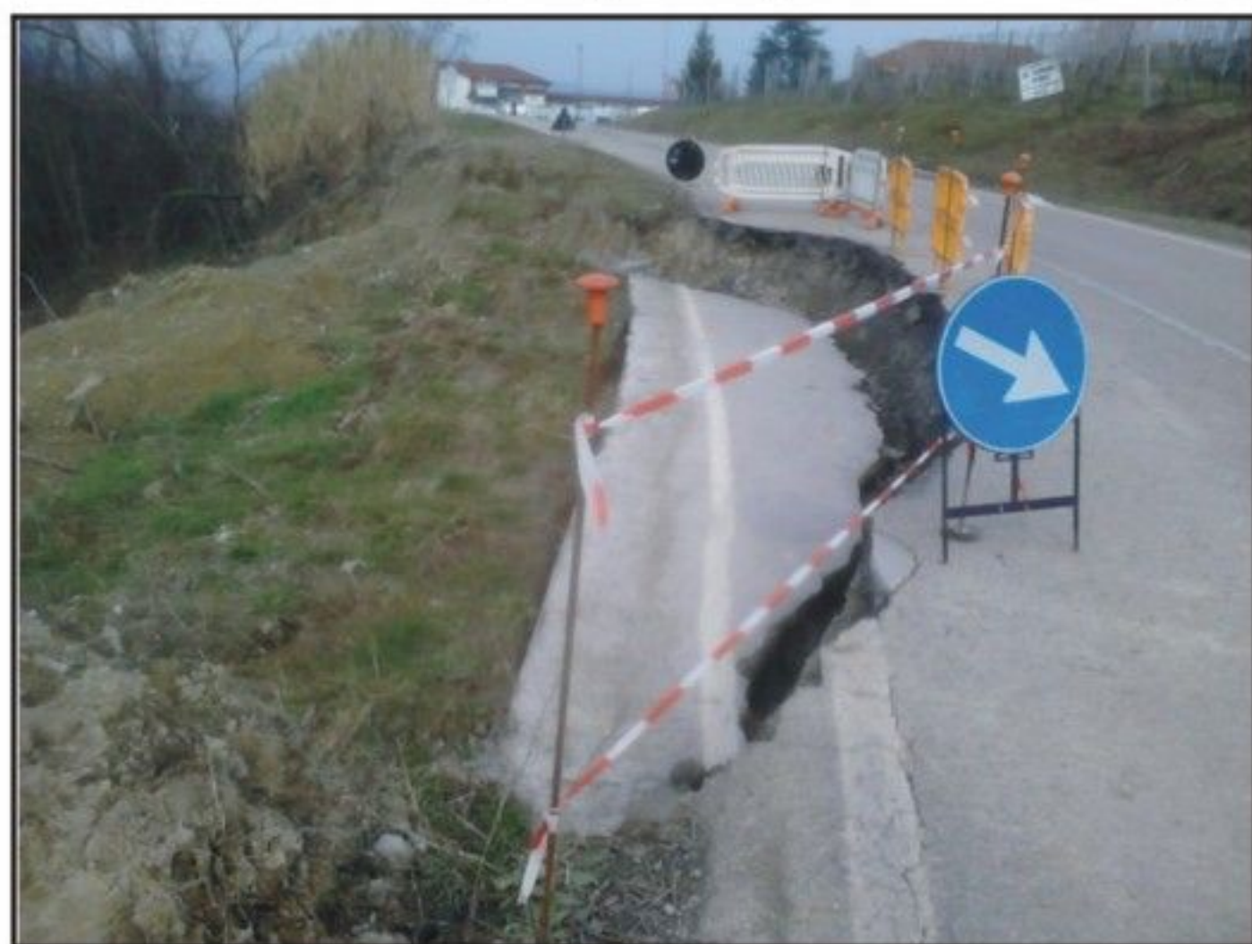
Movimento franoso al km 9+800 della S.P. 45
