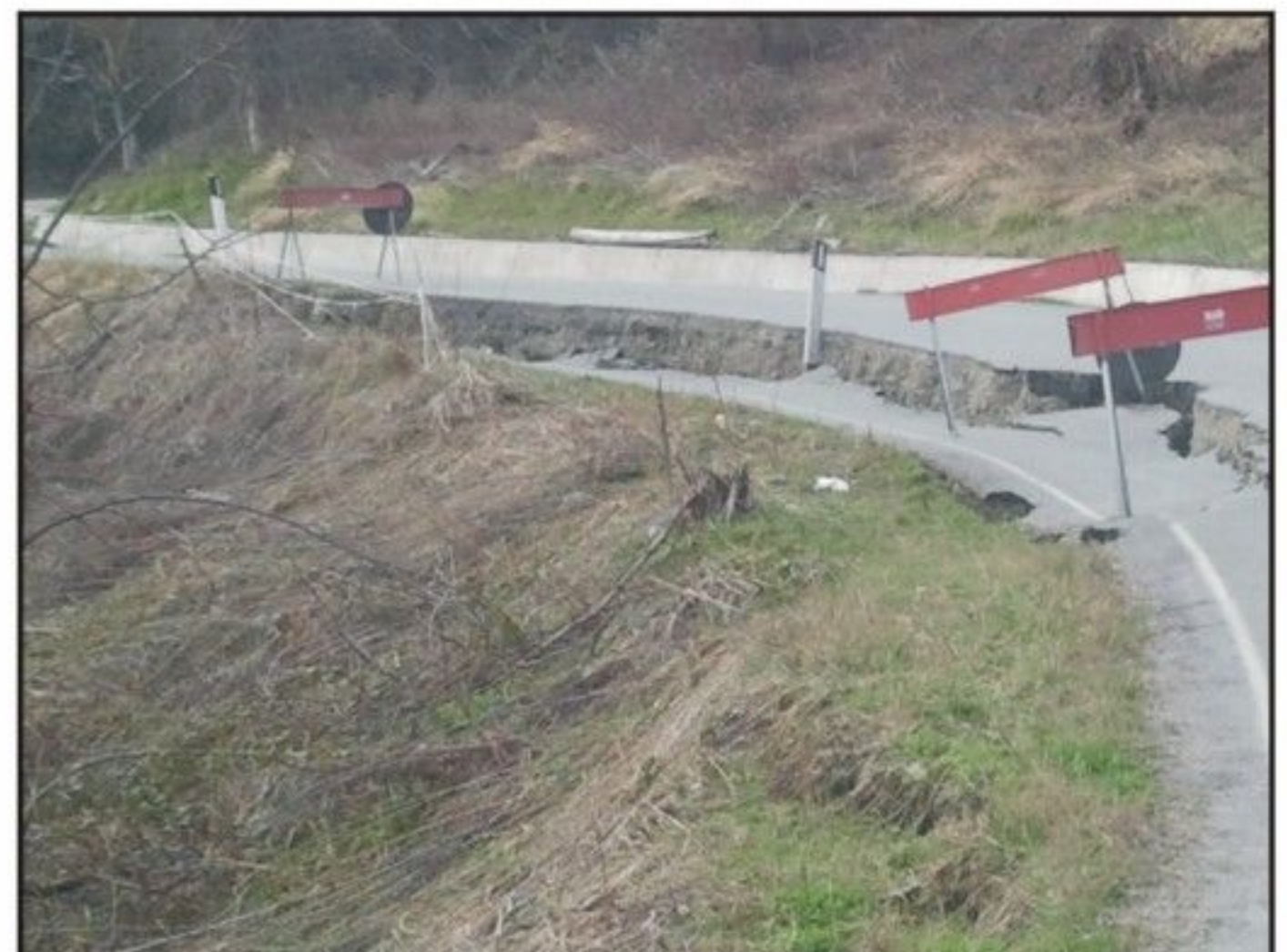
Movimento franoso al km 4+000 della S.P. 55 nel Comune di Cessole (AT)
