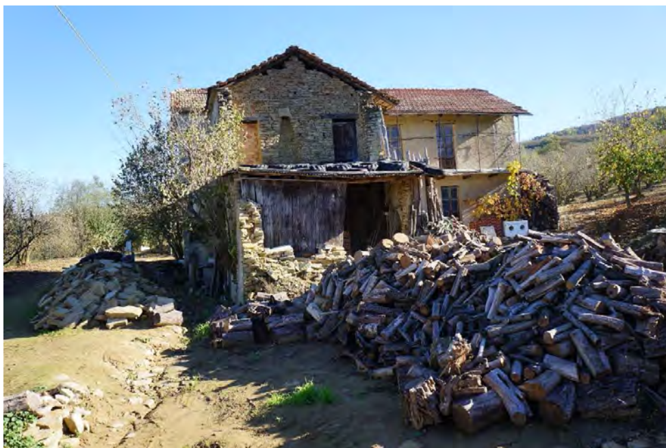
Immagine 05 - 2013/11/06-Abitazione isolata ubicata originariamente a valle della borgata di Vernetta Sottana che, per effetto della frana, subì una marcata traslazione verso valle subendo danni minori
