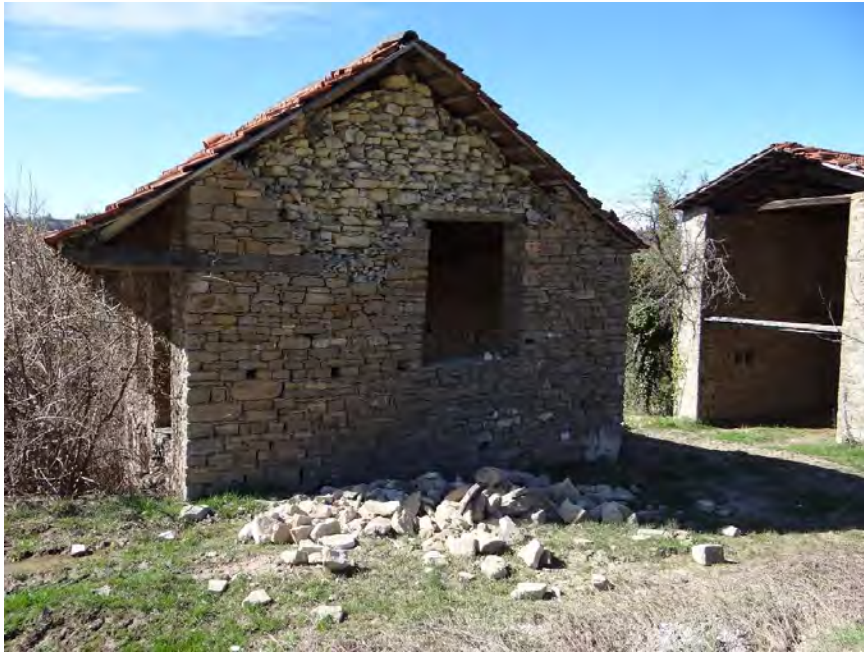
Immagine 13 - 2015/03/30-Riattivazione del marzo 2015, crollo parziale del muro portante a causa del movimento gravitativo
