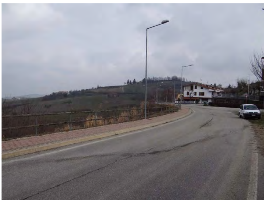
Immagine 02 - 2013_03_13-Lesione attuale del manto stradale che ricalca approssimativamente il coronamento del 1994
