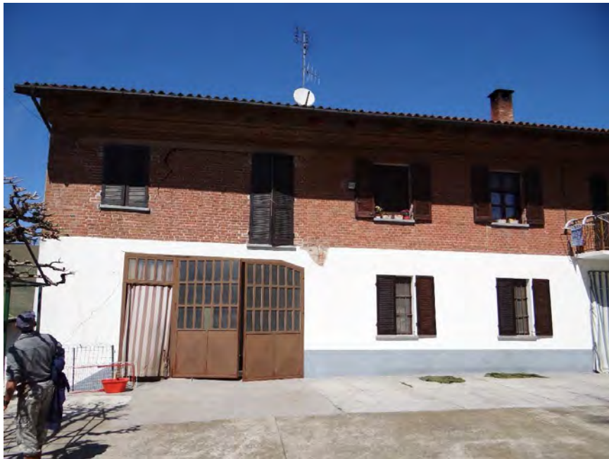
Immagine 07 - 2015/04/08-Facciata settentrionale dell'abitazione danneggiata dal movimento franoso
