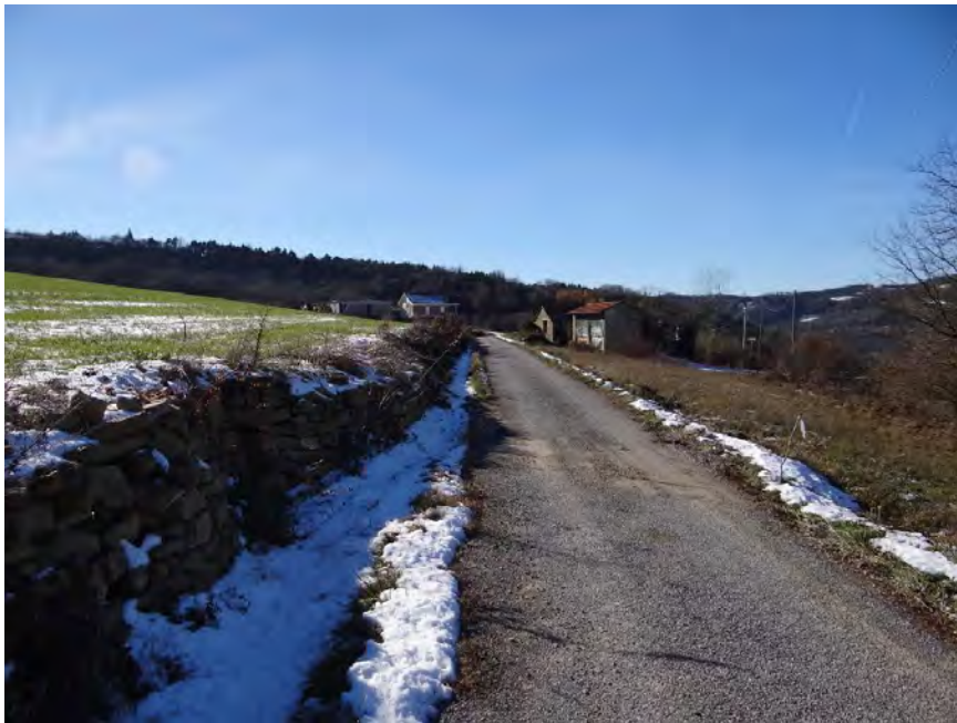
Immagine 03 - 2013/12/04-Sulla destra, a fianco della strada, la cascina seriamente danneggiata dal movimento del 1972; sulla sinistra l'abitazione costruita successivamente. Si noti il muretto in pietre deformato e la lesione della strada verificatasi nel 2013
