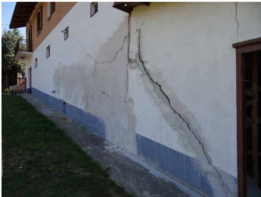
Immagine 08 - 2015/04/08-Facciata meridionale dell'abitazione danneggiata dal movimento franoso
