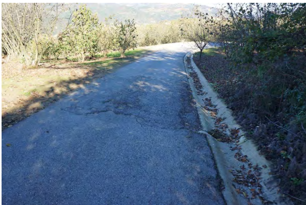
Immagine 02 - 2013/11/06-Strada comunale lesionata in corrispondenza del fianco sinistro della frana; la canaletta in cemento è tranciata e quindi non più funzionante
