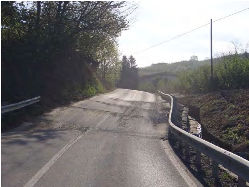
Immagine 16 - 2015/04/15-Deformazione accentuata della carreggiata della strada provinciale
