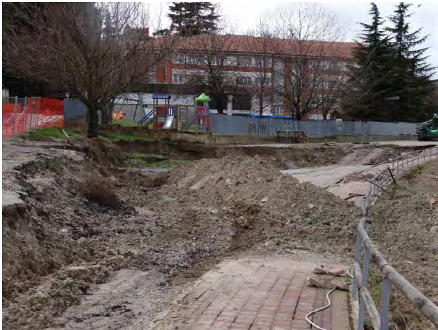
Immagine 08 - 2015_03_26-Zona centrale del coronamento di frana
