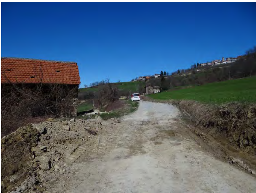
Immagine 12 - 2015/03/30-Riattivazione del marzo 2015, deformazione della strada comunale in corrispondenza del fianco sinistro; sulla sinistra l'abitazione coinvolta
