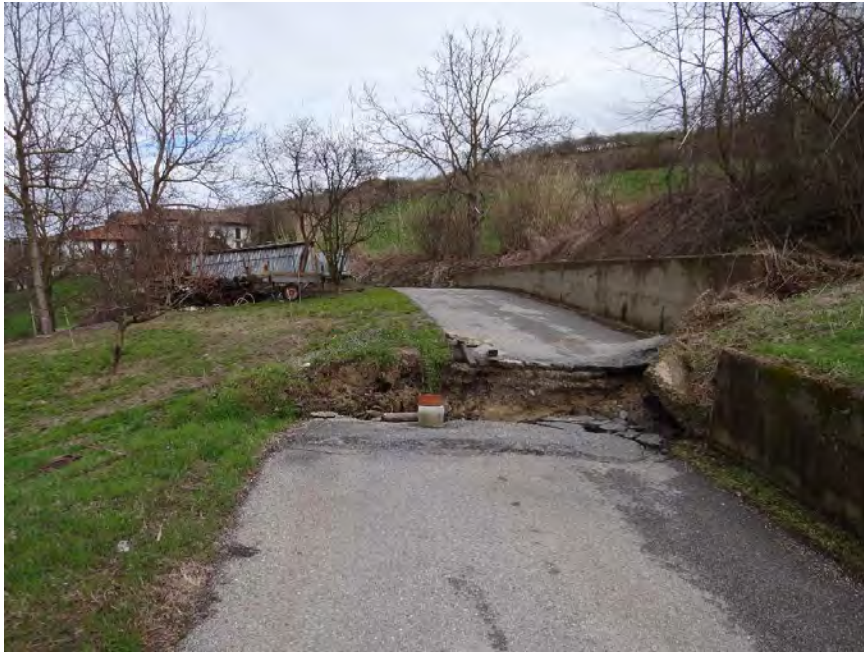
Immagine 09 - 2015/03/26-Taglio sulla strada comunale in corrispondenza del fianco destro
