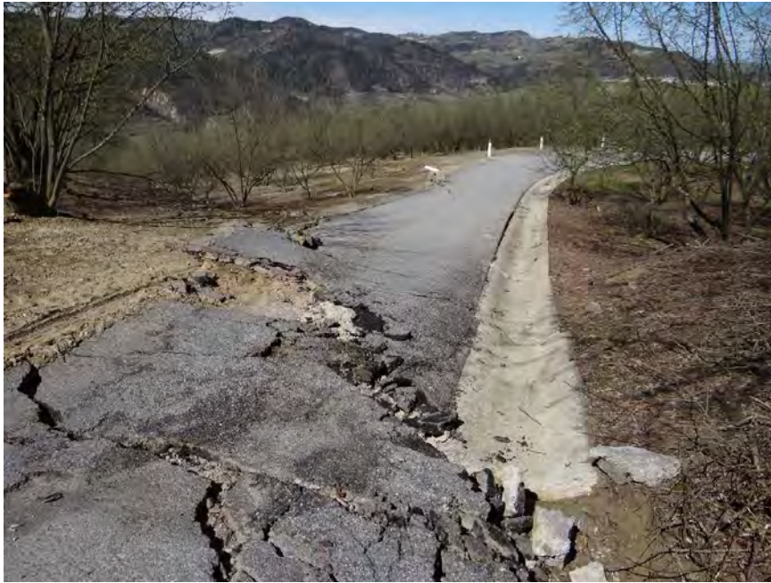
Immagine 15 - 2015/03/30-Taglio sulla strada comunale in corrispondenza del fianco sinistro
