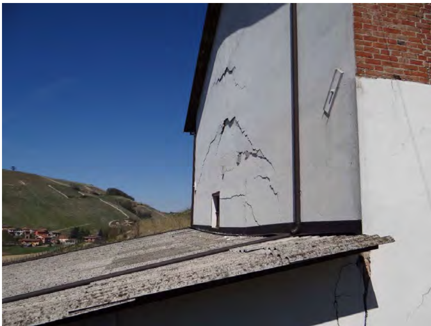
Immagine 10 - 2015/04/08-Facciata orientale dell'abitazione danneggiata dal movimento franoso
