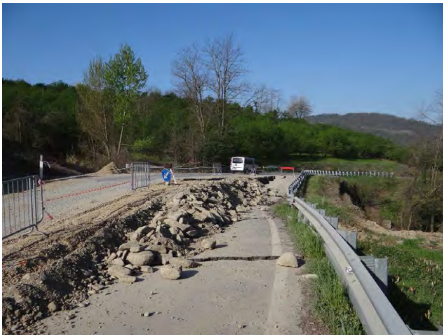
Immagine 18 - 2015/04/15-Taglio e deformazione della carreggiata della strada provinciale in corrispondenza del fianco sinistro; il materiale detritico è stato riportato per colmare lo scalino di frana
