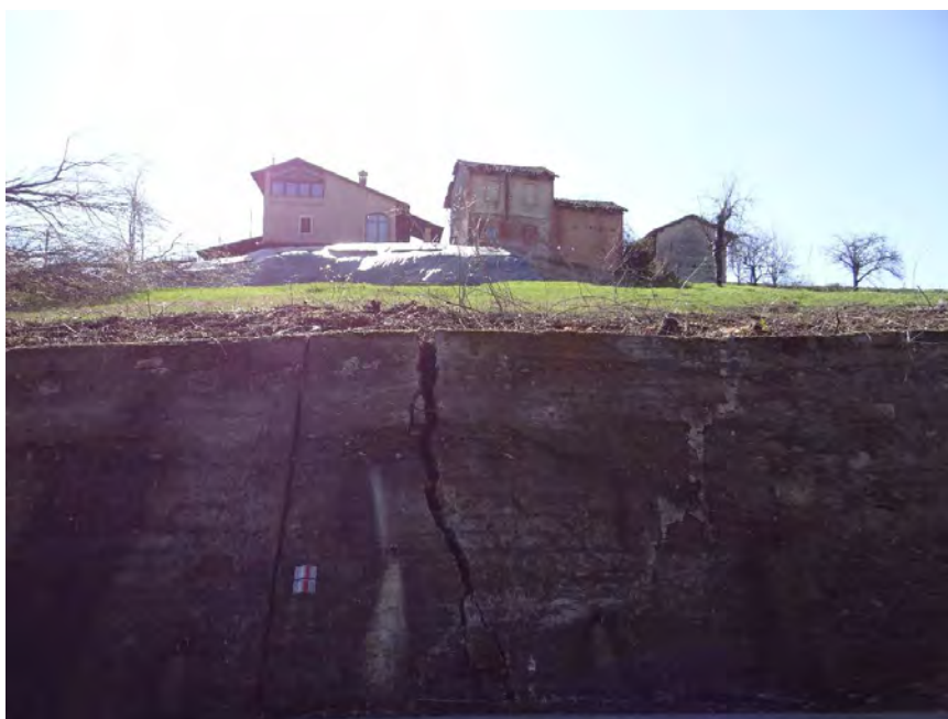
Immagine 02 - 2015_03_30-Frattura aperta sul muro di contenimento della scarpata di monte della SP 58
