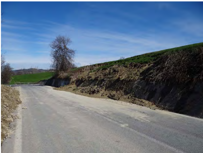
Immagine 06 - 2015/03/30-Tratto della strada provinciale interessato da accumulo di terra per effetto del movimento franoso
