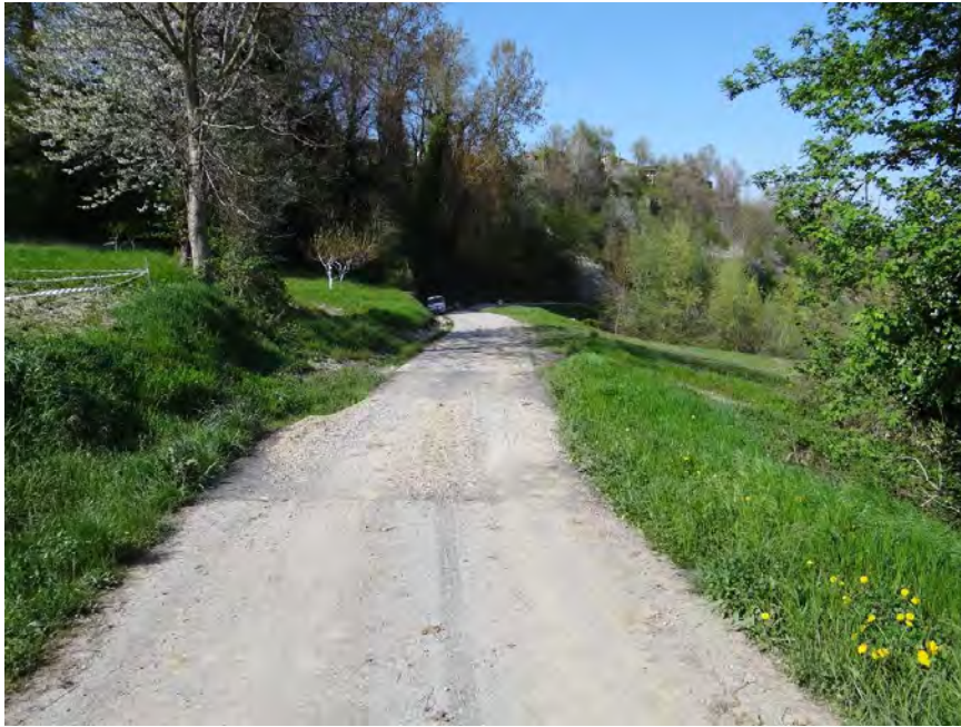
Immagine 05 - 2015/04/15-Taglio del ramo inferiore della strada comunale per effetto della frana con coronamento sul ramo superiore (vedi foto precedente)
