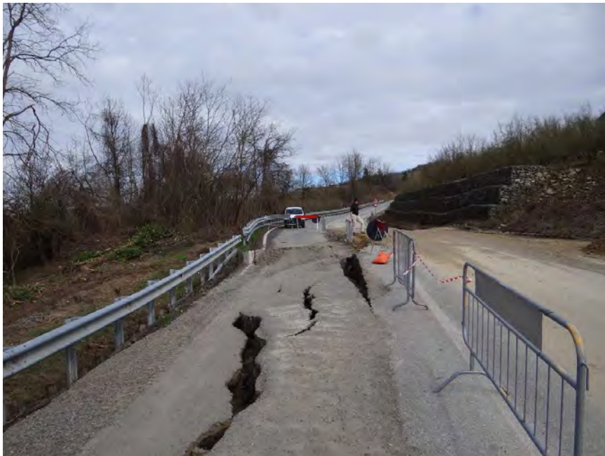
Immagine 12 - 2015/03/26-Taglio sulla strada provinciale in corrispondenza del fianco sinistro; le gabbionate a monte e a valle della strada sono state pesantemente deformate
