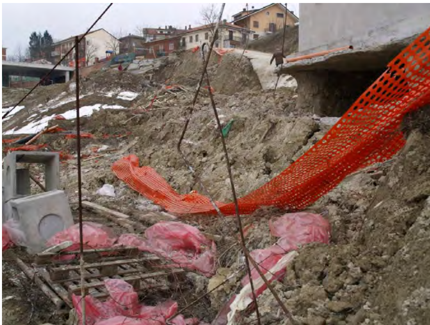
Immagine 05 - 2009/03/20-Scalzamento delle fondazioni della nuova ala del ricovero anziani in costruzione
