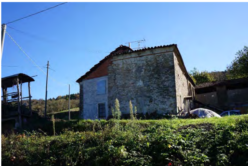
Immagine 08 - 2013/11/06-Abitazione isolata ubicata a monte del coronamento della frana del 1936, in destra idrografica, lesionata dall'attivazione del 1972.
