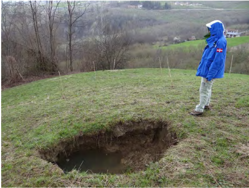
Immagine 05 - 2015_03_26-Cavità ubicata circa 25 metri a valle della zona inferiore del piede del fenomeno
