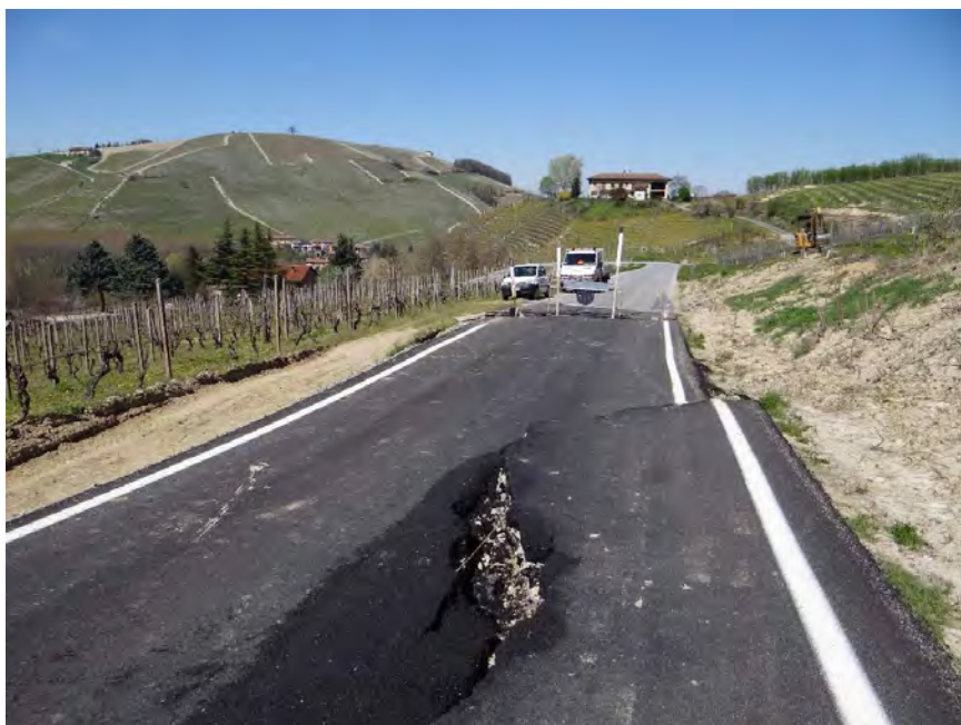
Immagine 06 - 2015/04/08-Strada Provinciale resa intransitabile per effetto del movimento franoso in corrispondenza del fianco sinistro
