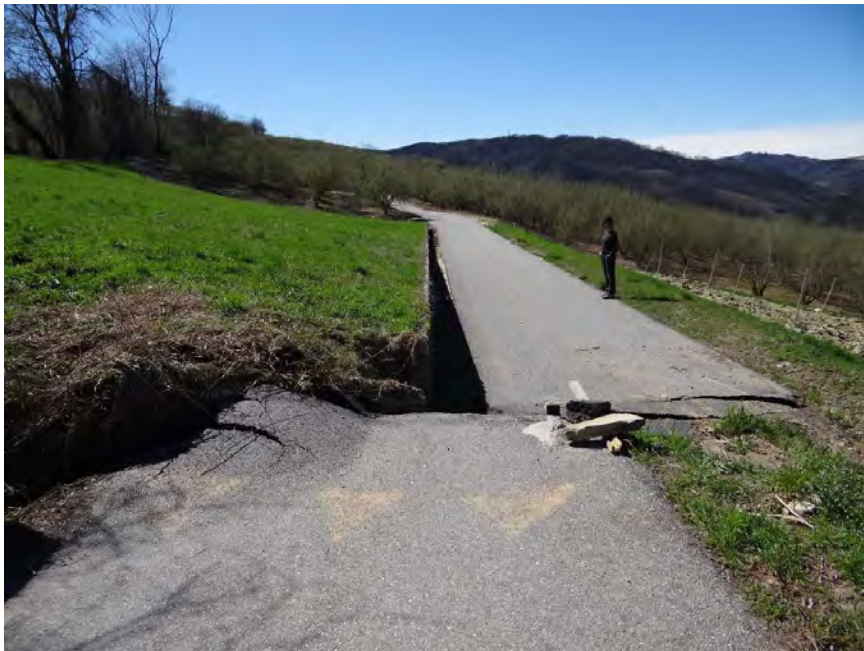
Immagine 14 - 2015/03/30-Taglio sulla strada comunale in corrispondenza del fianco destro
