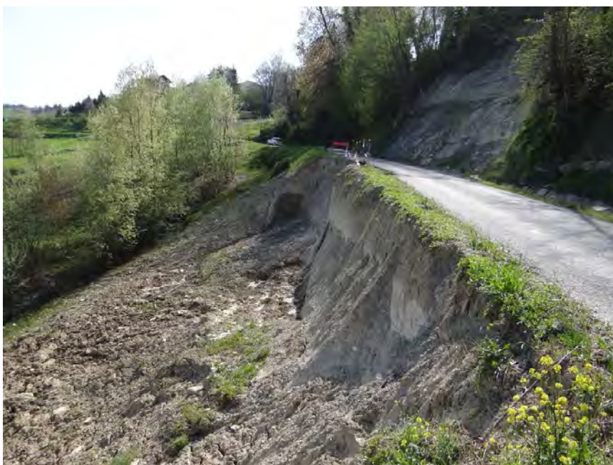
Immagine 02 - 2015/04/15-Scarpata di coronamento della frana verificatasi a marzo 2015 indicativamente al centro del fenomeno generale; a monte della strada il denudamento del verdante riferibile alla primavera 2013
