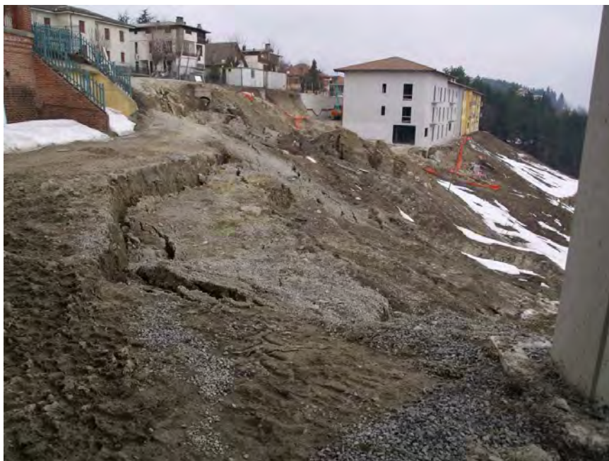
Immagine 01 - 2009/03/20-Ripresa della frana dal coronamento in destra idrografica
