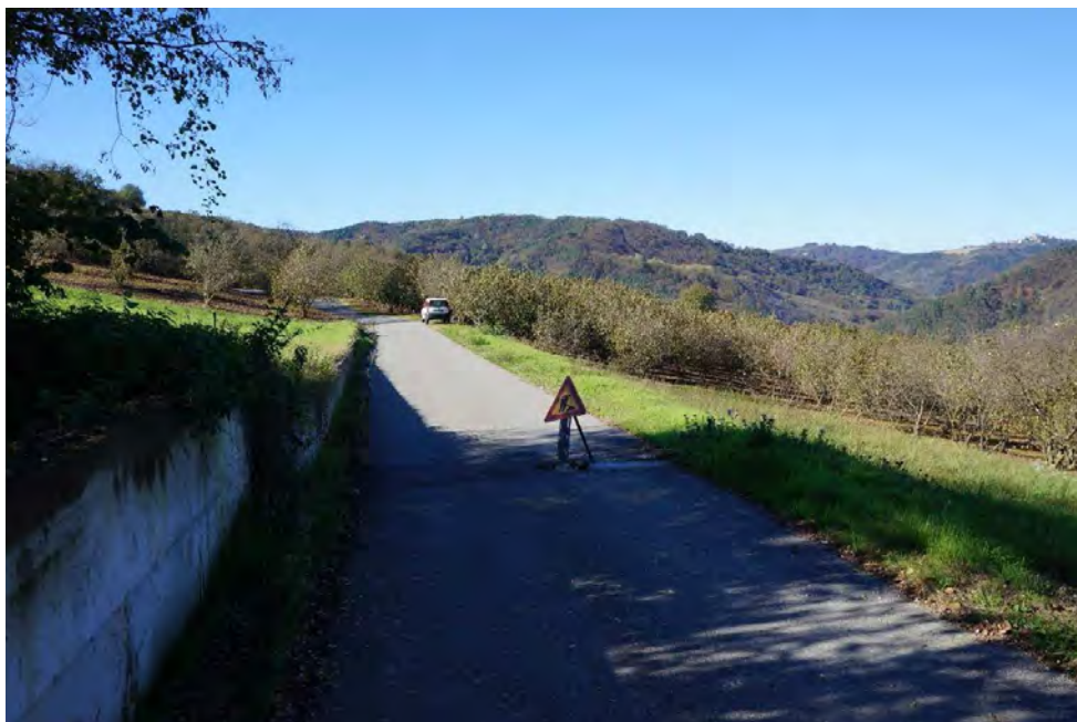
Immagine 01 - 2013/11/06-Strada comunale lesionata in corrispondenza del fianco destro della frana; in secondo piano, a valle della strada dove è presente un nocchieleto, il sito che ospitava la borgata di Vernetta Sottana
