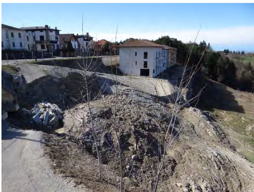
Immagine 08 - 2015/03/30-Deformazione del terreno compreso tra i campi da gioco e la casa di riposo in fase di costruzione a seguito della riattivazione del marzo 2015
