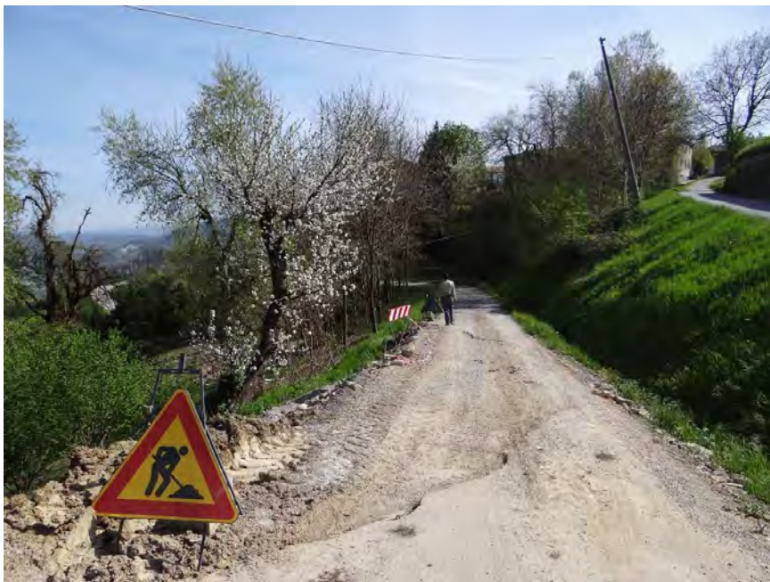
Immagine 04 - 2015/04/15-Coronamento della frana sviluppatasi a marzo 2015 impostato sulla strada comunale comunale nei pressi dell'incrocio compreso tra Noceto Sopr. e Noceto Sott.
