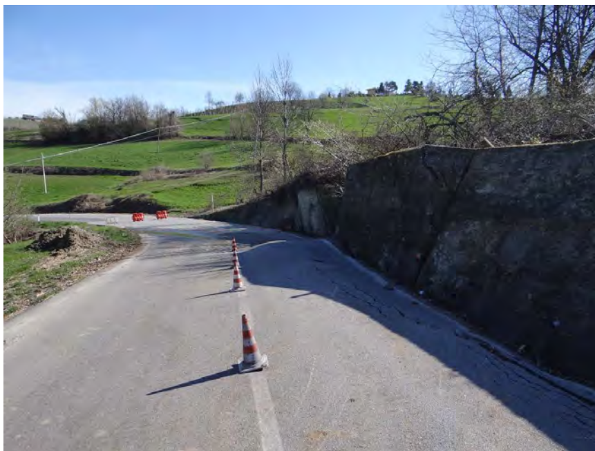
Immagine 01 - 2015_03_30-Deformazione della carreggiata della SP 58 e danneggiamento del muro di contenimento
