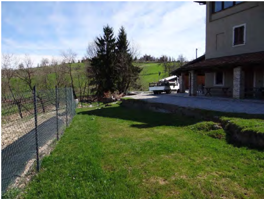
Immagine 04 - 2015_03_30-Danni alla zona adibita a giardino ubicata sul lato di valle della cascina
