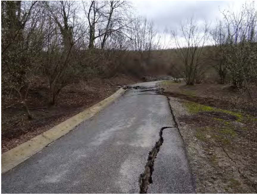
Immagine 11 - 2015/03/26-Taglio sulla strada comunale in corrispondenza del fianco sinistro
