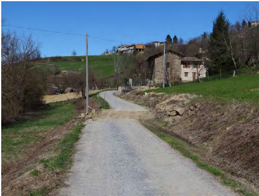
Immagine 11 - 2015/03/30-Riattivazione del marzo 2015, deformazione della strada comunale in corrispondenza del fianco destro
