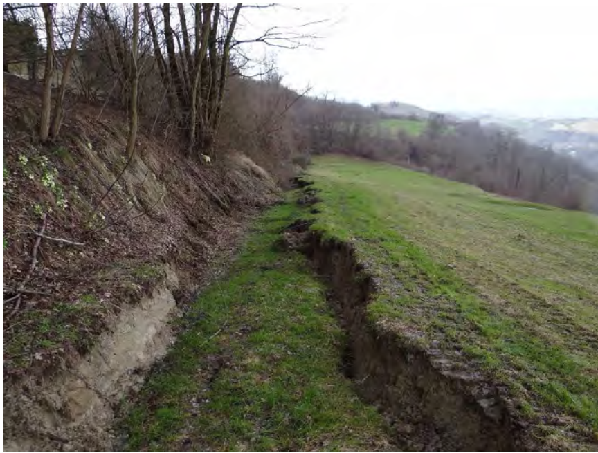
Immagine 03 - 2015_03_26-Coronamento di frana, fotografia scattata guardando verso nordovest
