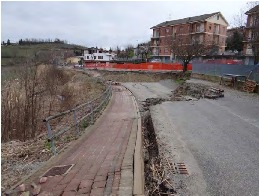
Immagine 07 - 2015_03_26-Coronamento di frana, fotografia scattata guardando verso est
