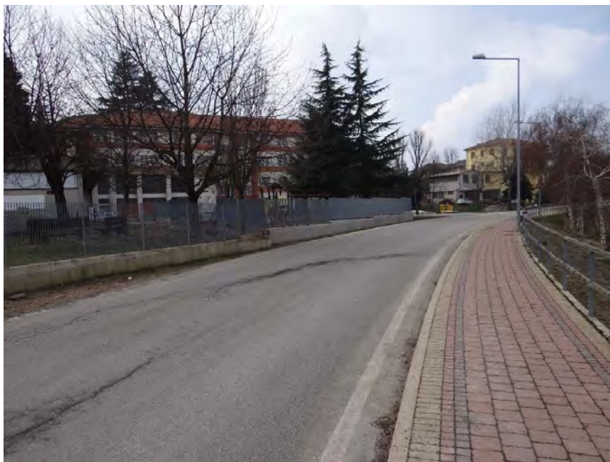
Immagine 01 - 2013_03_13-Lesione attuale del manto stradale che ricalca approssimativamente il coronamento del 1994
