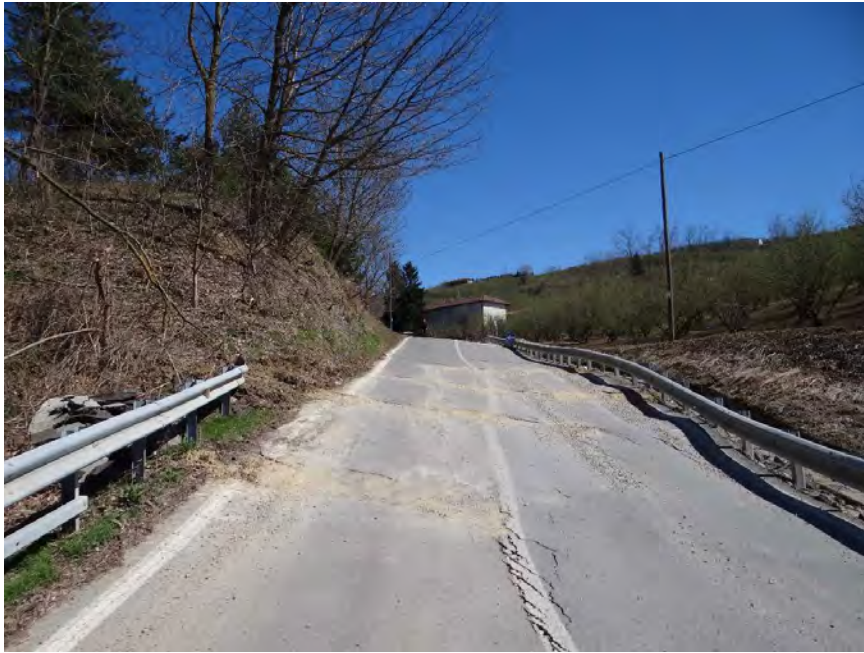
Immagine 13 - 2015/03/30-Deformazione della strada provinciale in prossimità del fianco destro
