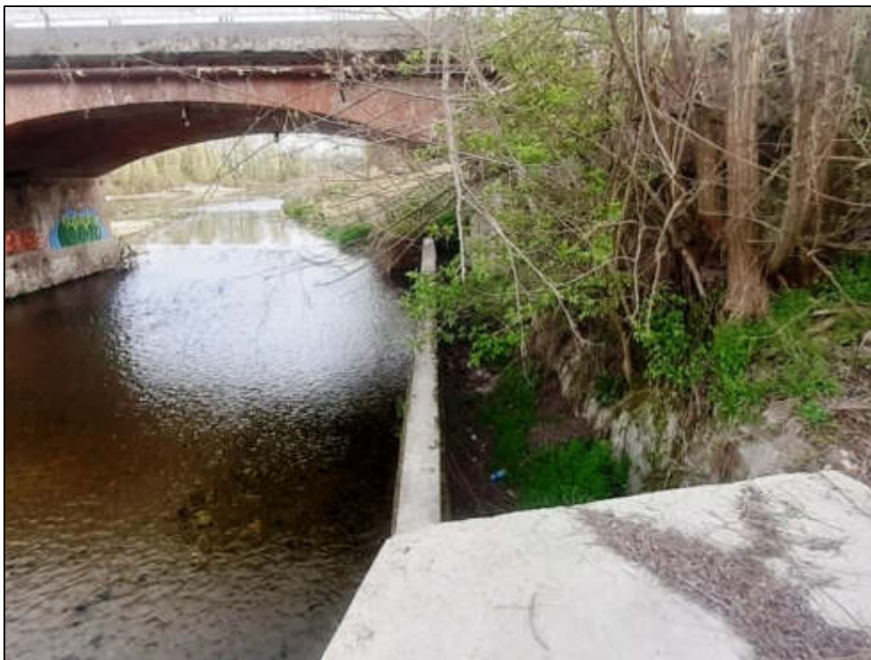
Figura 99 – Sistema di drenaggio presente in sponda sinistra del Maira che viene attualmente utilizzato dalla fauna selvatica per il superamento della SP30.
