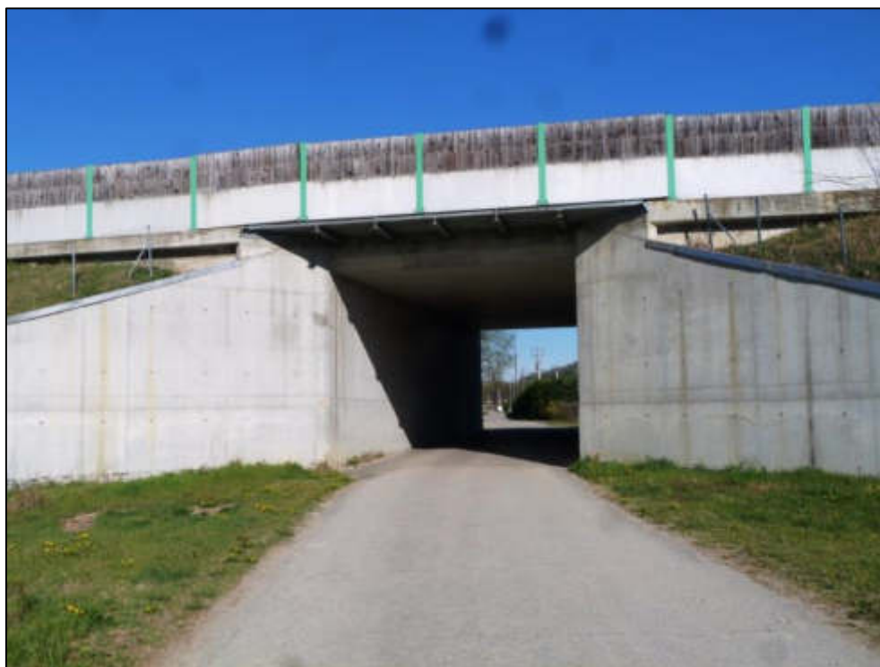
Figura 5 – Sottopasso carrabile della A33 in prossimità del varco V-01 in comune di Magliano Alfieri.
