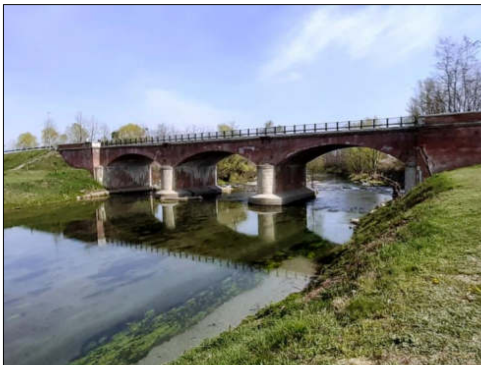
Figura 211 – Ponte della SP1 per il superamento del fiume Po in prossimità del varco V-26 in comune di Villafranca Piemonte.
