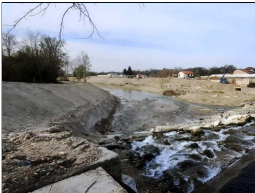
Figura 98 – Lavori di realizzazione delle opere di difesa sul Maira a valle del ponte della SP30 in prossimità del varco V-16 in comune di Racconigi.
