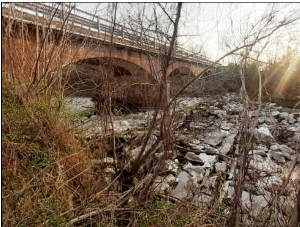
Figura 126 – Dettaglio della sponda sinistra del torrente Varaita in corrispondenza del ponte della SP129.
