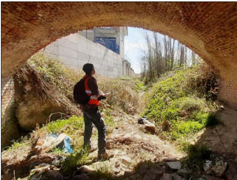
Figura 50 – Aspetto dell'alveo del rio della Gera all'uscita Sud del sovrappasso della Statale SS231.
