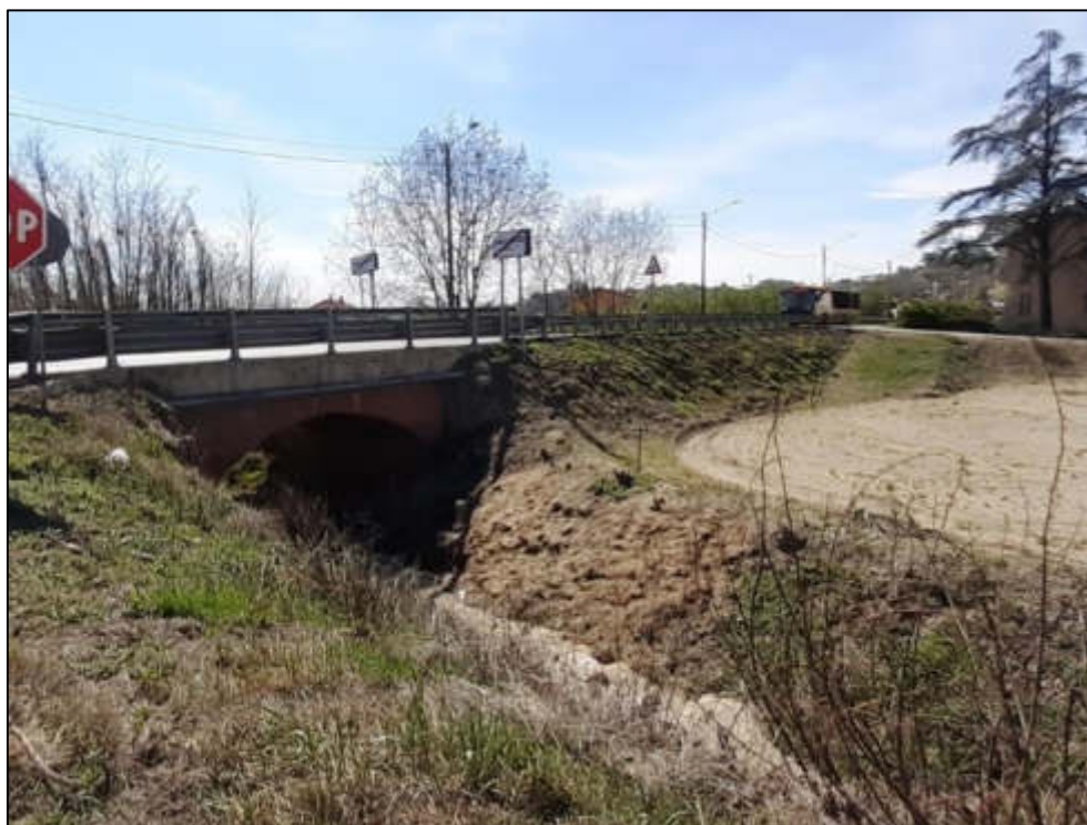
Figura 48 – Aspetto degli argini del rio della Gera nel tratto a Nord della Statale SS231, in prossimità del varco V10 tra i comuni di Bra e Pocapaglia.
