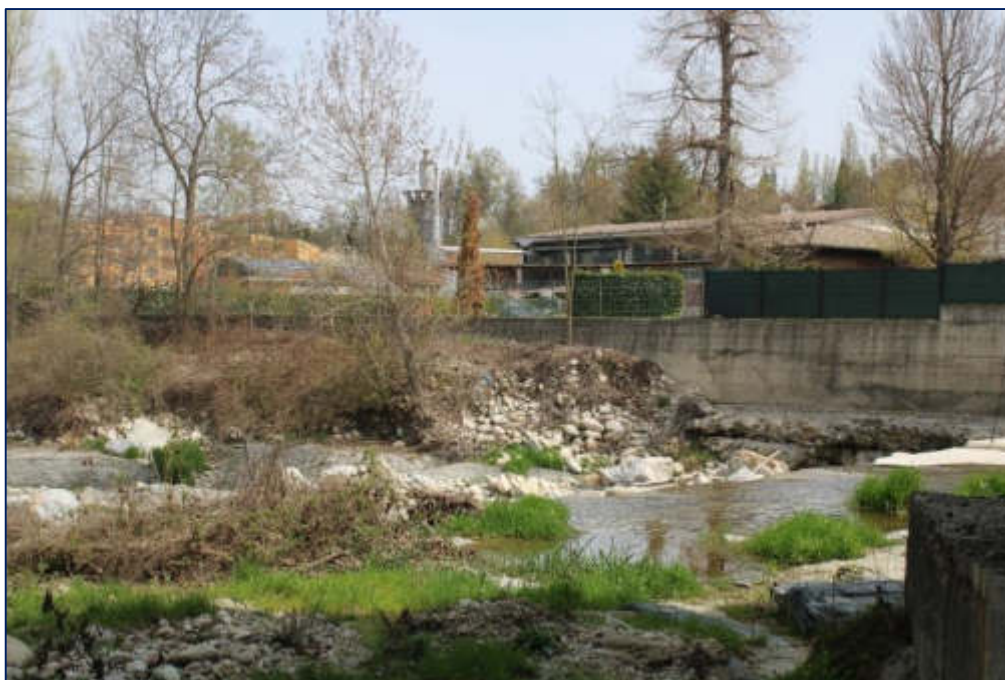
Figura 71 – Dettaglio della sponda destra del torrente Pesio in corrispondenza del ponte della SP37, con muraglione di cemento che risulta un ostacolo al passaggio della fauna terrestre lungo tale sponda.
