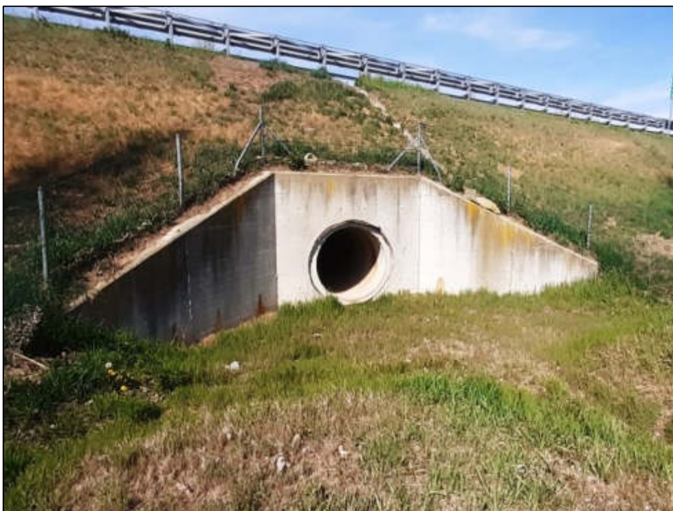
Figura 150 – Una delle quattro canalizzazioni di drenaggio della A33 in prossimità del varco V-12 in comune di Cherasco.
