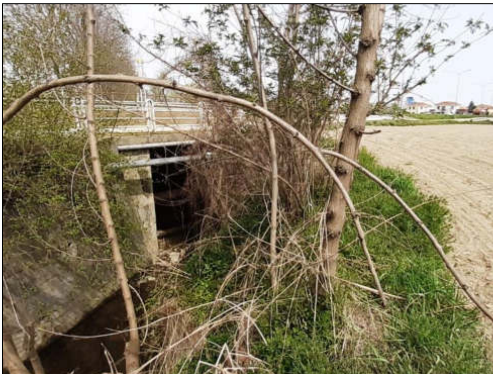
Figura 132 – Corso del rio Chiaretto a monte della SP663, in prossimità del varco V-23 in comune di Polonghera.
