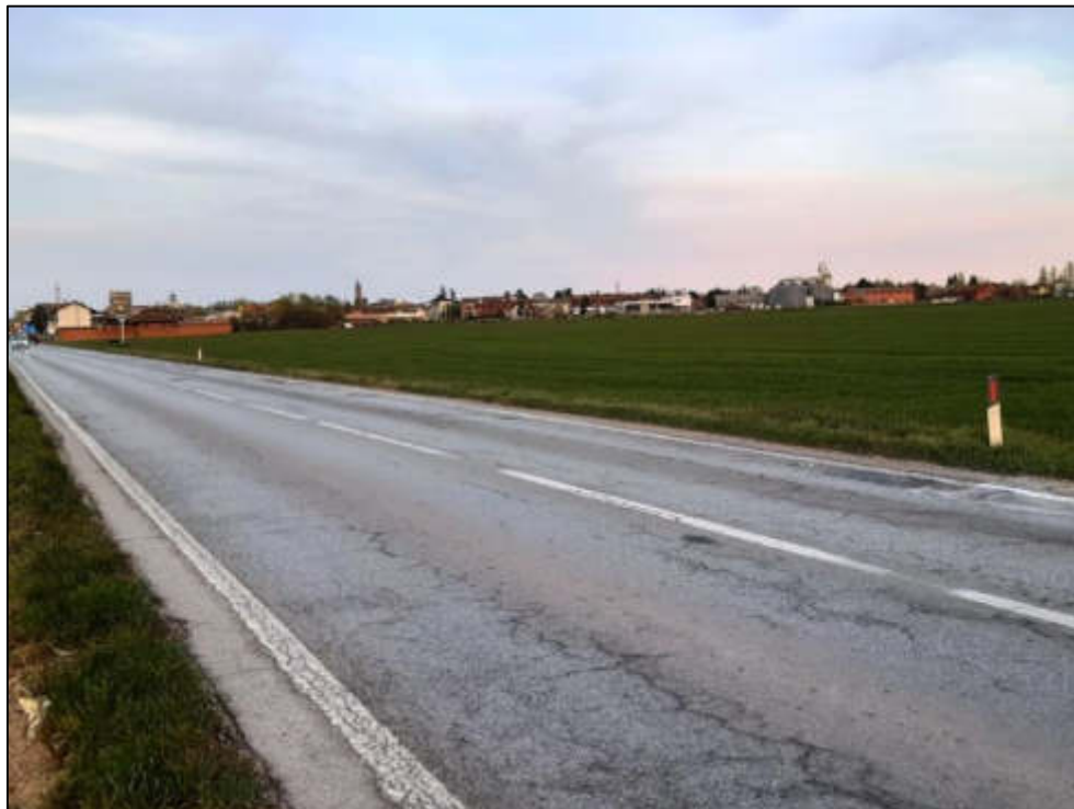
Figura 101 – Tratto permeabile lungo il tracciato della SP662 nella porzione meridionale del varco V-20 in comune di Savigliano.
