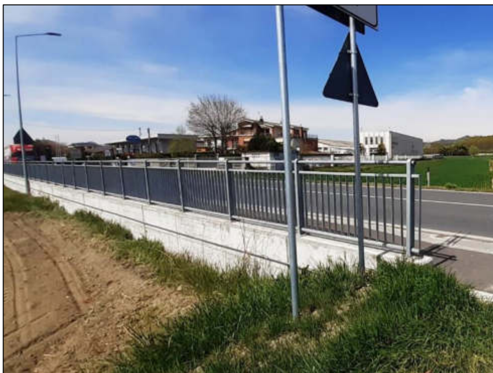
Figura 27 – Tratto meridionale della SS231 in prossimità del varco V-07 in comune di Alba che risulta completamente occluso per la presenza di una barriera pedonale.
