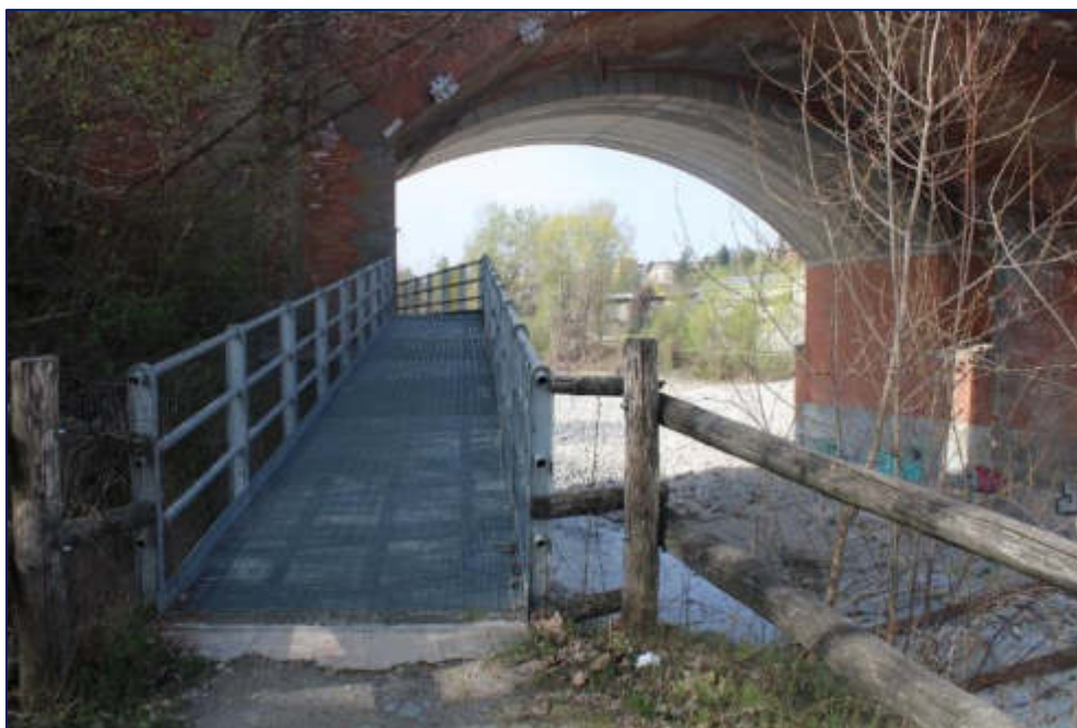
Figura 164 – Dettaglio della passerella ciclo-pedonale in sponda destra del torrente Gesso, nel punto in cui passa sotto la SP422, rendendo la sponda permeabile per la fauna selvatica terrestre.
