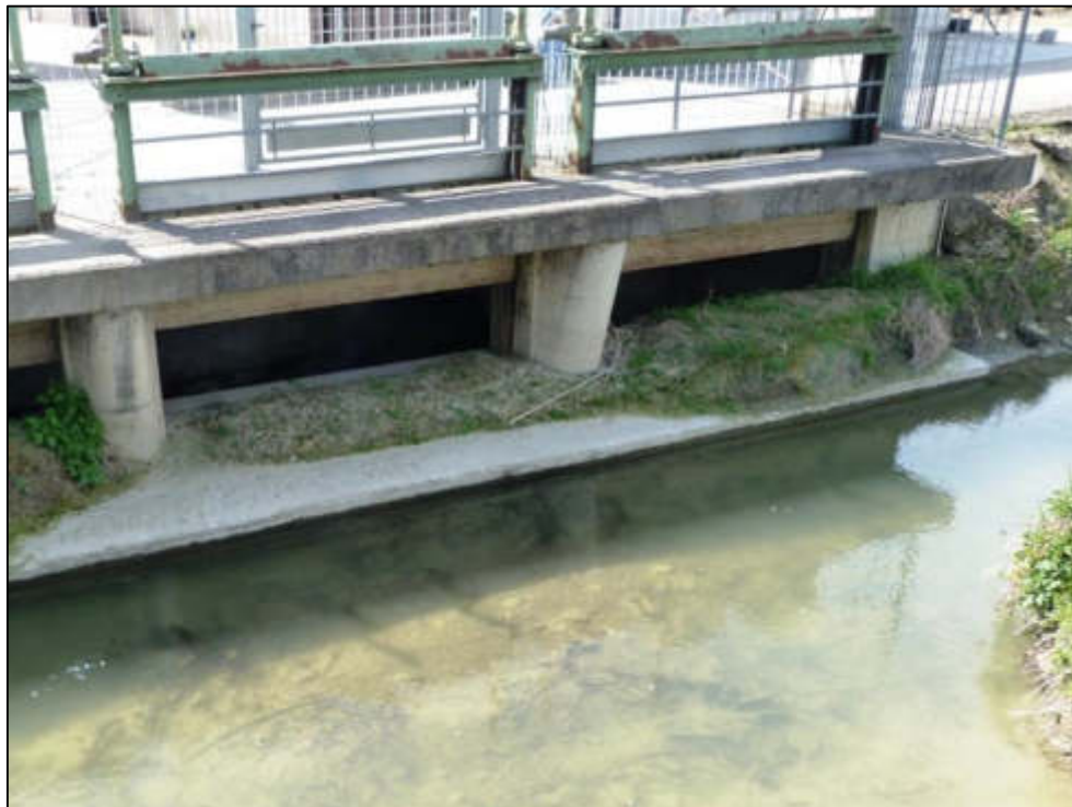
Figura 21 – Briglia di sfioro lungo il canale Mussotto, nella porzione settentrionale del varco V-05 in comune di Alba.
