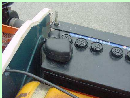
Esempio di protezione dei morsetti
