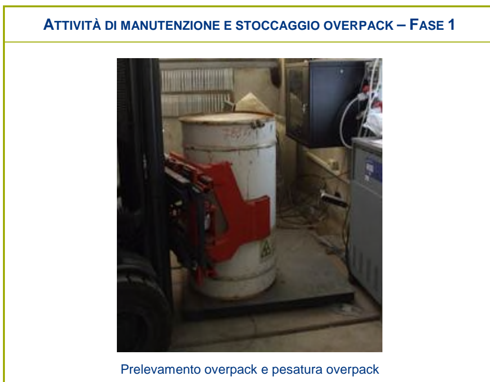
Figura 2-33 – Attività di manutenzione e stoccaggio overpack – Fase 1
