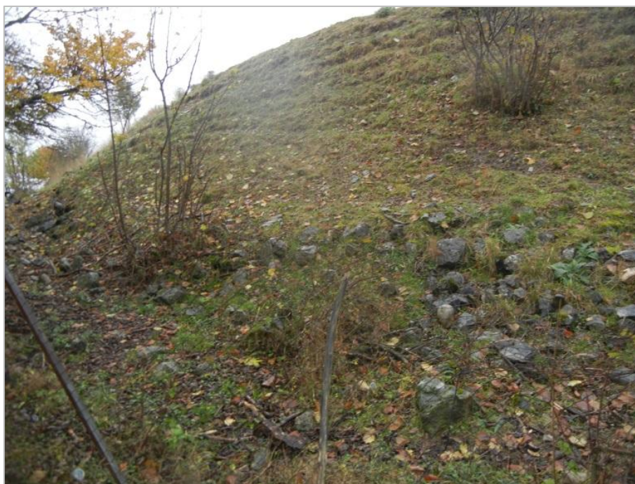
Figure 31. Tapis drainant en pied aval du barrage des G... (France – 05) – (photo : Bambara G., 2014)
