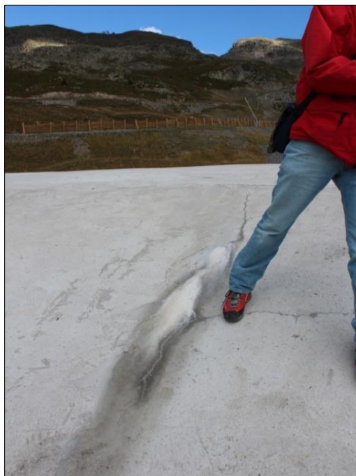
Figure 18 – Traces de circulation d'eau sur un évacuateur de crue
