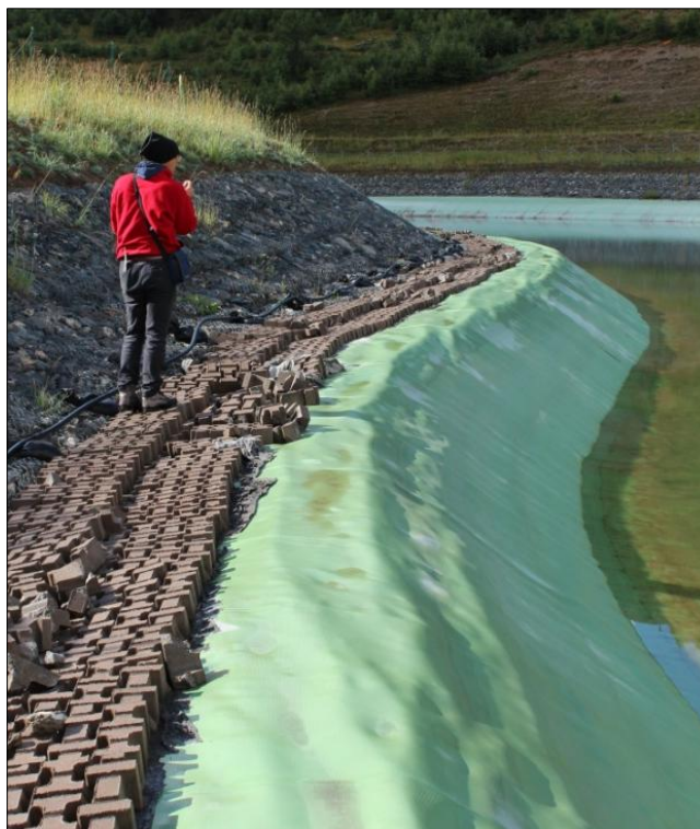
Figure 15 – Irrégularité de la structure support sous la géomembrane laissant supposer des instabilités superficielles locales
