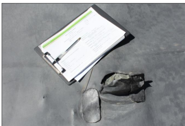
Figure 16 – Poinçonnement (pointé par une flèche) et perforation de la géomembrane par un bloc anguleux de taille importante
