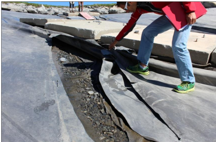
Figure 13 – Rupture des câbles et de la rampe : endommagement de l'ensemble de la rampe et du DEG sous-jacent
