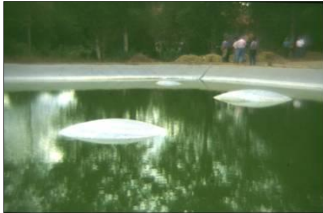
Figure 23 - Drainage des gaz inefficace ayant entraîné la formation de bulles
