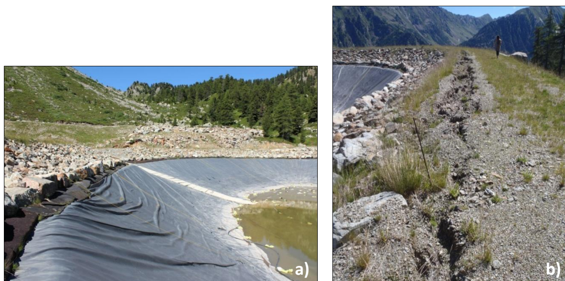
Figure 14 – Glissement du parement amont (a) avec rupture de la clé d'ancrage (b)
