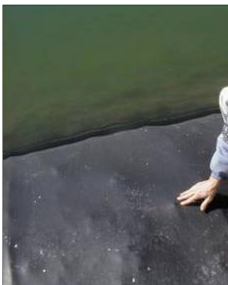
Figure 22 - Exemple de support trop agressif
