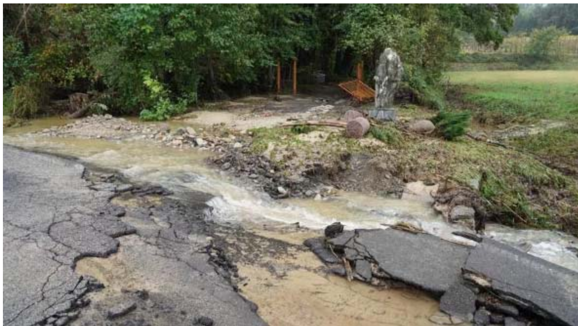
San Cristoforo, la strada per Gavi danneggiata da frane e smottamenti (fonte Stampa web)
