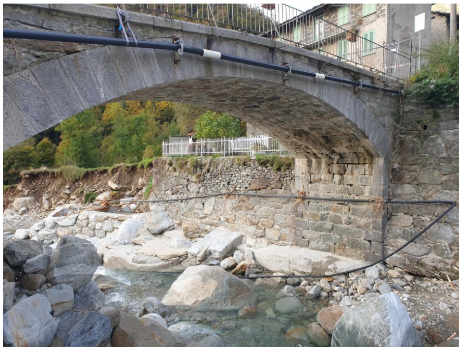
Foto 14 (9 ottobre 2020) Ponte di via Roma ed erosione in sponda destra a valle del muro (prima dei lavori di somma urgenza)
