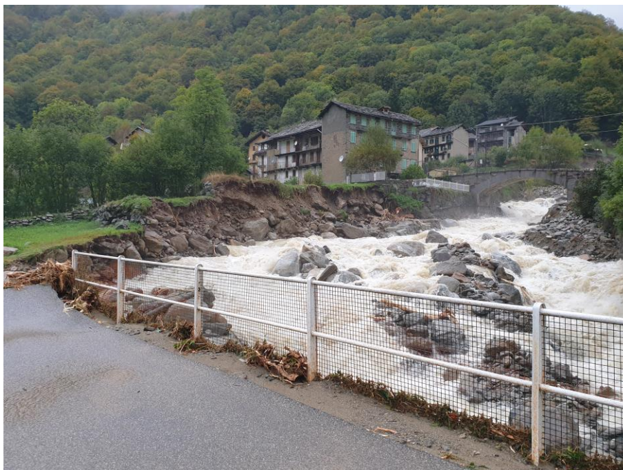
Foto 6 (mattina del 3 ottobre 2020) L'ampia erosione della sponda destra da cui l'acqua ha raggiunto e danneggiato la strada provinciale e la pavimentazione del ponte.
