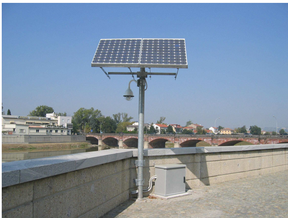
Figura 7 – impianto di videopostazione fluviale
