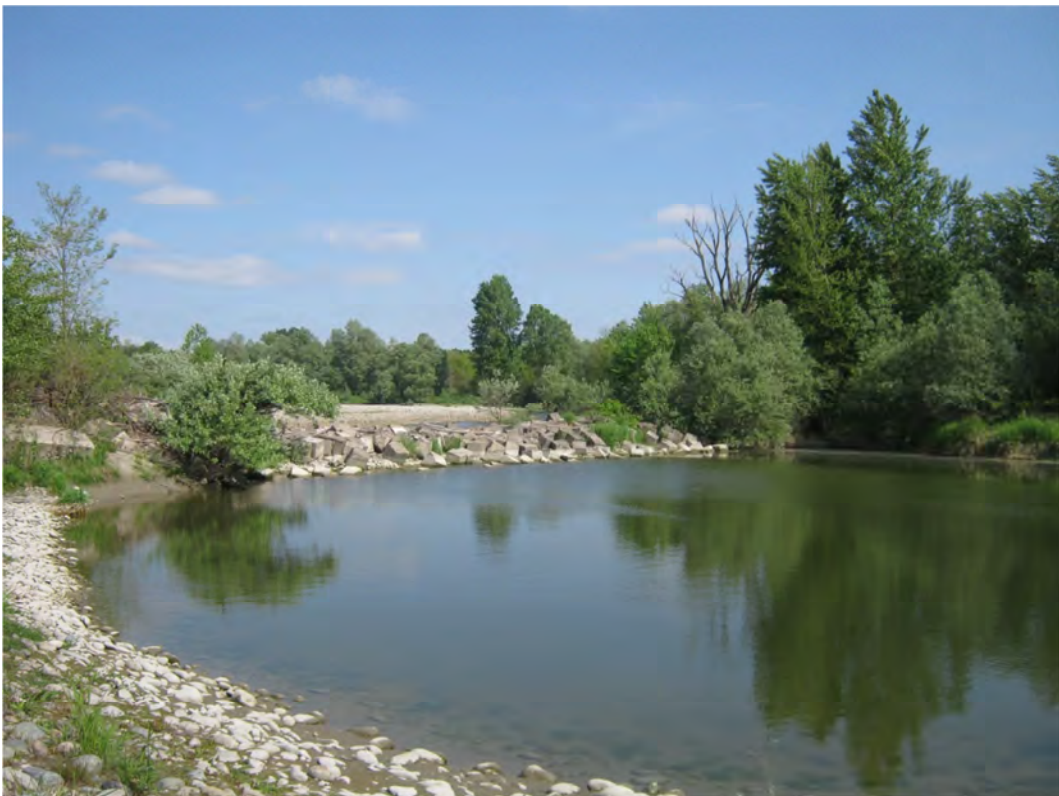
FOTO 14 – Vista da valle verso monte opera in prismi di calcestruzzo all’imbocco dei canali
