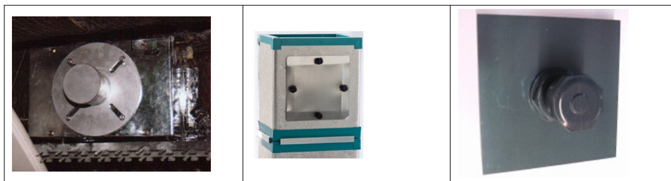
Figura 8. Sportelli e punti di ispezione lungo le canalizzazioni
